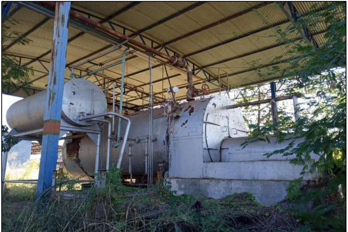
ITEM 021 - CALDEIRA DA MARCA EÔNIA, À LENHA, CAPACIDADE PARA 8.000 KG DE VAPOR/HORA .
