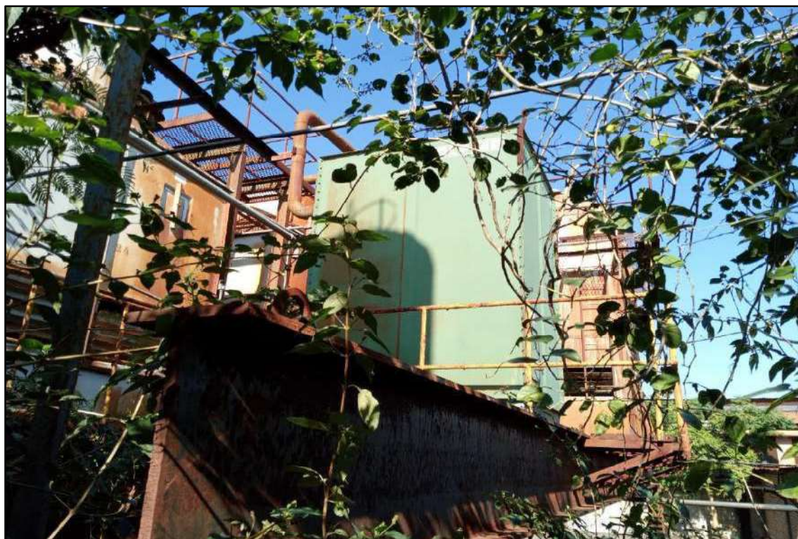
ITEM 026 - TORRE DE RESFRIAMENTO, MARCA ALPINA, CAPACIDADE PARA 60M 3 /HORA.
