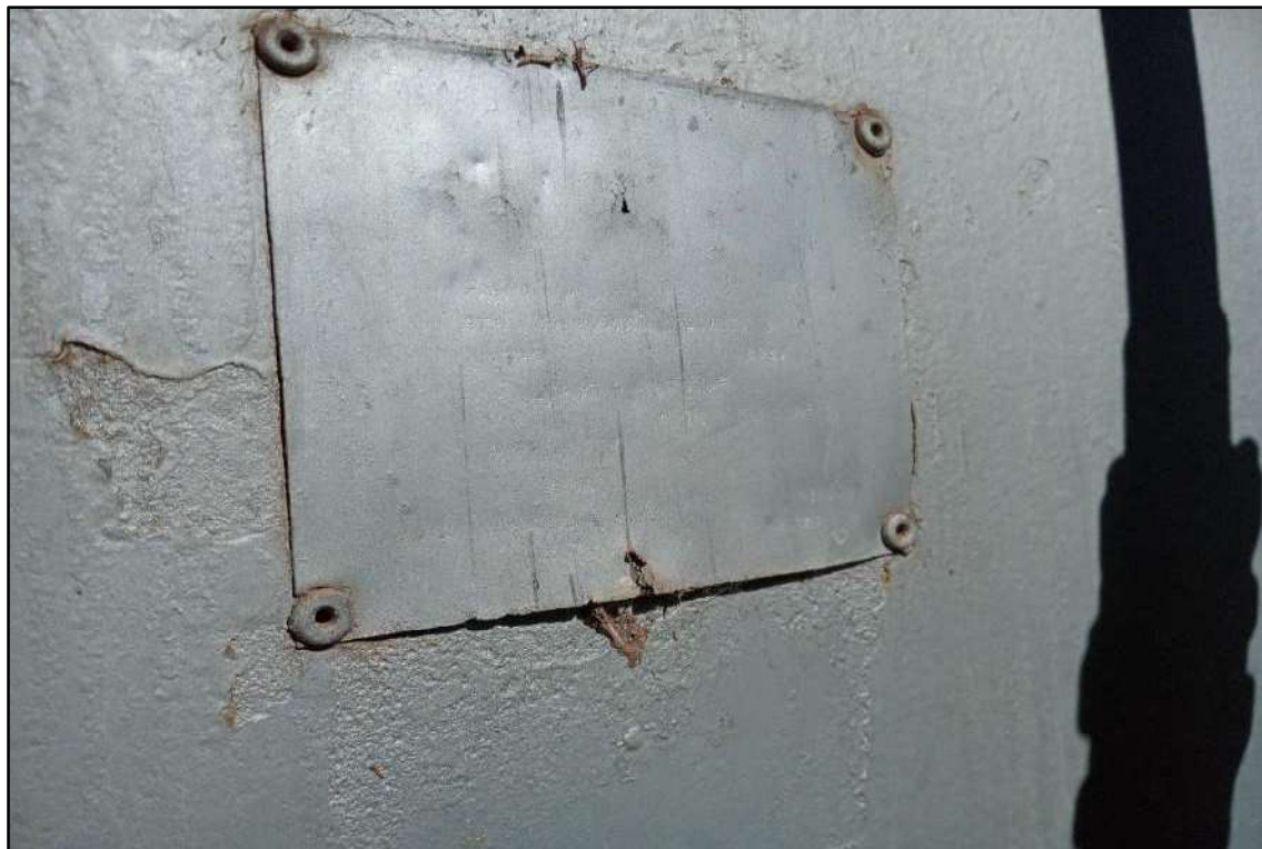
ITEM 020 - CALDEIRA DA MARCA ATA 30, MODELO H3, TRANSFORMADA A LENHA, CAPACIDADE PARA 10.000 KG DE VAPOR/HORA.
