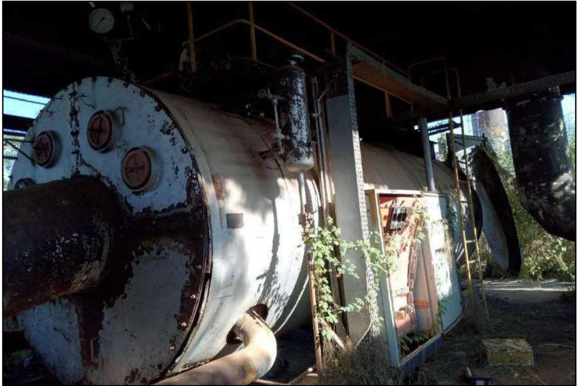
ITEM 020 - CALDEIRA DA MARCA ATA 30, MODELO H3, TRANSFORMADA A LENHA, CAPACIDADE PARA 10.000 KG DE VAPOR/HORA.
