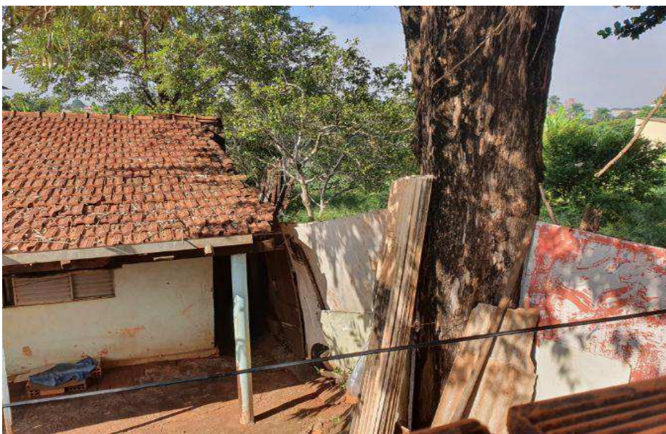
Imagem 6 – vista da construção do imóvel, péssimo estado de conservação
