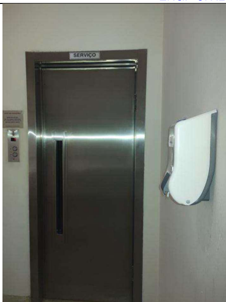
Foto 09 – elevador de serviço
