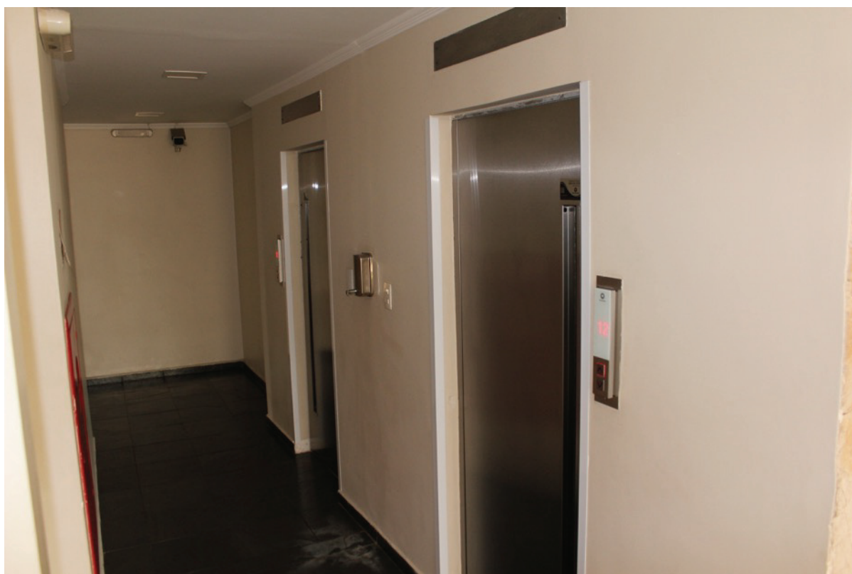
Condomínio Edifício Base das Canoas – Elevadores
