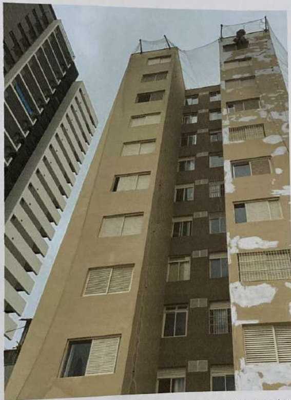
Foto nº. 8 – Vista da fachada posterior que por ocasião da vistoria estava em reforma.
