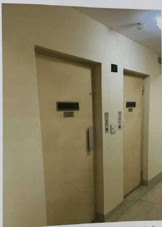
Foto nº. 11 – Vista dos elevadores localizados no pavimento tipo.
