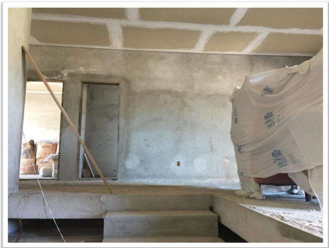
FOTO 18: PAREDES SEM REVESTIMENTO FINAL COM PINTURA E FORRO INACABADO
