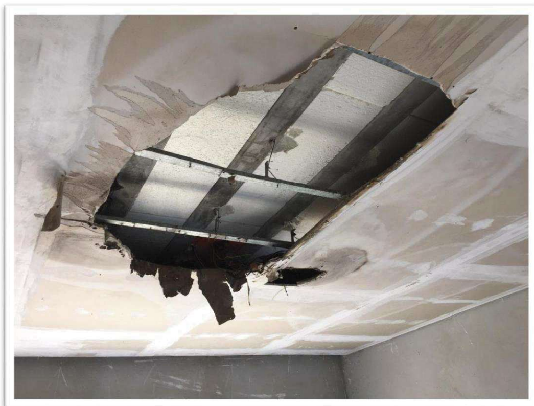
FOTO 16: FORRO DETERIORADO NO PISO SUPERIOR POR INFILTRAÇÕES
