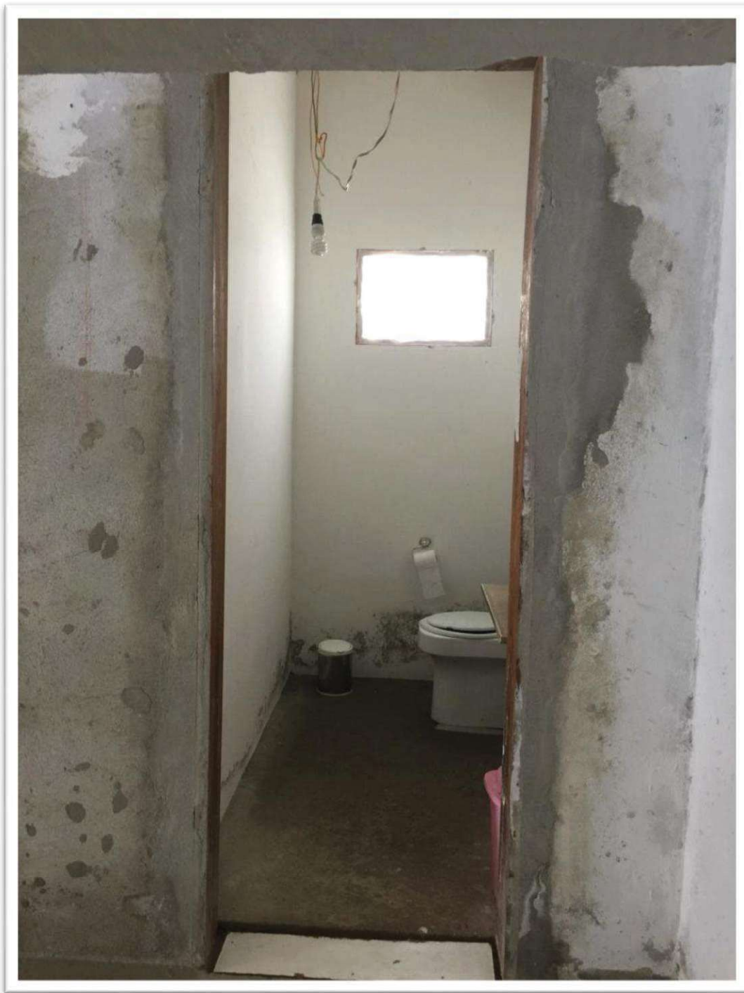
FOTO 07: BANHEIRO - PISO TÉRREO
