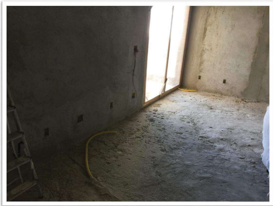
FOTO 17: INSTALAÇÕES ELÉTRICAS INCOMPLETAS
