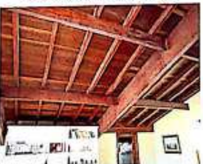
Vista do teto e parede da sala do piso superior
