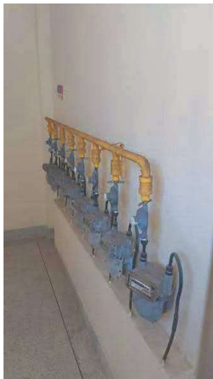
Imagem 10 Rede de gás do condomínio.
