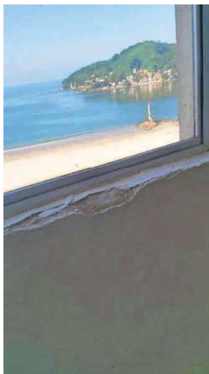
Imagem 18 Parede da sala com infiltração.
