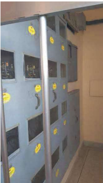
Imagem 11 Quadro de medidor de energia do condomínio.
