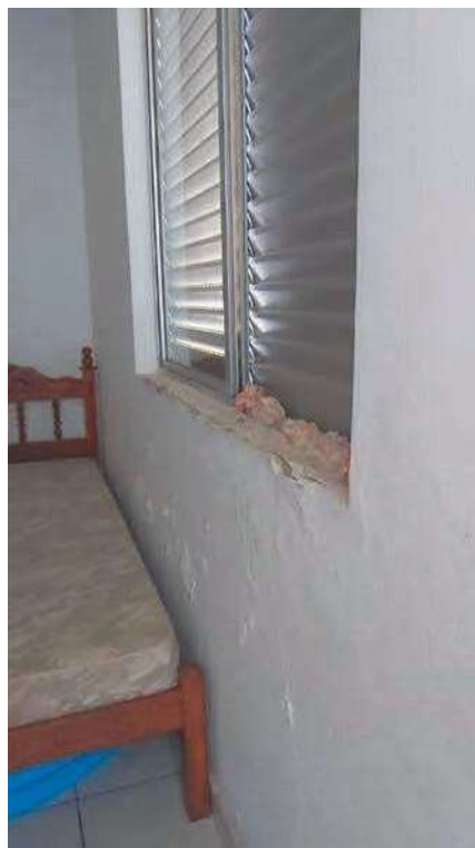
Imagem 24 Parede do quarto com infiltração.
