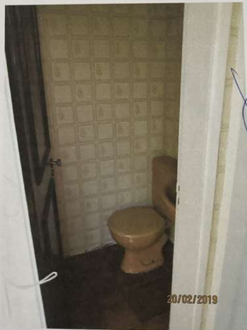
Foto 45) Vista do banheiro de serviço. Observar acabamento de piso e paredes e peças sanitárias.
