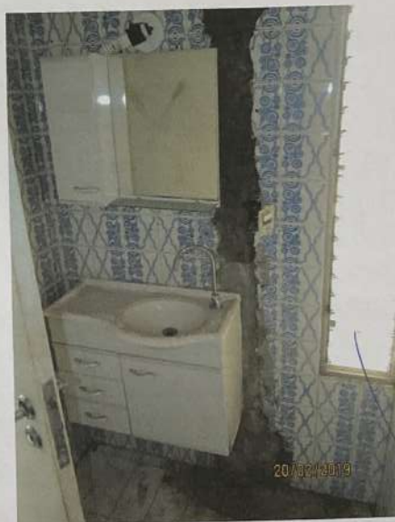
Foto 22) Vista do interior do banheiro. Observar parede com revestimento danificado devido a troca da prumada.
