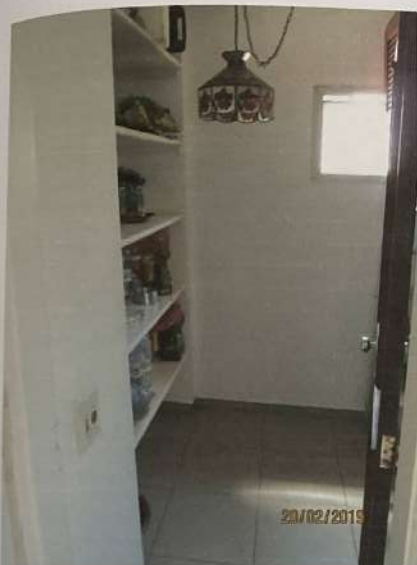
Foto 46) Vista da dependência de serviço. Observar acabamento de piso e paredes e caixilho tipo "maxim-ar" em alumínio anodizado natural.
