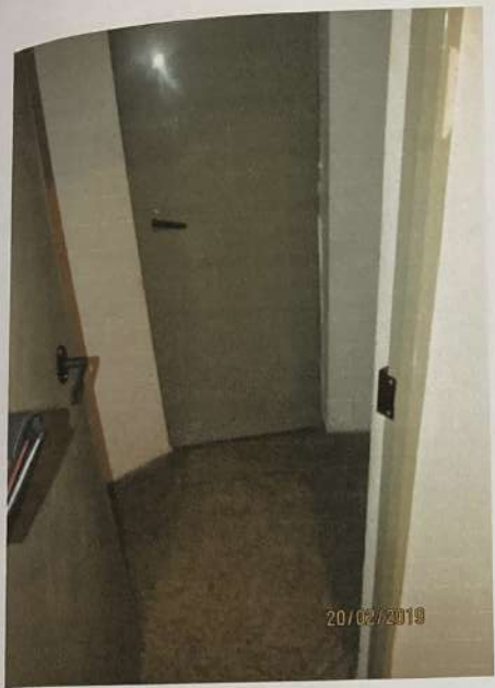
Foto 42) Vista da antecâmara da escada de uso comum. Observar portas corta-fogo.
