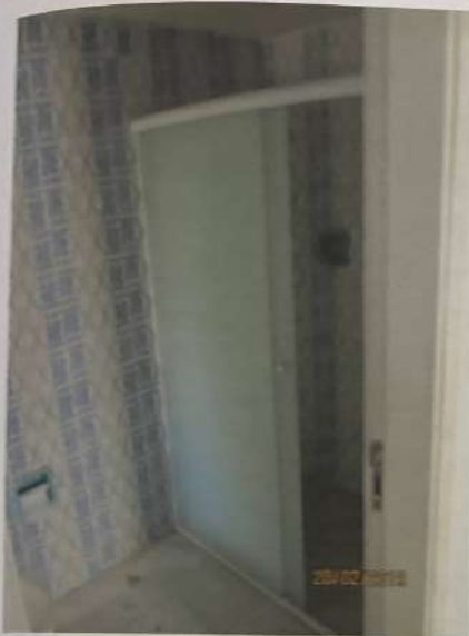
Foto 23) Outra vista do banheiro, agora visando a área de banho. Observa-se acabamento de piso, paredes e teto e fechamento da área de banho em vidro e alumínio.
