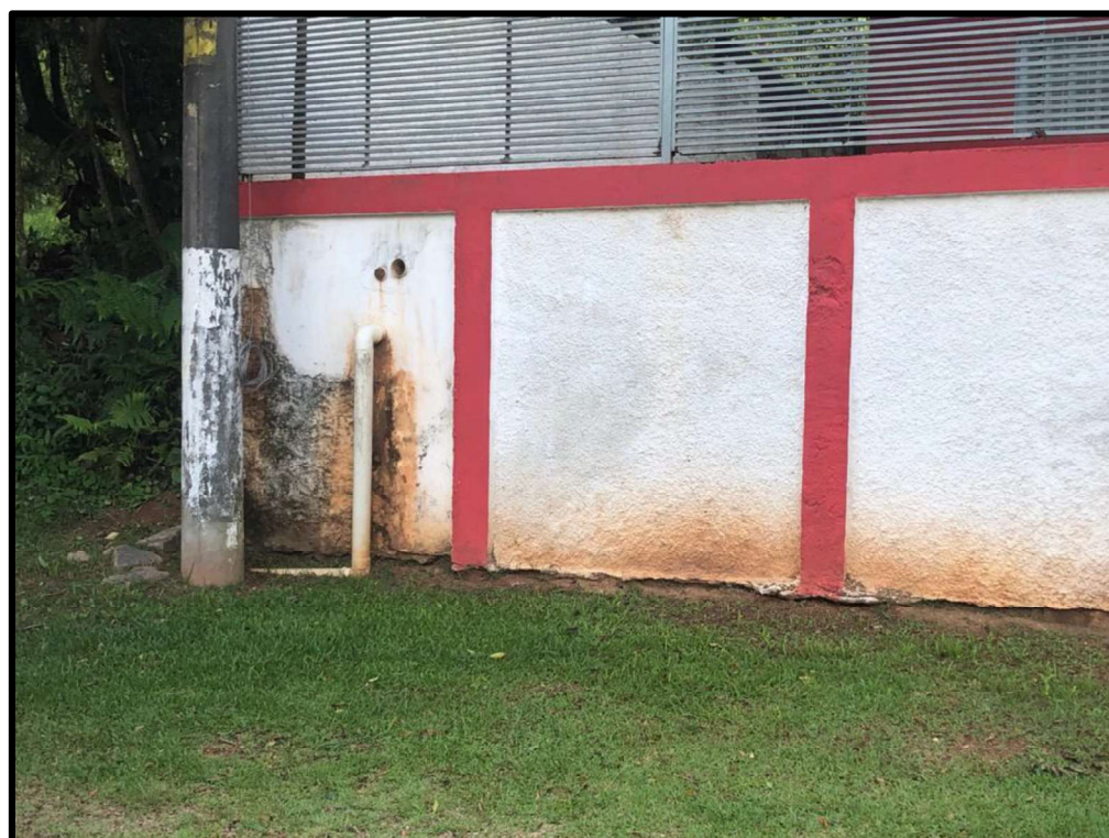
Foto 4: Vista do muro de divisa - vazamento
