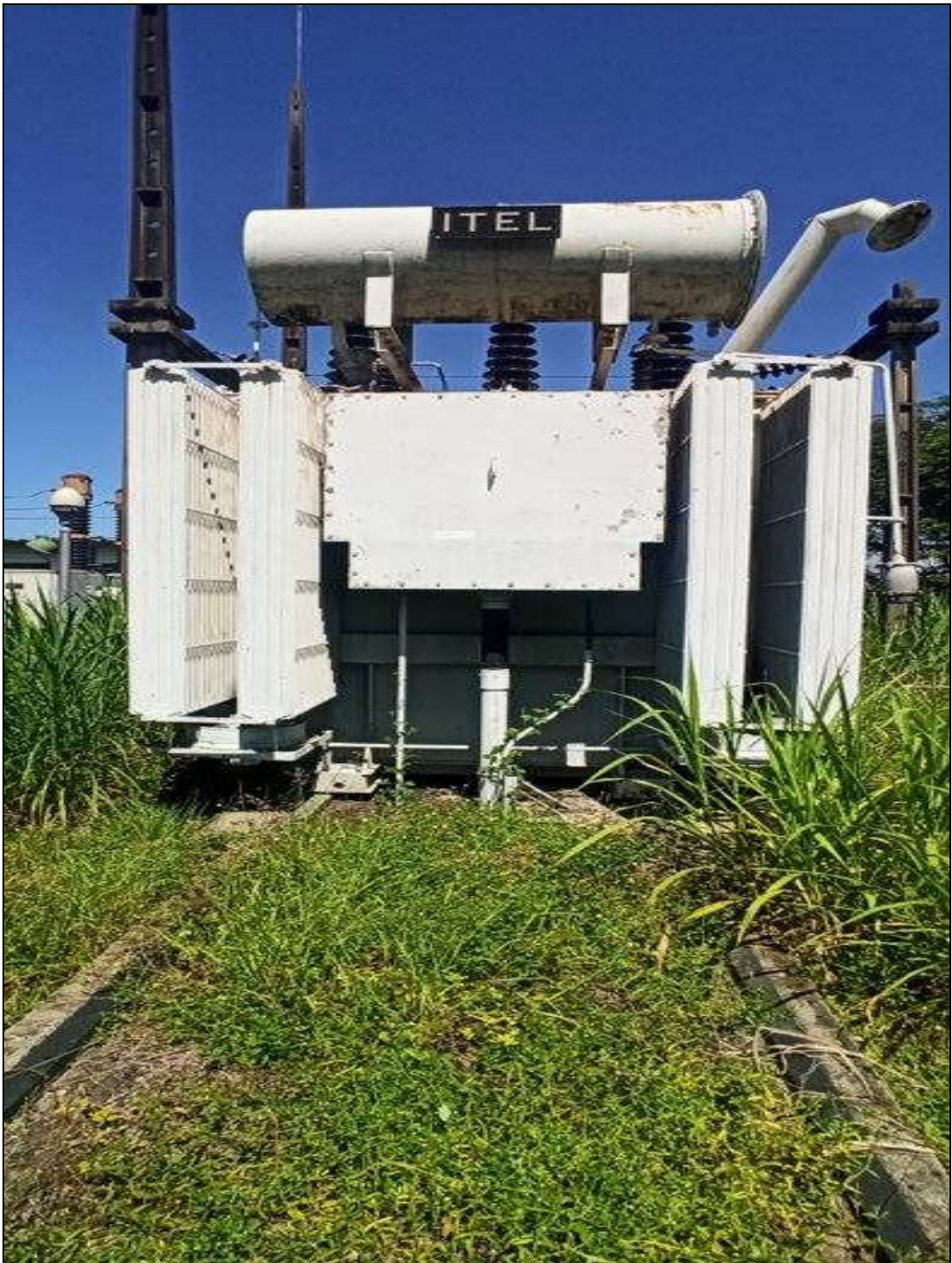
ITEM 1,017 – VISTA DO TRANSFORMADOR TRIFASICO A OLEO, FAB. ITEL, MOD. PTOE, 7,5 MVA 69 KV / 13 ,8 KV
