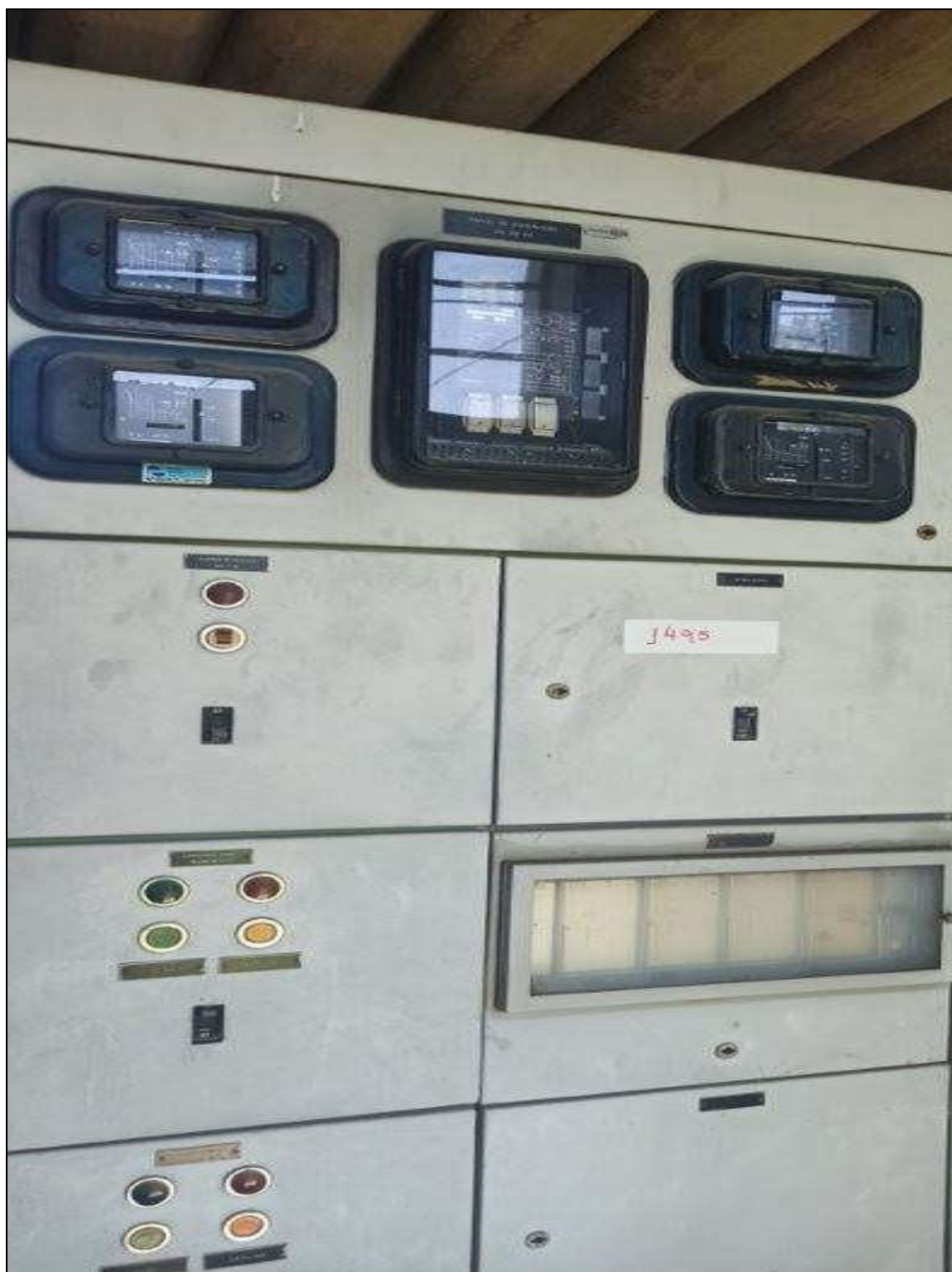
ITEM 1,051 – VISTA DO PAINEL DE MEDICAO E CONTROLE DUPLA FACE, 69 KV, 01 MODULO, DIM. 2500X1700X2300 MM
