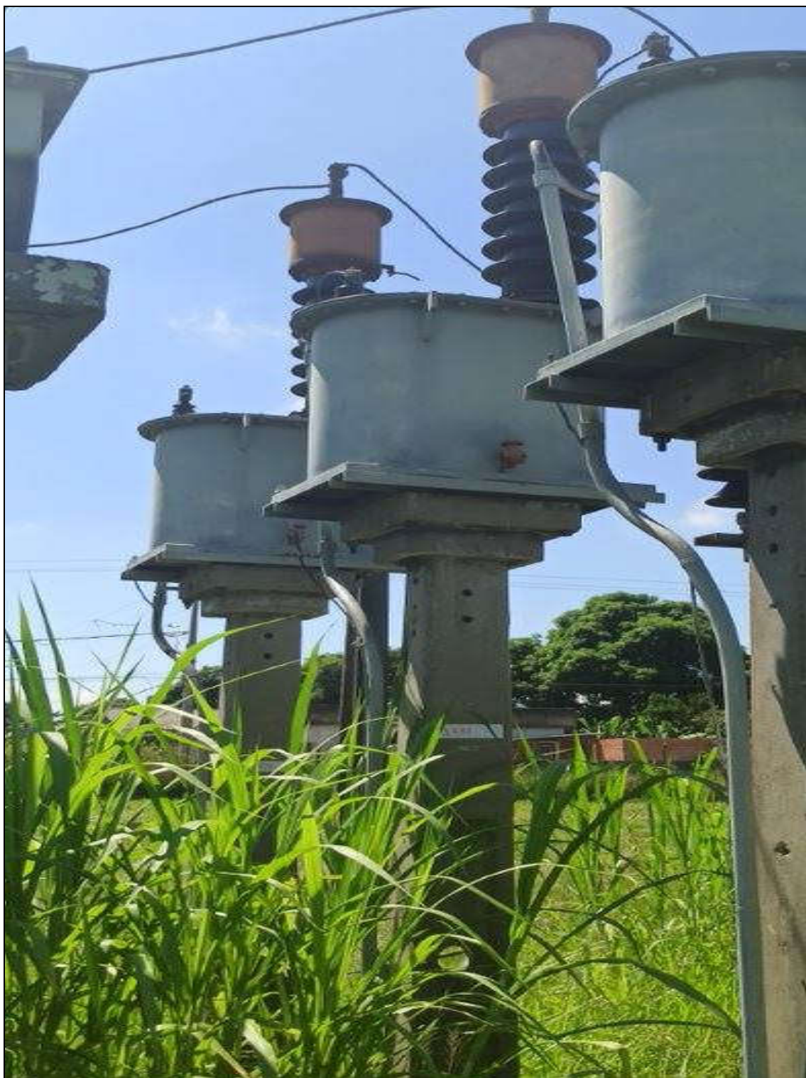
ITEM 1,024 – VISTA DO TRANSFORMADOR DE CORRENTE, FAB. SIEMENS, MOD. ATOF69, TENSAO 69 KV
