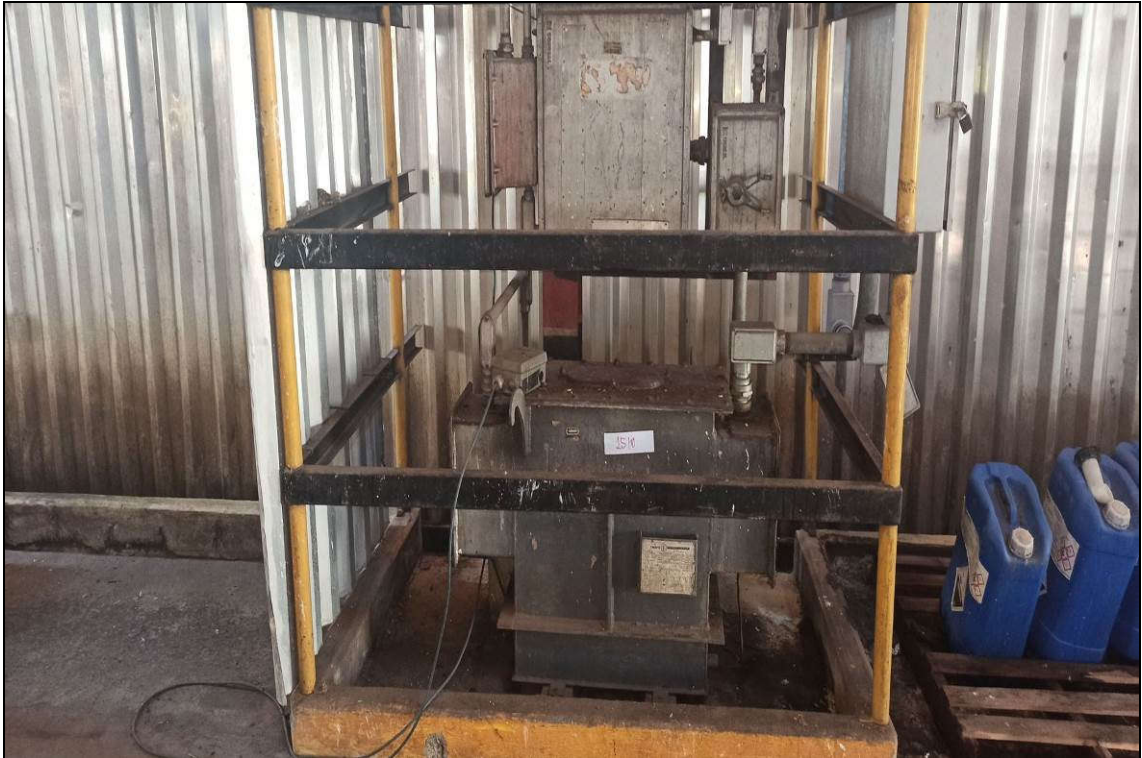
ITEM 1,036 – VISTA DO TRANSFORMADOR A SECO, FAB. TRAF0, MOD. TTM30/1,2, 30 KVA, 440-220 V
