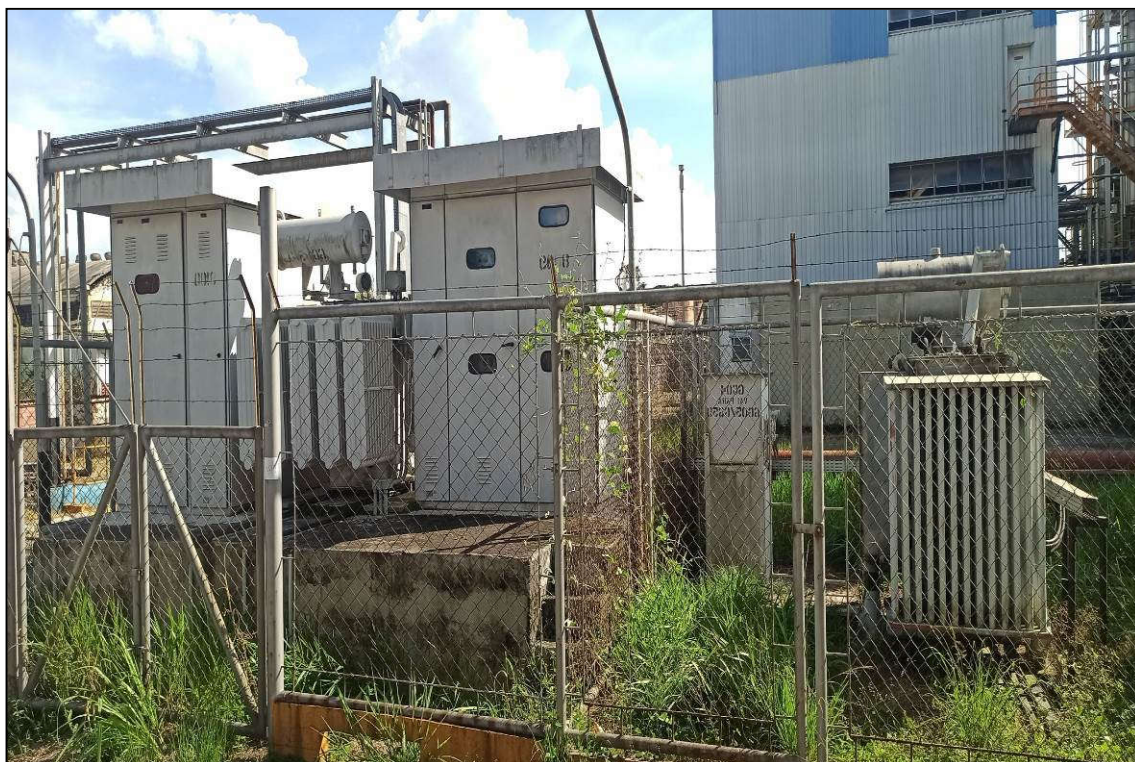
ITEM 1,003 – VISTA DA SUBESTACAO ELETRICA, FAB. ABB, 13,8 KV / 440 V COMPOSTA POR TRANSFORMADOR TRIFASICO A OLEO FAB. TRAFOT. 1,0 MVA TENSÃO ENTR/SAIDA 13,8 KV/460 V, TRANSFORMADOR TRIFASICO A OLEO FAB. TRAFOT. 750 KVA TENSÃO ENTR/SAIDA 13,8 KV/460 V, PAINEL SECCIONADOR
