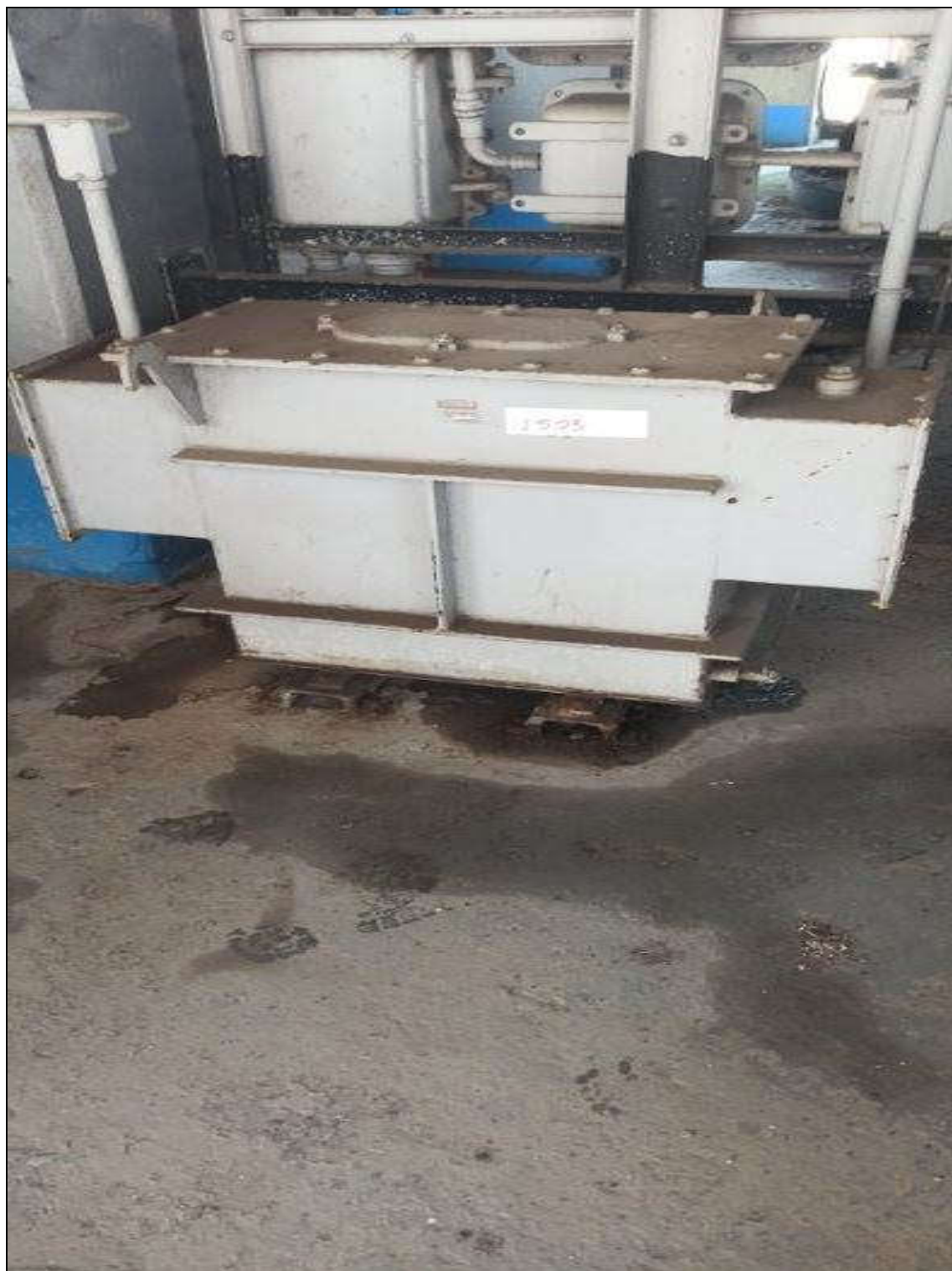
ITEM 1,033 – VISTA DO TRANSFORMADOR TRIFASICO A SECO, FAB. TRAFO, MOD. TTM30/1.2, 30 KVA, 480 - 220 V
