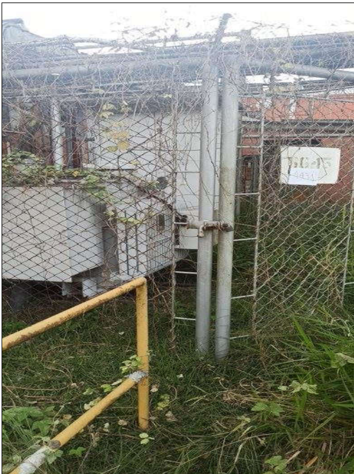
ITEM 1,012 – VISTA DO TRANSFORMADOR DE POTÊNCIA, FAB. SIEMENS, 300 KVA, 13200-220/127 V
