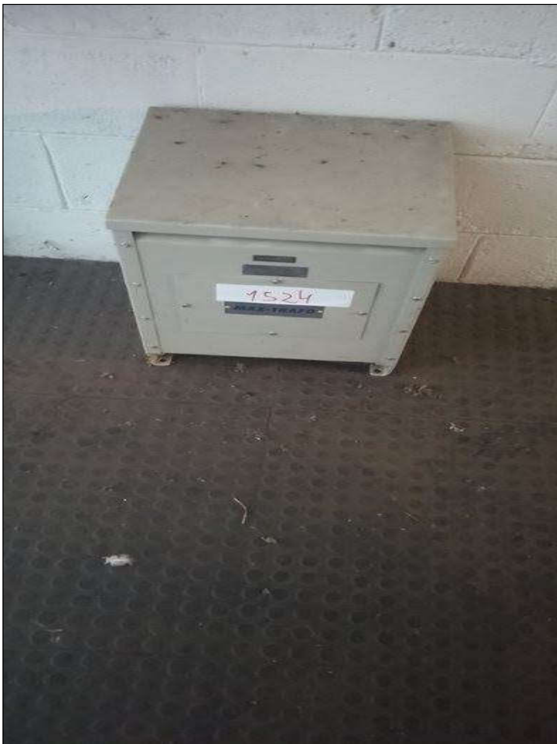
ITEM 1,044 – VISTA DO TRANSFORMADOR, FAB. MAXTRAFO, 5 KVA, 220/440 V
