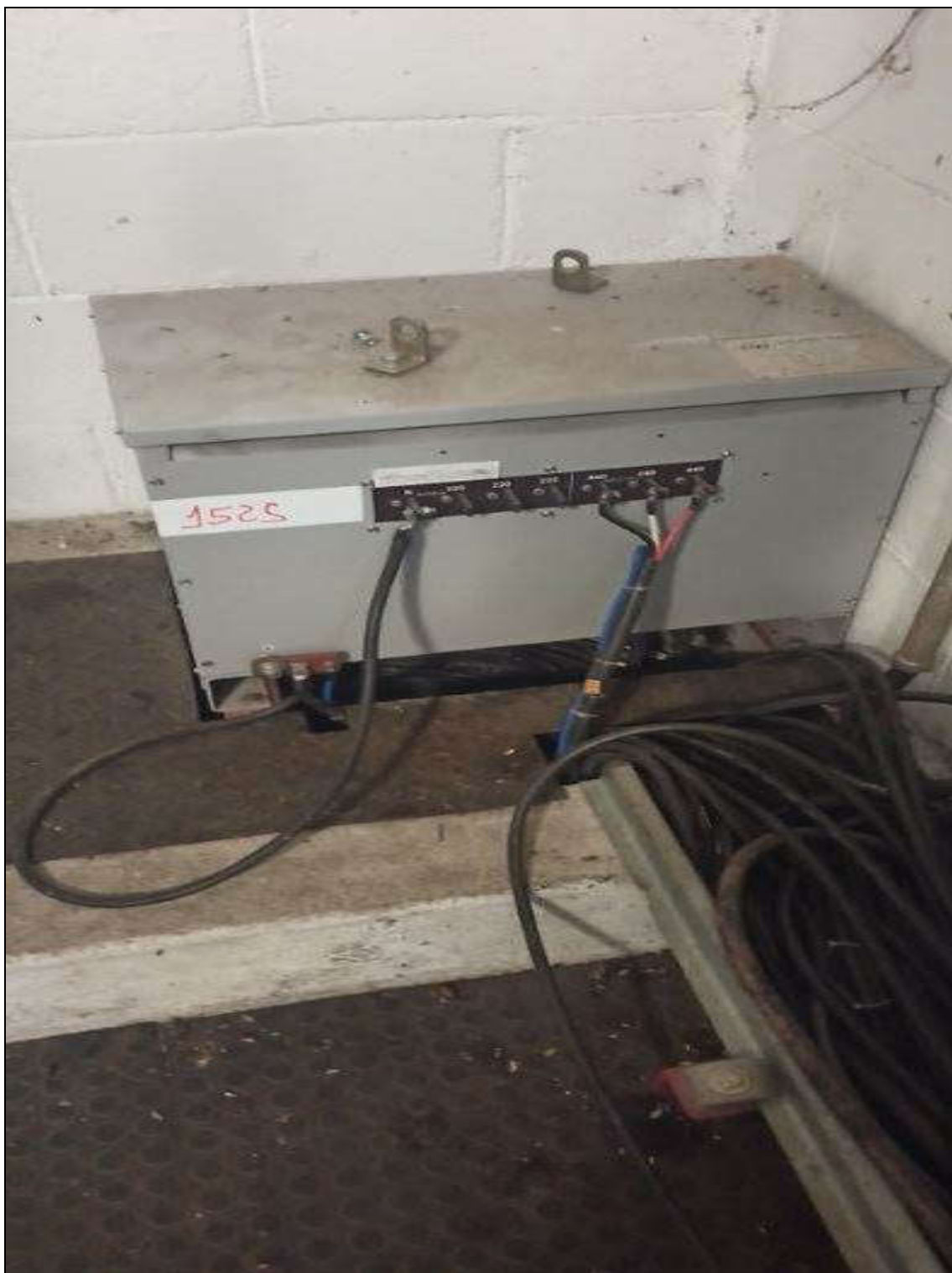
ITEM 1,045 – VISTA DO TRANSFORMADOR A SECO, FAB. SOLANO TRANSKAV, 30 KVA
