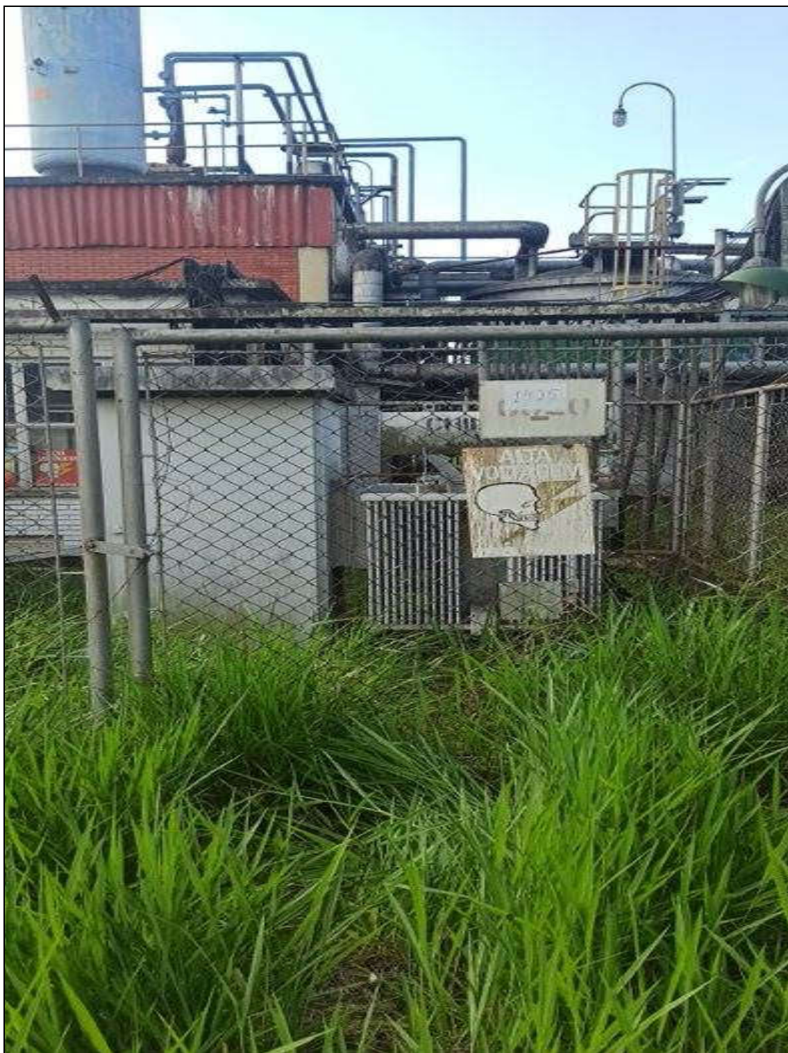
ITEM 1,007 – VISTA DO TRANSFORMADOR TRIFASICO A OLEO, FAB. TRAFO, MOD. TTOFSU 500/15/12, 500 KVA 13,8 KV / 220 V
