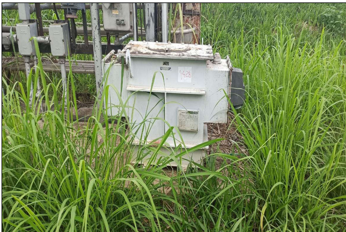
ITEM 1,009 – VISTA DO TRANSFORMADOR TRIFASICO A SECO, FAB. TRAF0, MOD. TTM30/1.2, 30 KVA, 480 - 220 V
