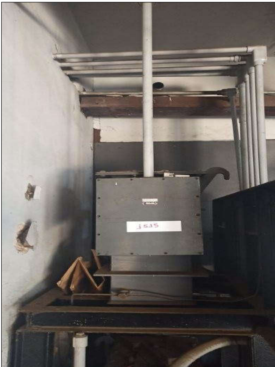
ITEM 1,038 – VISTA DO TRANSFORMADOR DE TENSÃO, TENSÃO ENTRADA 480 V, TENSÃO SAÍDA 220 V, POT. 15 KVA
