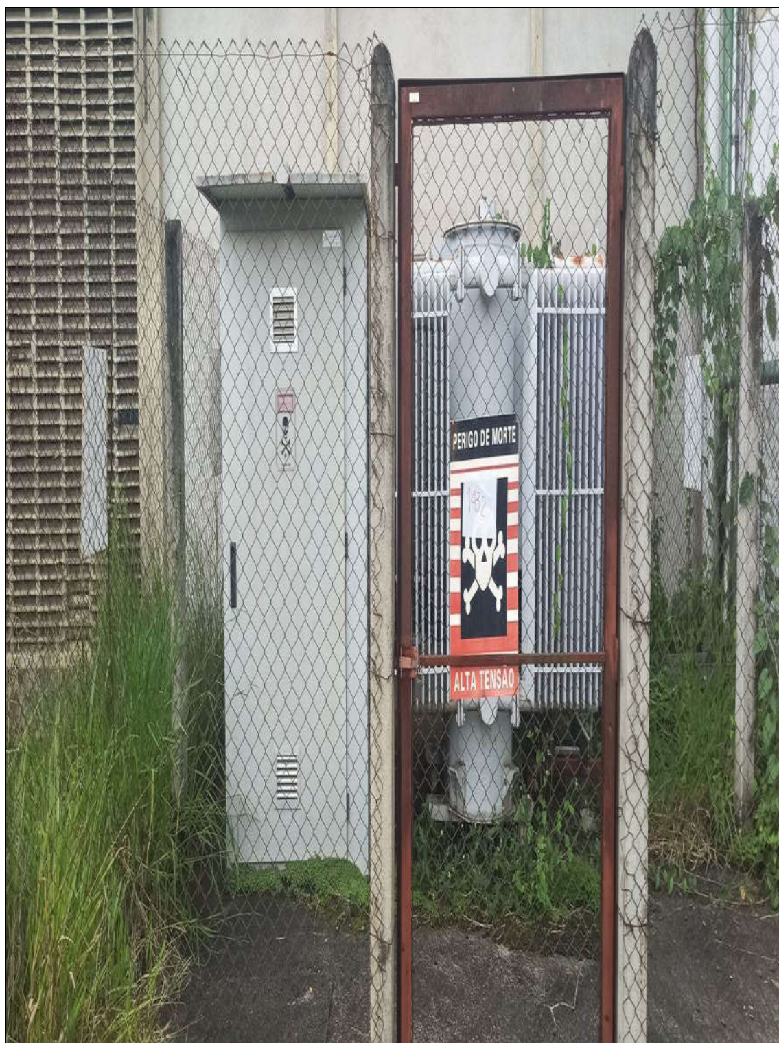
ITEM 1,013 – VISTA DO TRANSFORMADOR DE POTÊNCIA, FAB. UNIAO, MOD. IM-3, 1500 KVA, 13800 - 440 / 254 V
