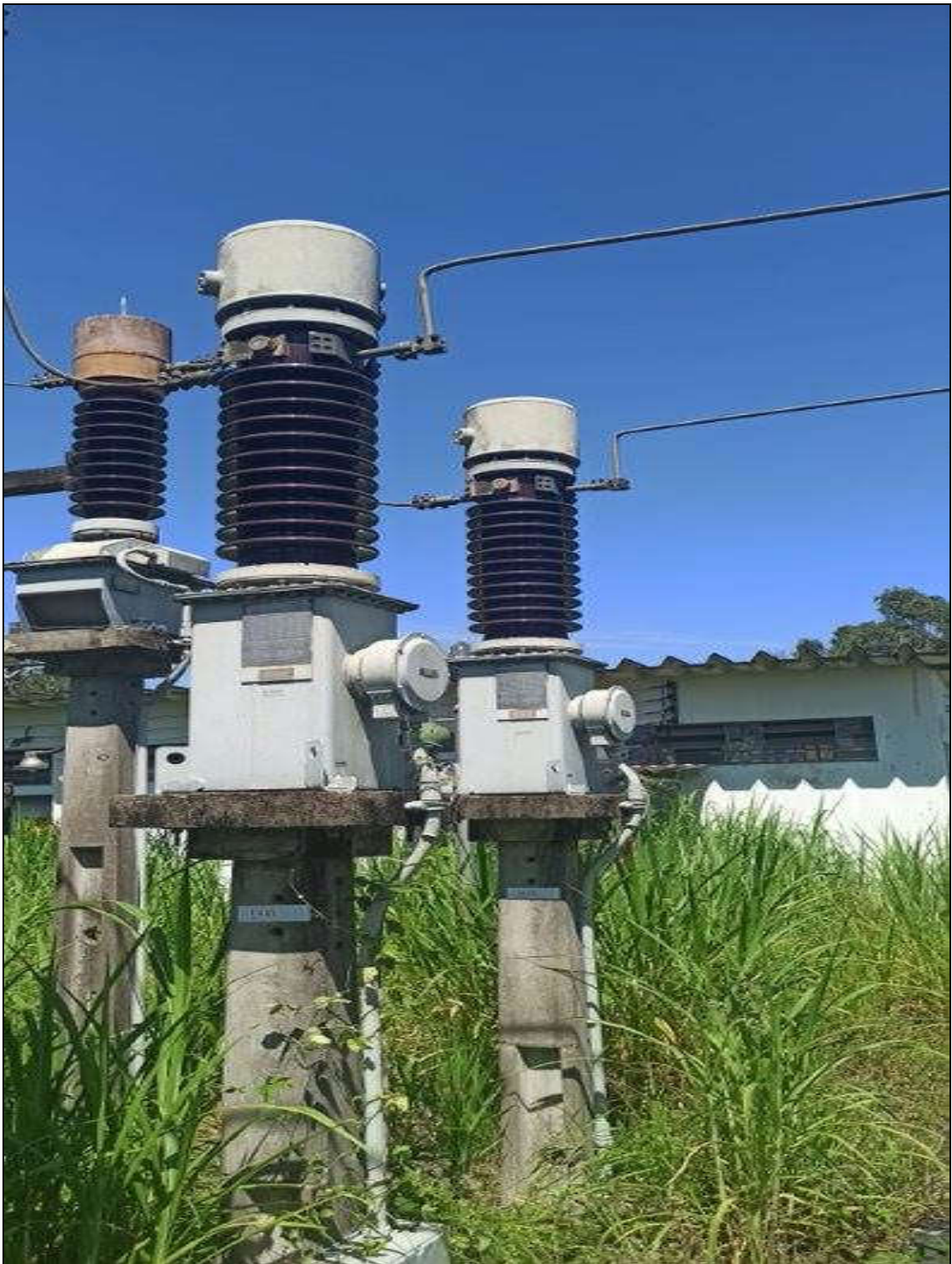
ITEM 1,019 – VISTA DO TRANSFORMADOR DE POTÊNCIA, FAB. HITACHI, MOD. QD68-69, 69 KV
