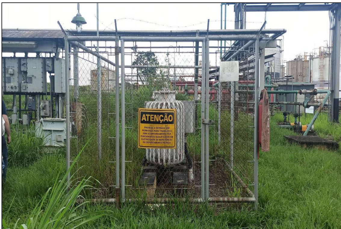
ITEM 1,008 – VISTA DO TRANSFORMADOR TRIFASICO A OLEO, FAB. TRAF0, MOD. TTOC 225/5, 225 KVA, 2.4 KV - 480 V
