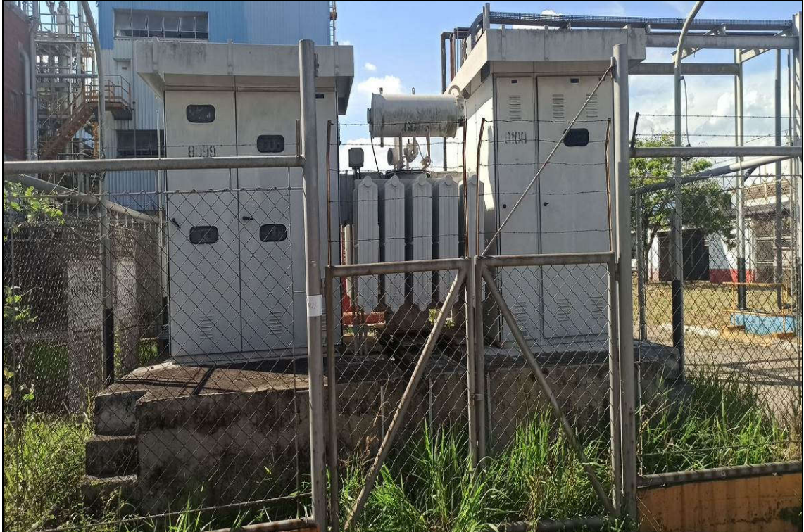
ITEM 1,003 – VISTA DA SUBESTACAO ELETRICA, FAB. ABB, 13,8 KV / 440 V COMPOSTA POR TRANSFORMADOR TRIFASICO A OLEO FAB. TRAFOT. 1,0 MVA TENSÃO ENTR/SAIDA 13,8 KV/460 V, TRANSFORMADOR TRIFASICO A OLEO FAB. TRAFOT. 750 KVA TENSÃO ENTR/SAIDA 13,8 KV/460 V, PAINEL SECCIONADOR
