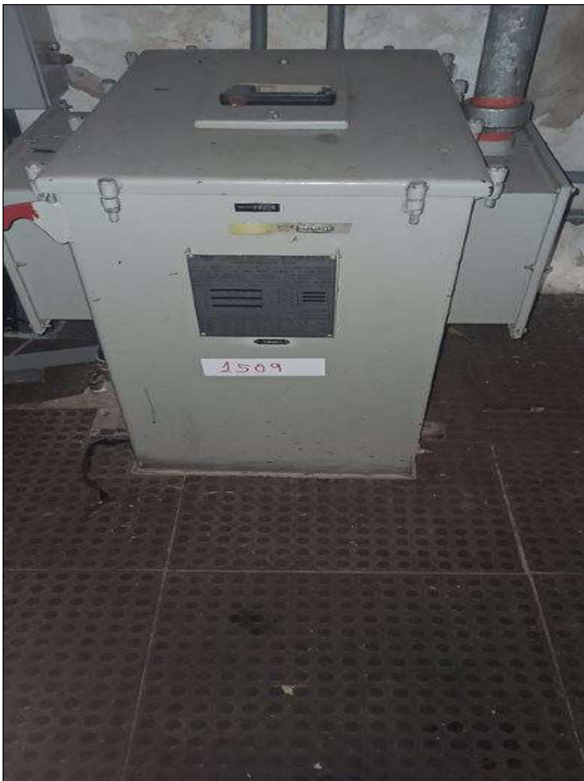
ITEM 1,035 – VISTA DO TRANSFORMADOR TRIFASICO A SECO, FAB. ZILMER, MOD. TC1, 45 KVA, 220 / 127 V
