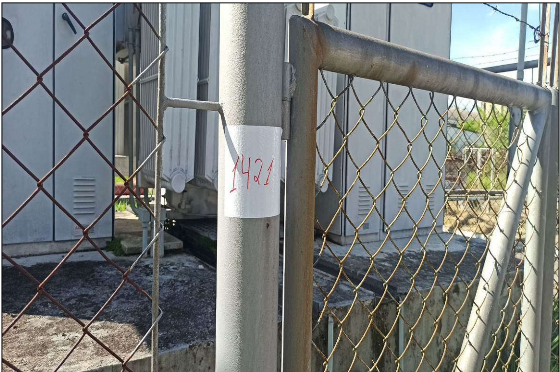
ITEM 1,003 – VISTA DA SUBESTACAO ELETRICA, FAB. ABB, 13,8 KV / 440 V COMPOSTA POR TRANSFORMADOR TRIFASICO A OLEO FAB. TRAFOT. 1,0 MVA TENSÃO ENTR/SAIDA 13,8 KV/460 V, TRANSFORMADOR TRIFASICO A OLEO FAB. TRAFOT. 750 KVA TENSÃO ENTR/SAIDA 13,8 KV/460 V, PAINEL SECCIONADOR
