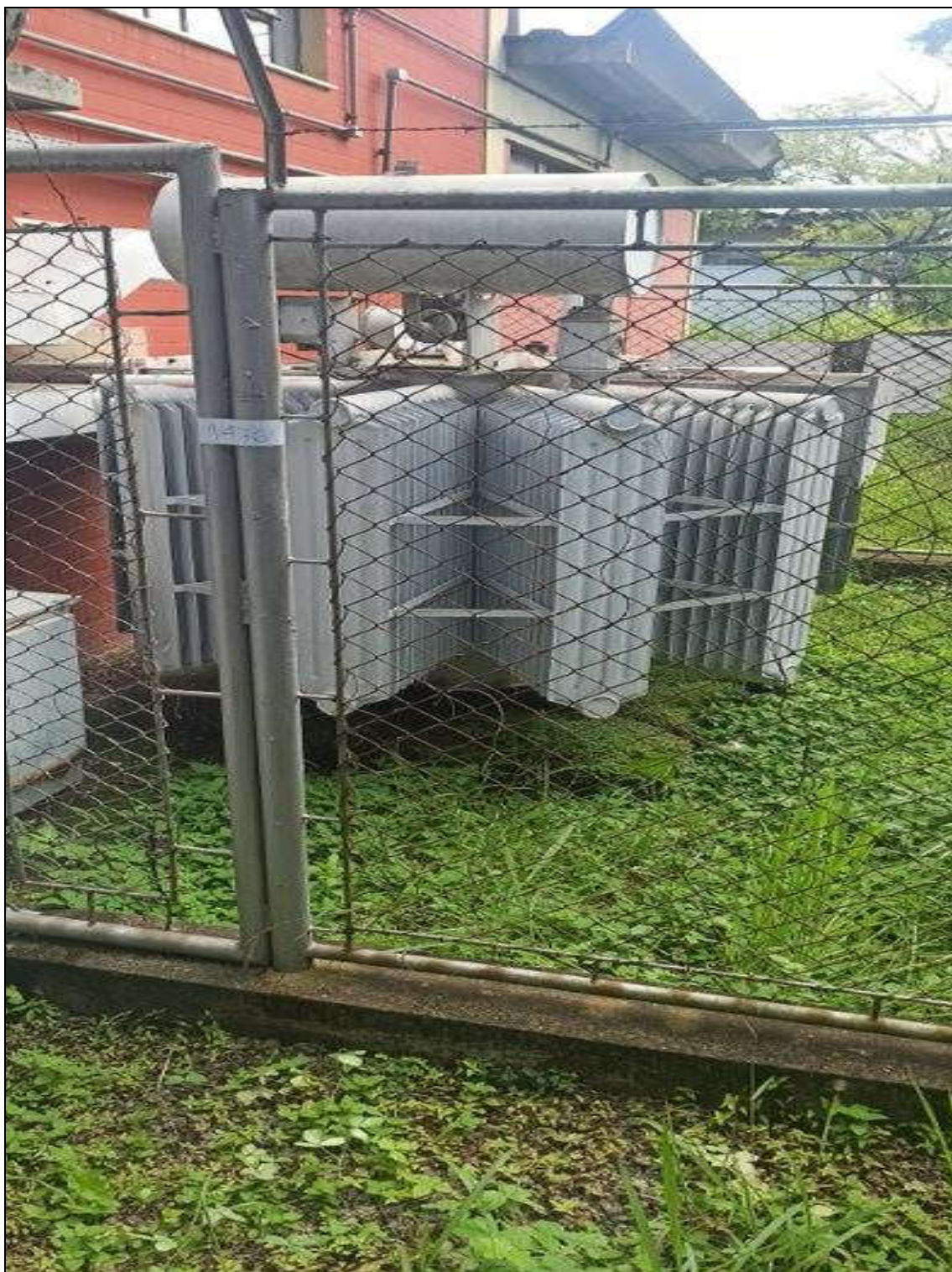
ITEM 1,016 – VISTA DO TRANSFORMADOR TRIFASICO A SECO, FAB. PONSANESI, MOD. ATT, 15 KVA, TENSAO ENTRADA/SAIDA 440 V / 220 V
