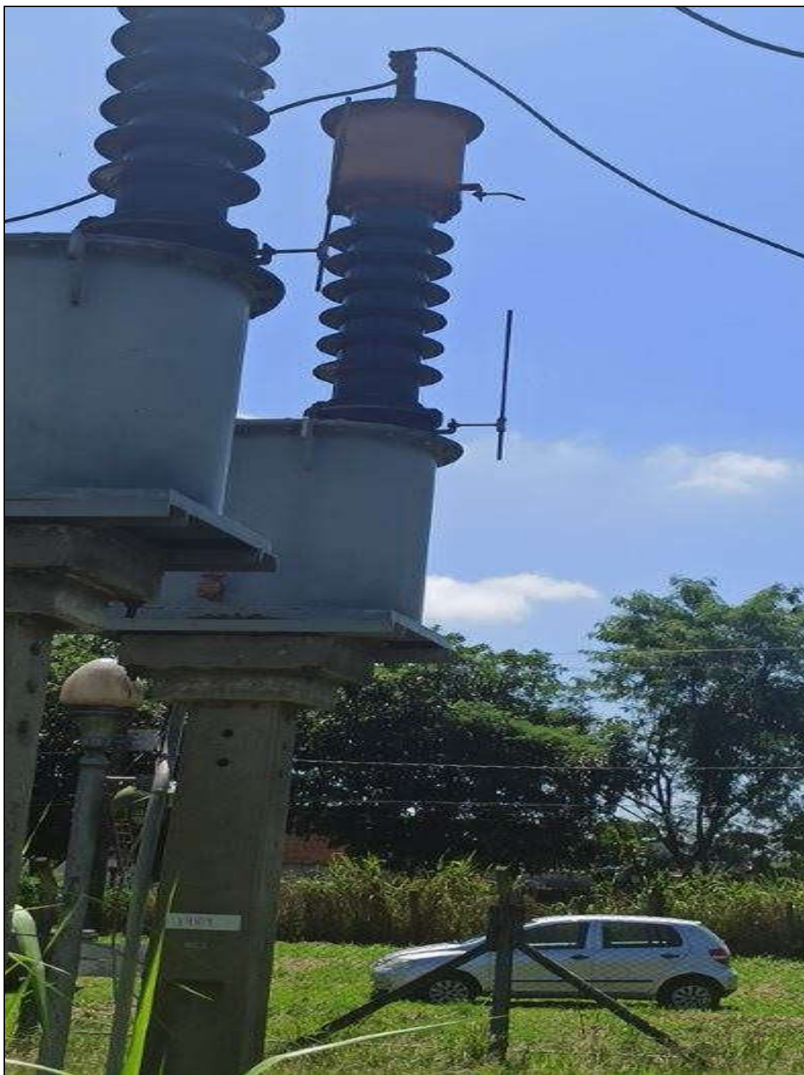
ITEM 1,025 – VISTA DO TRANSFORMADOR DE CORRENTE, FAB. ASEA, MOD. IMBD72A, TENSAO 69 KV
