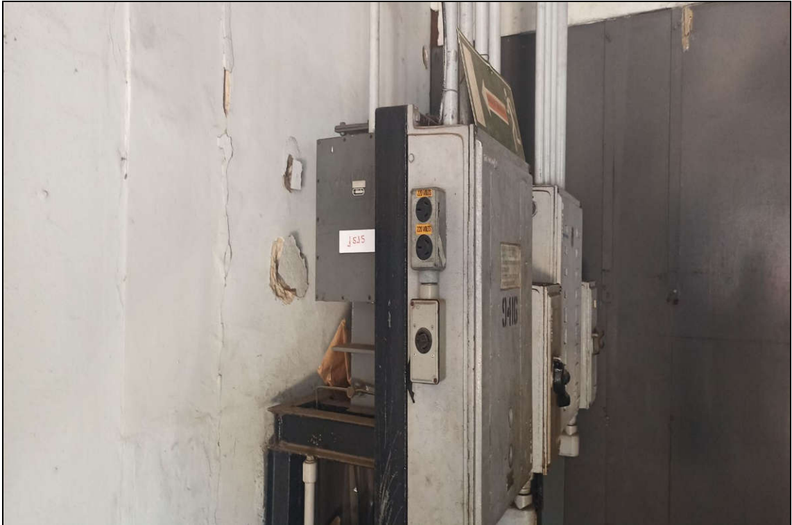
ITEM 1,038 – VISTA DO TRANSFORMADOR DE TENSÃO, TENSÃO ENTRADA 480 V, TENSÃO SAÍDA 220 V, POT. 15 KVA
