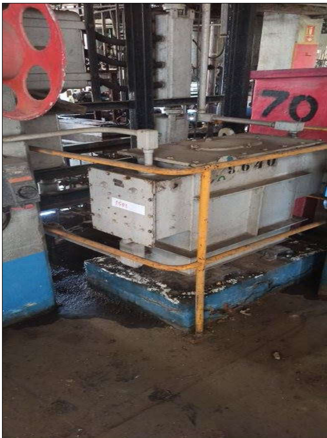
ITEM 1,031 – VISTA DO TRANSFORMADOR TRIFASICO A SECO, FAB. TRAFO, MOD. TTM30/1.2, 30 KVA 480 V PARA 220 V
