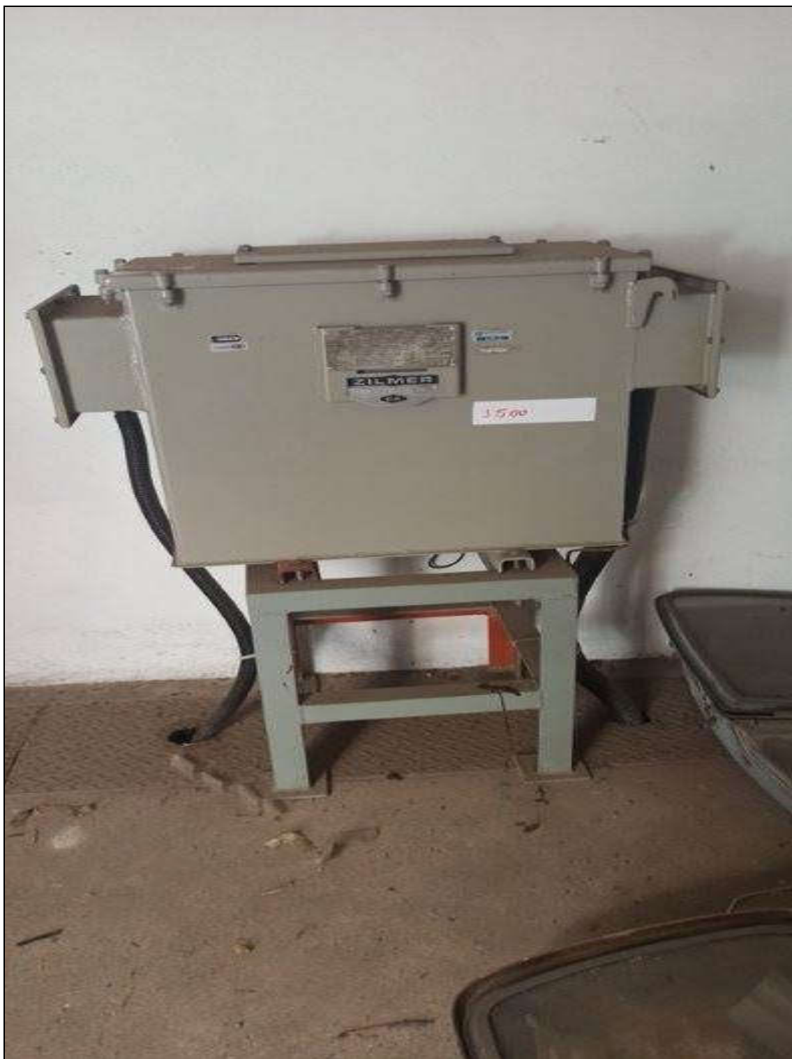
ITEM 1,030 – VISTA DO TRANSFORMADOR TRIFASICO A SECO, FAB. ZILMER, MOD. TC1, 15 KVA, TENSAO ENTR/SAIDA 480 V / 220 V
