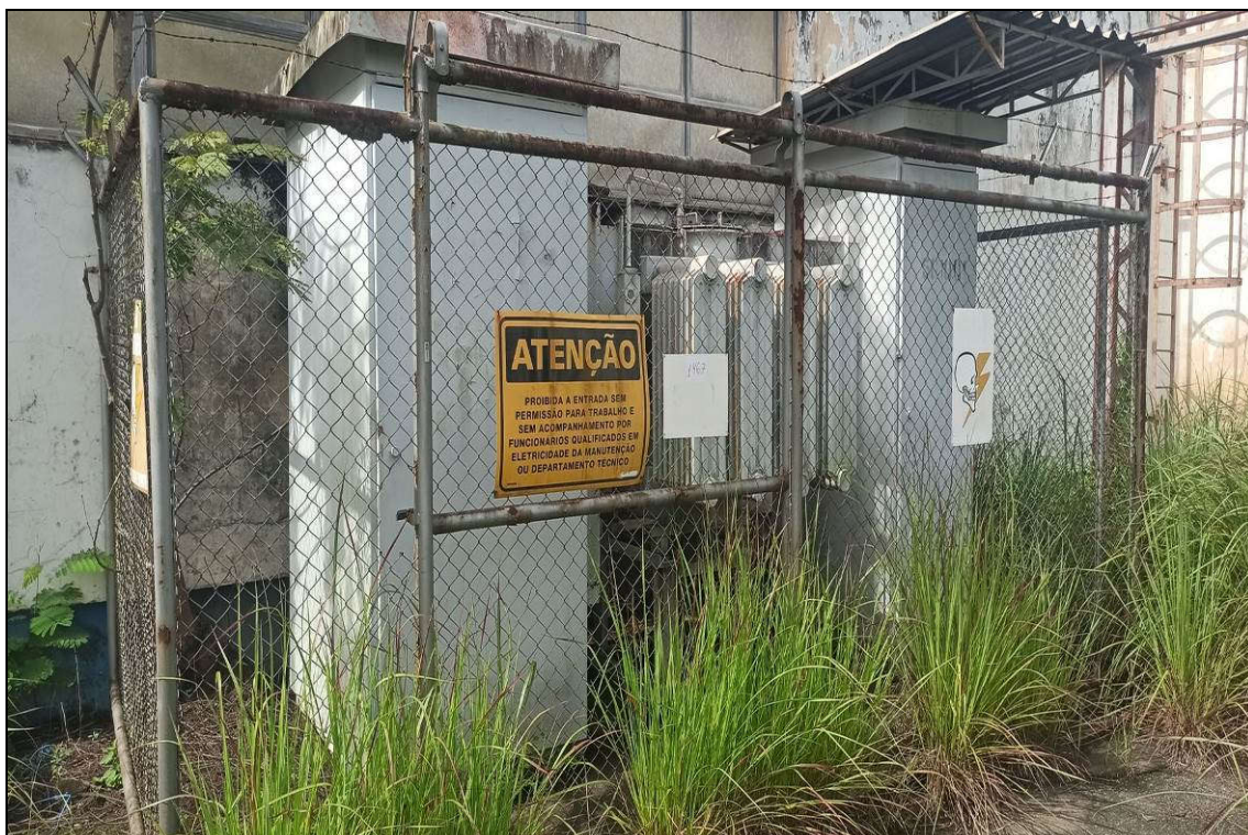
ITEM 1,015 – VISTA DA SUBESTACAO ELETRICA, 13,8 KV / 220 V, COMPOSTA POR TRANSFORMADOR TRIFASICO A OLEO, FAB. DEDINI, TIPO T5 00/136 POT. 500 KVA, PAINEL SECCIONADOR DE ENTRADA 13,8 KV
