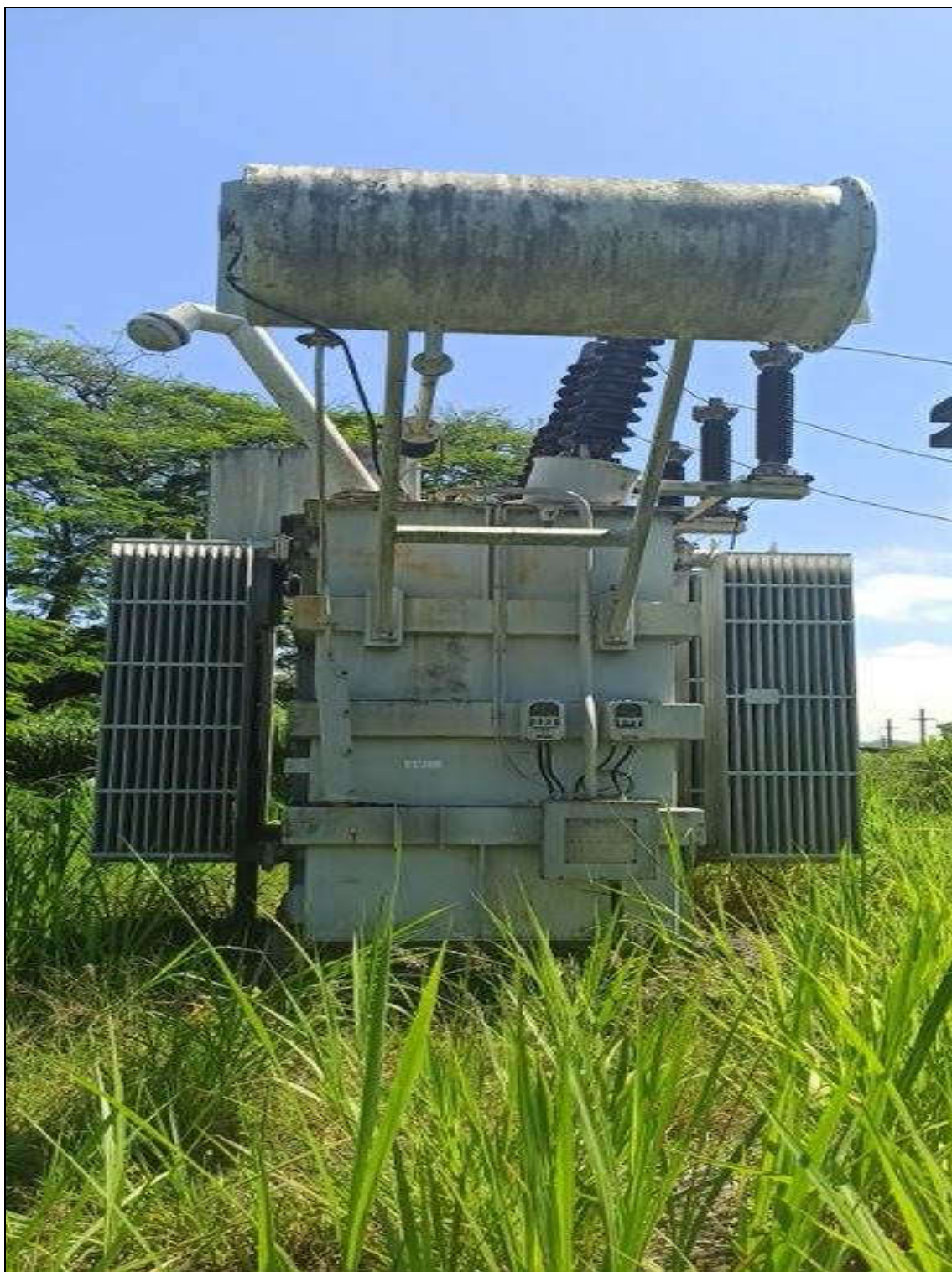
ITEM 1,028 – VISTA DO TRANSFORMADOR DE TENSAO A OLEO, FAB. BBC, 7500 KVA, 69 / 13,8 KV (REFORMADO EM 2000 PELA DENSITEL)
