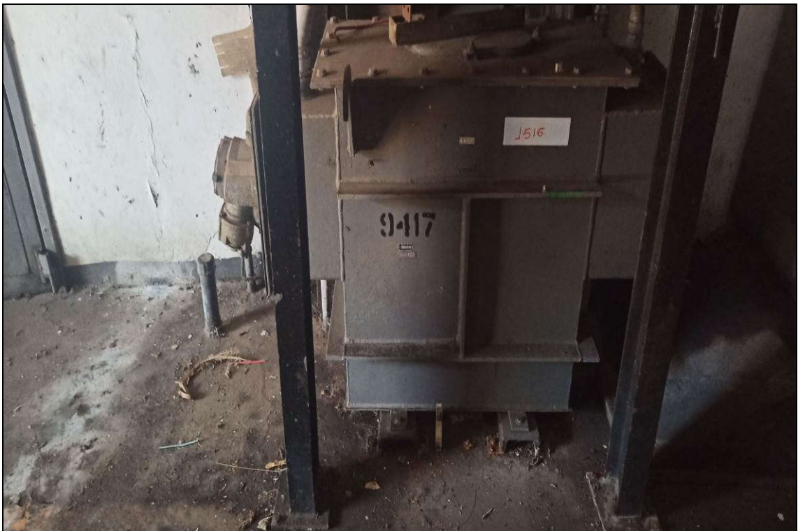
ITEM 1,039 – VISTA DO TRANSFORMADOR DE TENSÃO, TENSÃO ENTRADA 480 V, TENSÃO SAÍDA 220 V, POT. 15 KVA
