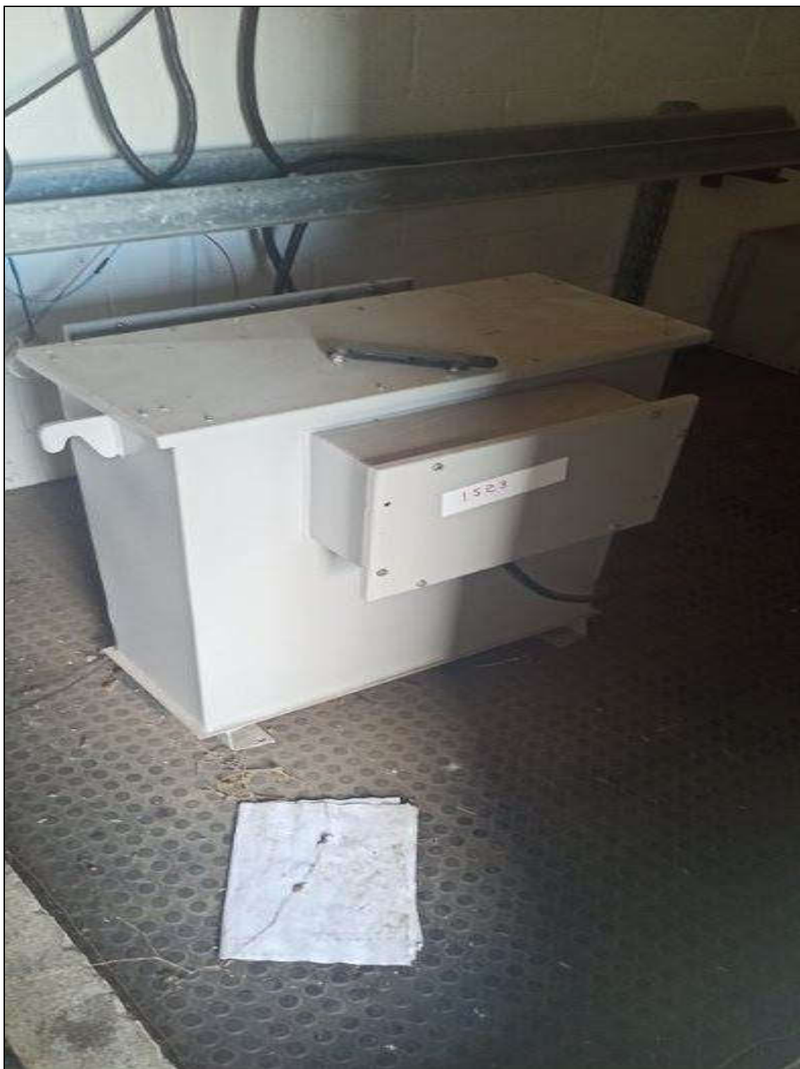
ITEM 1,043 – VISTA DO TRANSFORMADOR DE TENSÃO 30 KVA, FAB. ISOLANO TRANSCAV
