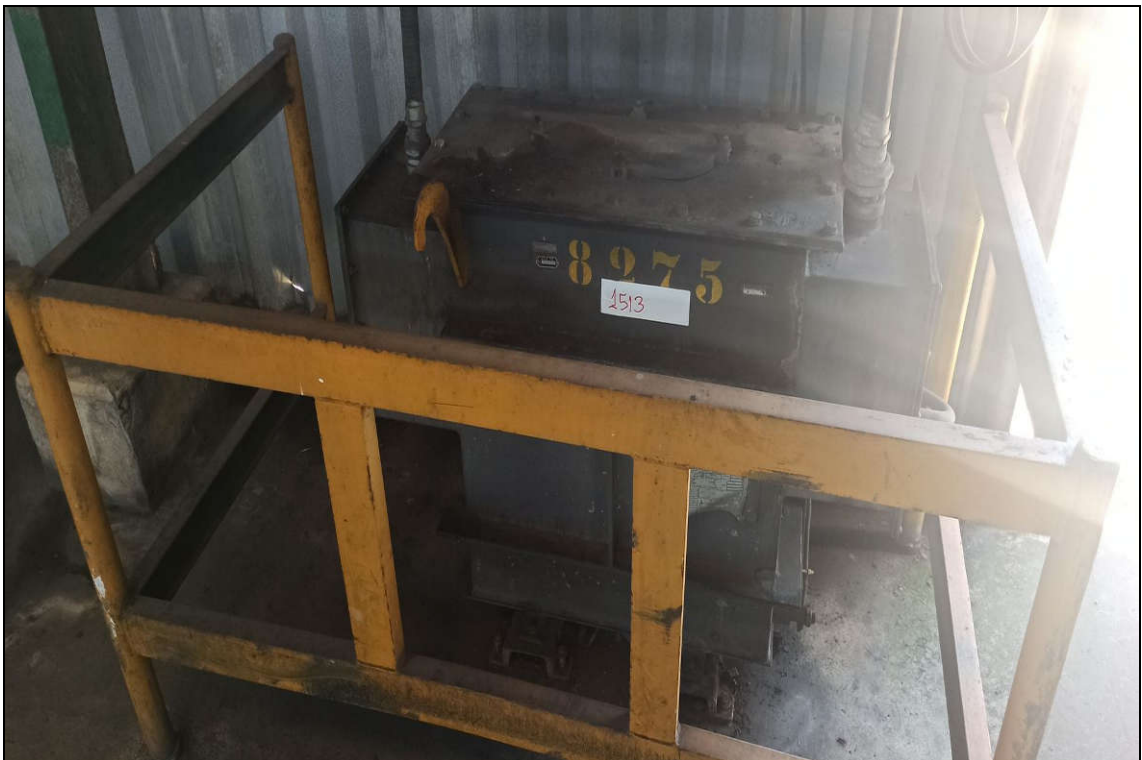
ITEM 1,037 – VISTA DO TRANSFORMADOR A SECO, FAB. TRAF0, MOD. TTM30, 30 KVA, 440-220 V
