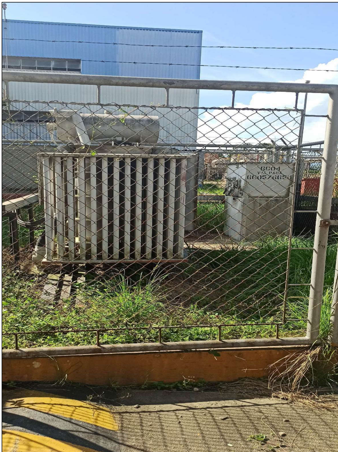
ITEM 1,003 – VISTA DA SUBESTACAO ELETRICA, FAB. ABB, 13,8 KV / 440 V COMPOSTA POR TRANSFORMADOR TRIFASICO A OLEO FAB. TRAFOT. 1,0 MVA TENSÃO ENTR/SAIDA 13,8 KV/460 V, TRANSFORMADOR TRIFASICO A OLEO FAB. TRAFOT. 750 KVA TENSÃO ENTR/SAIDA 13,8 KV/460 V, PAINEL SECCIONADOR
