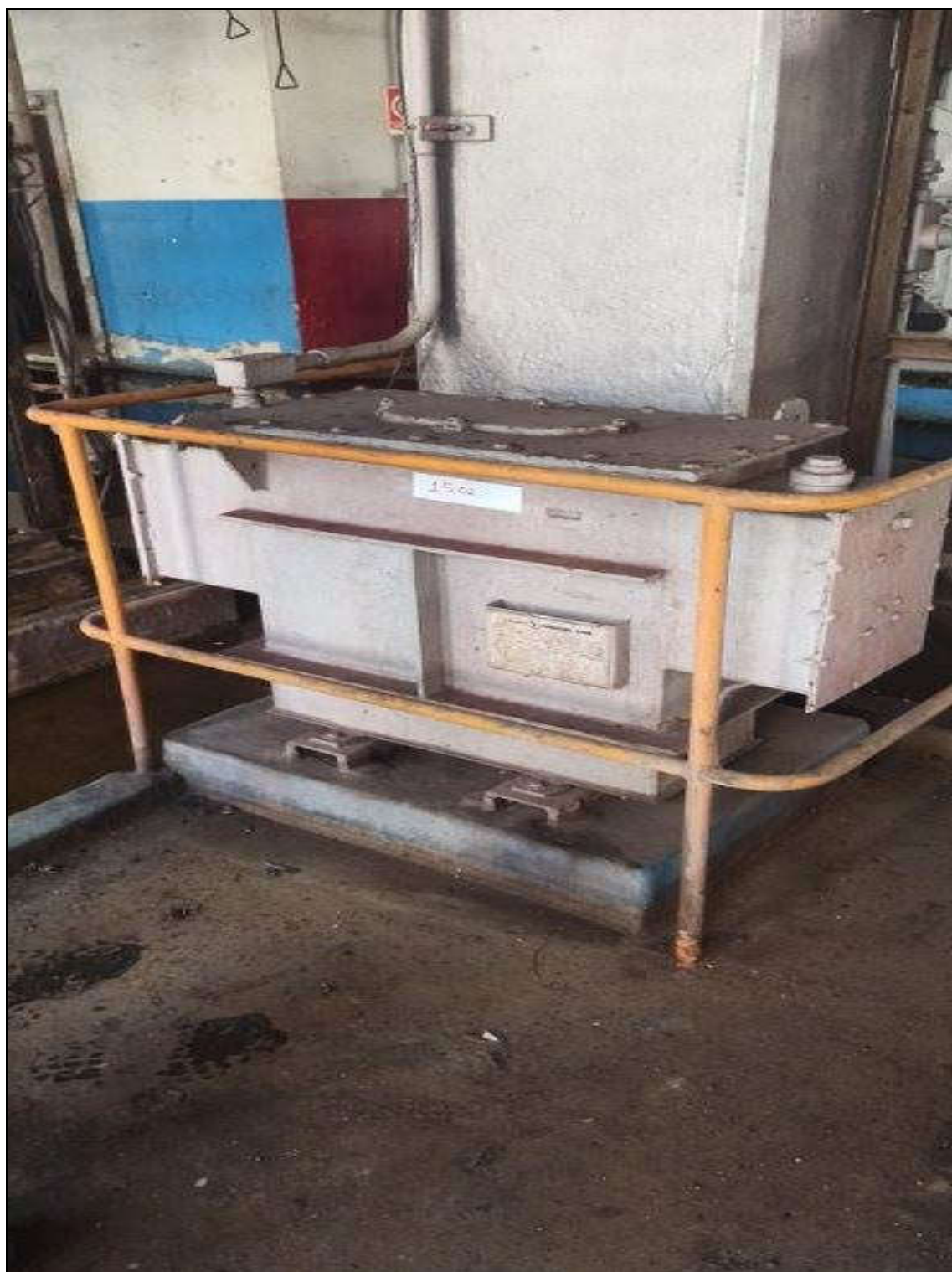
ITEM 1,032 – VISTA DO TRANSFORMADOR TRIFASICO A SECO, FAB. TRAF0, MOD. TTM30/1.2, 30 KVA, 480 - 220 V
