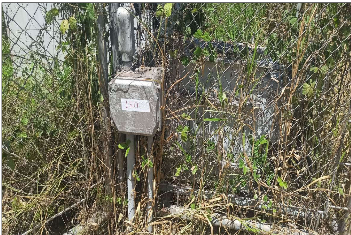
ITEM 1,040 – VISTA DO TRANSFORMADOR TRIFASICO A SECO, FAB. TRAFO, MOD. TTM30/1.2, 30 KVA, 480 - 220 V
