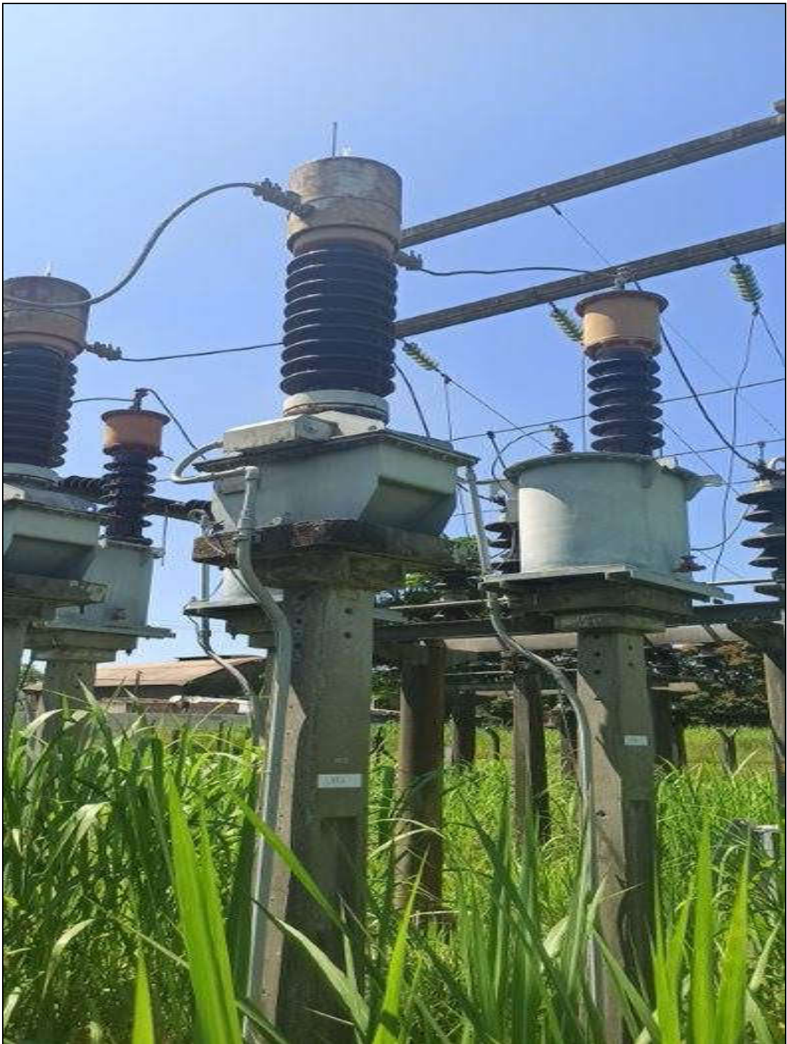
ITEM 1,022 – VISTA DO TRANSFORMADOR DE CORRENTE, FAB. SIEMENS, MOD. ATOF69, TENSAO 69 KV
