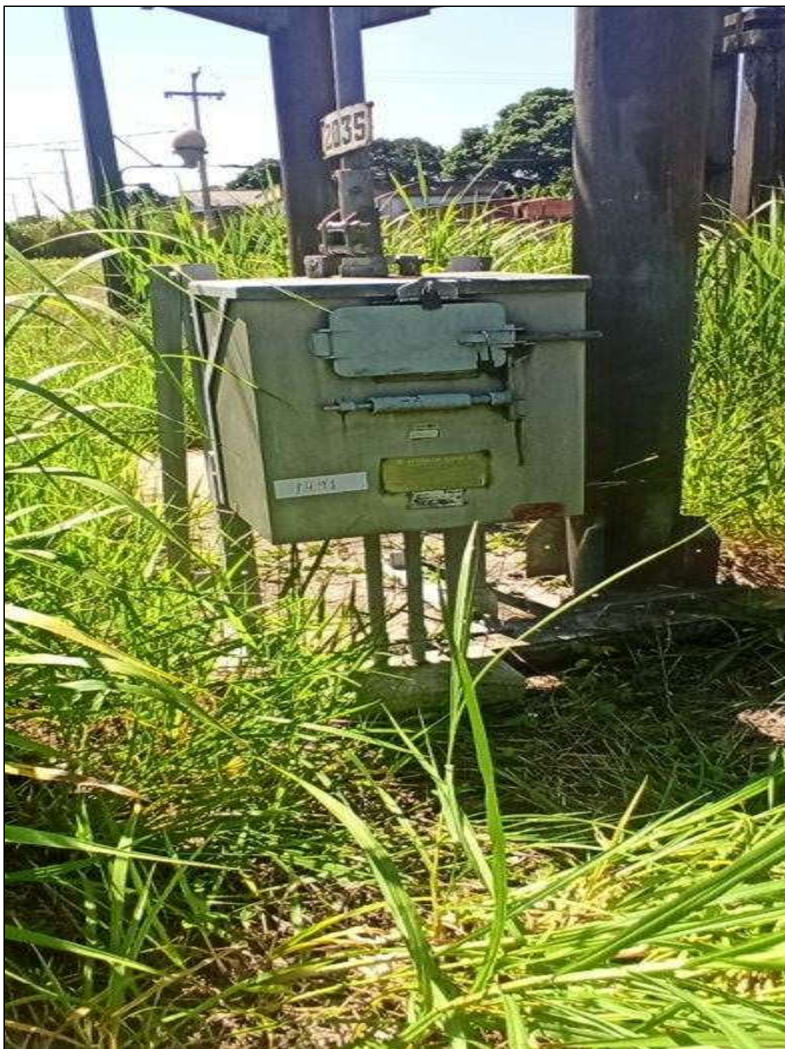
ITEM 1,048 – VISTA DA CHAVE SECCIONADORA MOTORIZADA, FAB. HITACHI, MOD. RB729RB730, MOTOR ELETRICO POT. 0, 5 HP 125 VCC
