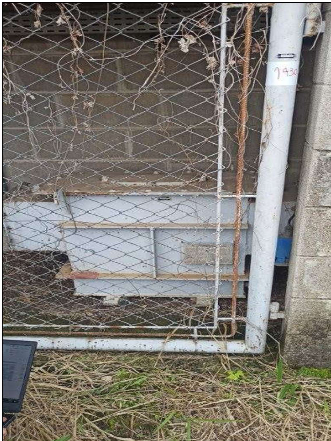
ITEM 1,011 – VISTA DO TRANSFORMADOR A SECO, FAB. TRAF0, MOD. TTM30/1.2, 30 KVA, 440-220 V
