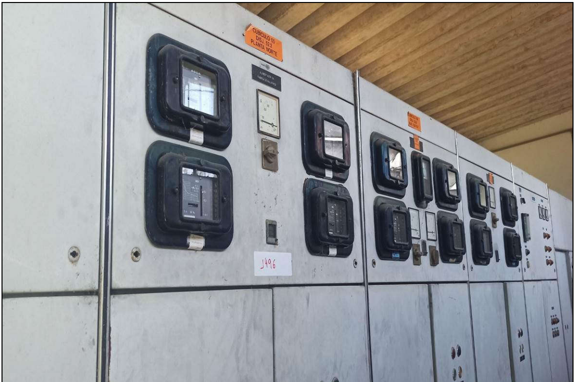
ITEM 1,052 – VISTA DO PAINEL DE ALIMENTACAO E CONTROLE DUPLA FACE 13,8 KV, 04 MODULOS, DIM. 4000X1800X2300 MM
