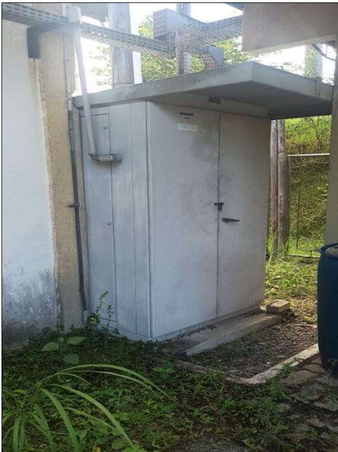
ITEM 1,054 – VISTA DO CUBICULO TRANSFERENCIA DE ENTRADA, FAB. CERJ, GERADOR DIM. 1800X1300X2000 MM
