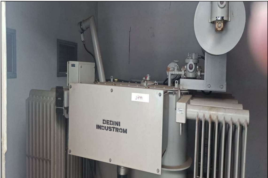
ITEM 1,029 –VISTA DO TRANSFORMADOR TRIFASICO A OLEO, FAB. DEDINI, MOD. T3750-15/1.2.LF.LF.C, 500 KVA, TENSAO ENTR/SAIDA 13,8 KV / 480 V
