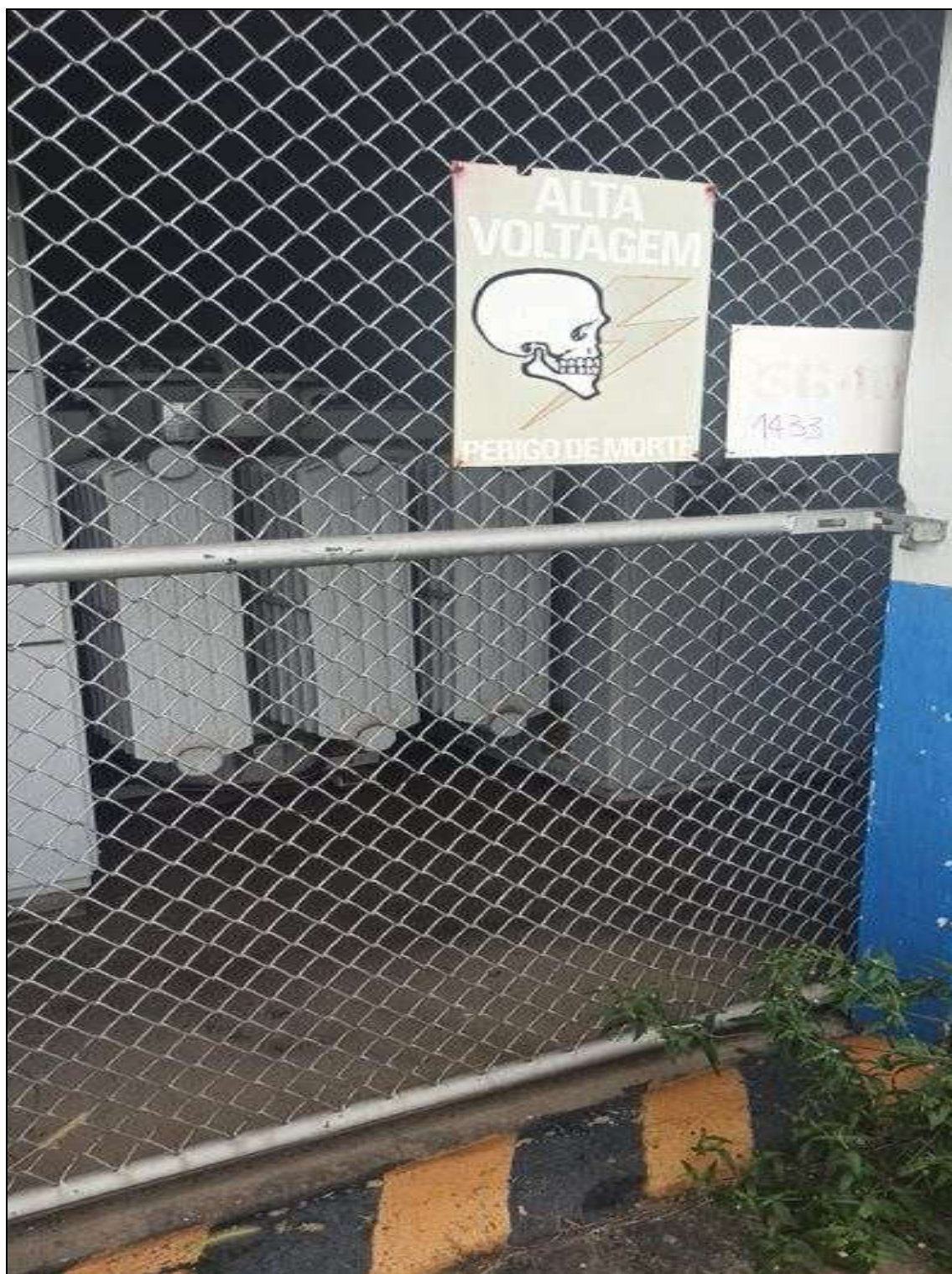
ITEM 1,014 – VISTA DO TRANSFORMADOR DE POTÊNCIA, FAB. SUPERKAVEA, 300 KVA, 13200-220/127 V - 13.800 - 220/127
