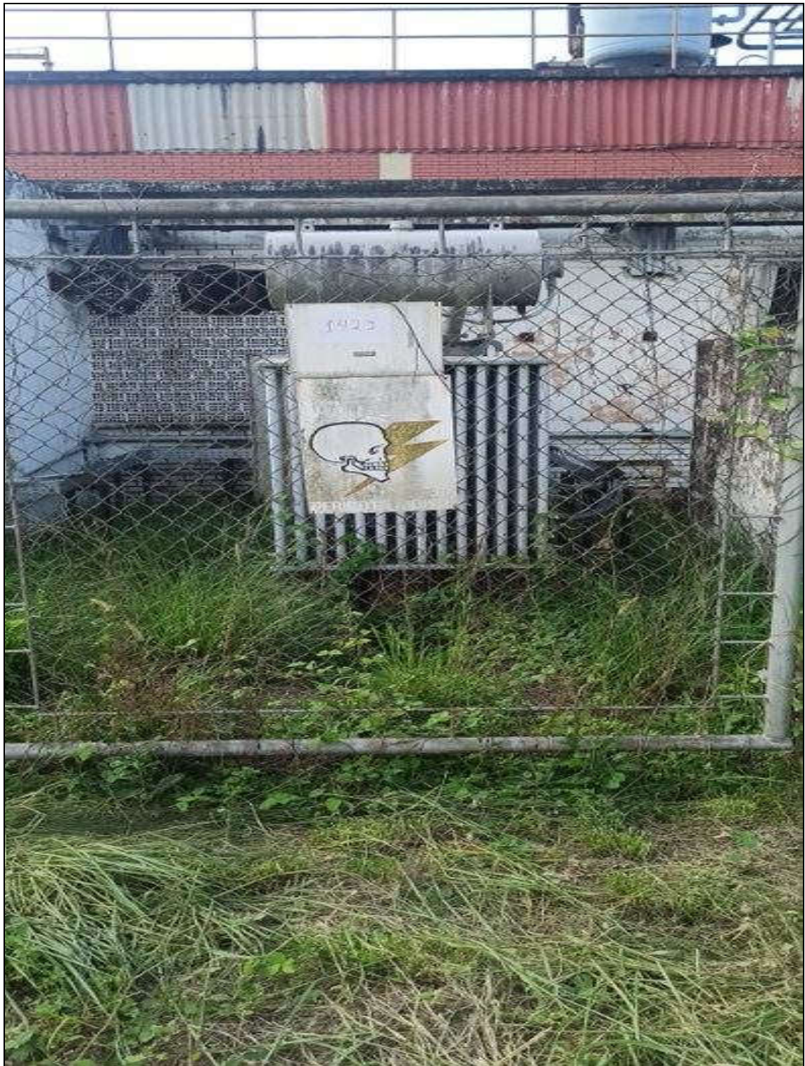
ITEM 1,005 – VISTA DO TRANSFORMADOR TRIFASICO A OLEO, FAB. THERMOTRAFO, MOD. TTOFSU 1000/15, TENSAO ENTR/SAIDA 13,8 KV/480 V, POT. 1,0 MVA
