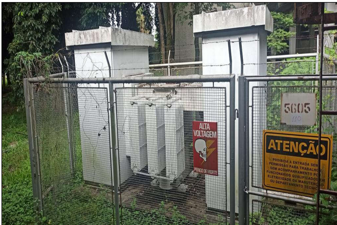
ITEM 1,001 - VISTA DA SUBESTACAO ELETRICA, 13,8 KV / 220 V, COMPOSTA POR TRANSFORMADOR TRIFASICO A OLEO, FAB. SUPERKAVEA, TIPO T500/136, POT. 500 KVA, PAINEL SECCIONADOR DE ENTRADA 13,8 KV, DIM. 1000X1000X2300 MM E PAINEL DE BAIXA 220 V, DIM. 1000X1000X2300 MM
