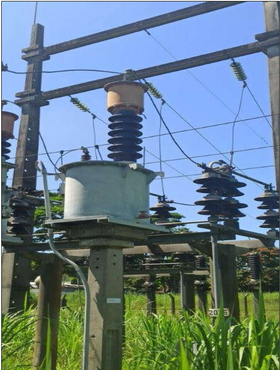
ITEM 1,023 – VISTA DO TRANSFORMADOR DE CORRENTE, FAB. SIEMENS, MOD. ATOF69, TENSAO 69 KV
