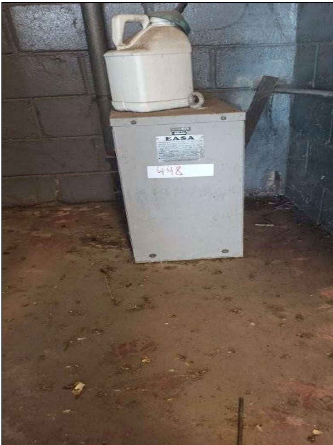
ITEM 1,002 – VISTA DO TRANSFORMADOR DE TENSAO, FAB. EASA, TENSAO ENTRADA 480 V, TENSAO SAIDA 120 V, POT. 15 KV
