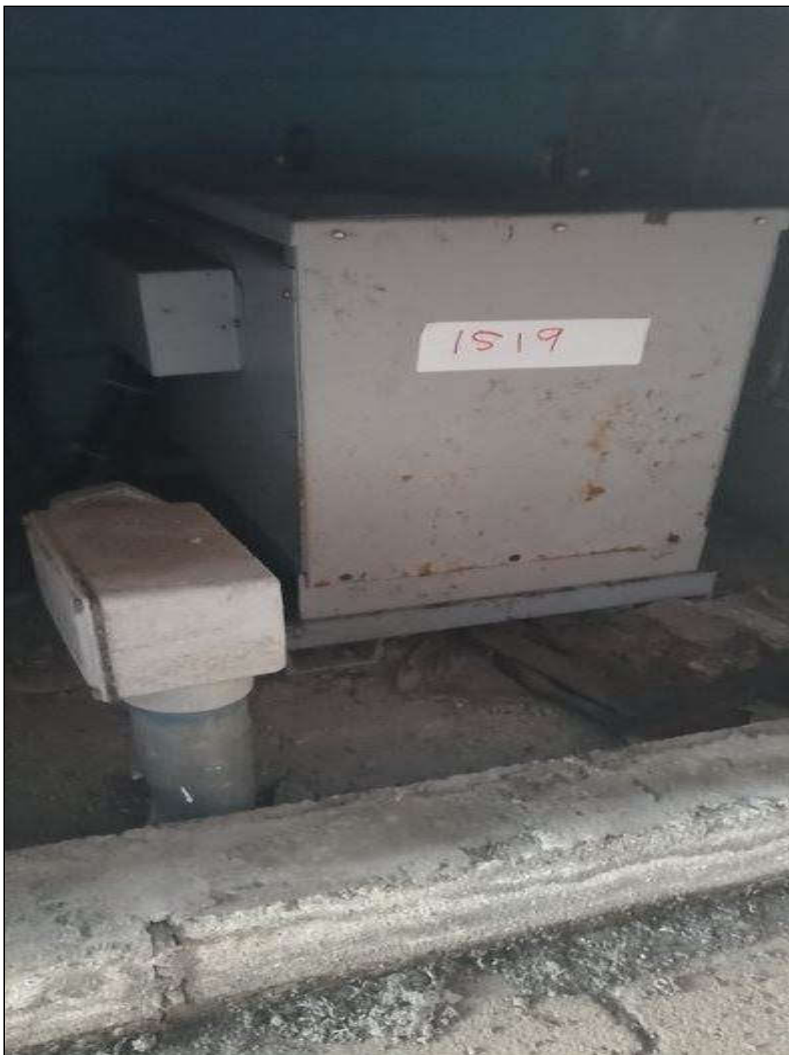
ITEM 1,041 – VISTA DO TRANSFORMADOR A SECO, FAB. SOLANO TRANKAV, 30 KVA
