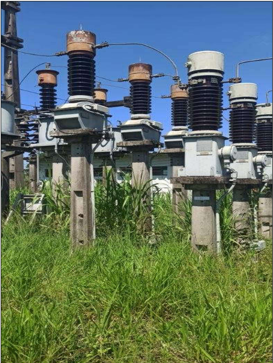
ITEM 1,018 – VISTA DO TRANSFORMADOR DE POTÊNCIA, FAB. HITACHI, MOD. QD68-69, 69 KV
