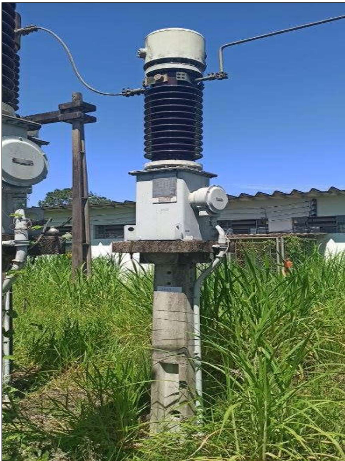
ITEM 1,020 – VISTA DO TRANSFORMADOR DE POTÊNCIAL, FAB. HITACHI, MOD. QD68-69, 69 KV
