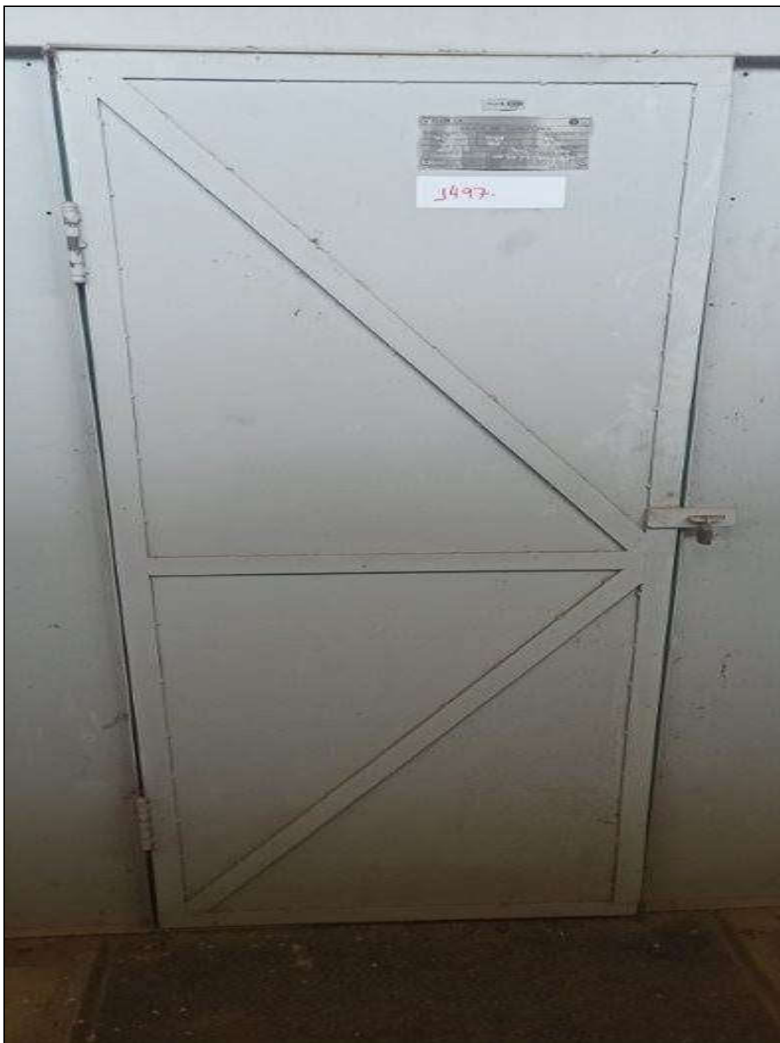
ITEM 1,053 – VISTA DO PAINEL COM BANCO DE CAPACITORES, FAB. EL-CON, 13,8 KV, CAPAC. 600 KVAR E CHAVE SECCIONADORA TRIPOLAR
