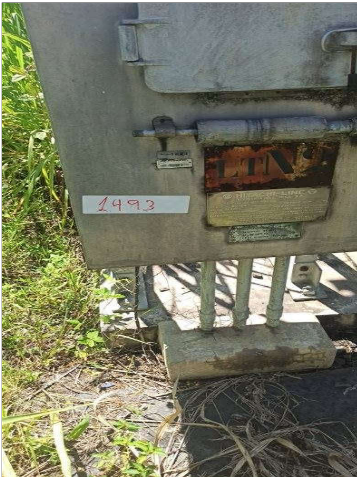
ITEM 1,027 – VISTA DO TRANSFORMADOR DE CORRENTE, FAB. ASEA, MOD. IMBD72A, TENSAO 69 KV
