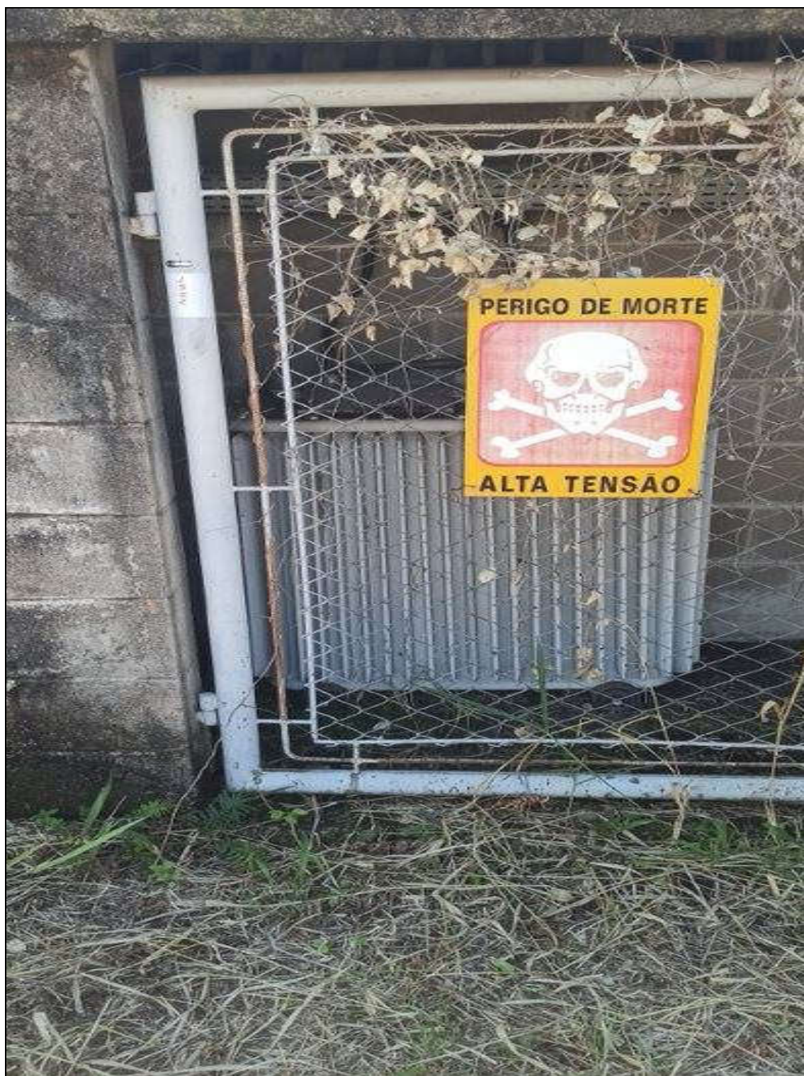
ITEM 1,042 – VISTA DO TRANSFORMADOR DE TENSÃO, FAB. TRATOFREIA
