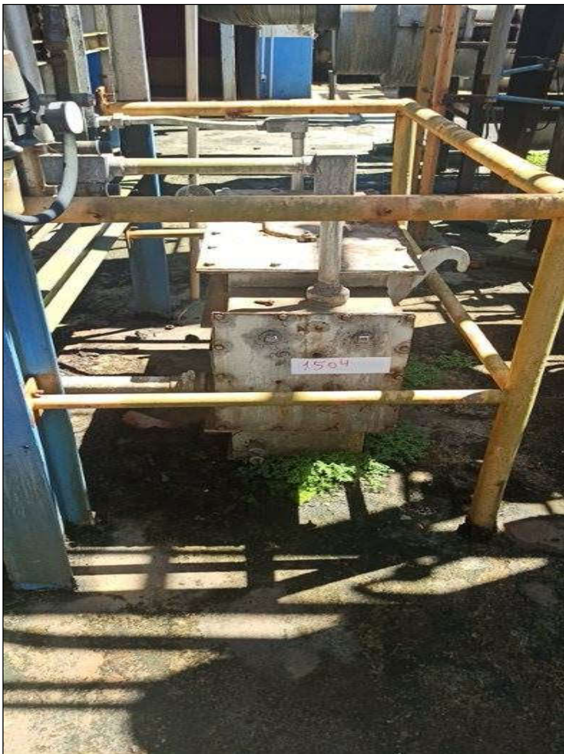
ITEM 1,034 – VISTA DO TRANSFORMADOR TRIFASICO A SECO, FAB. TRAFO, MOD. TTM30/1.2, 30 KVA, 480 - 220 V
