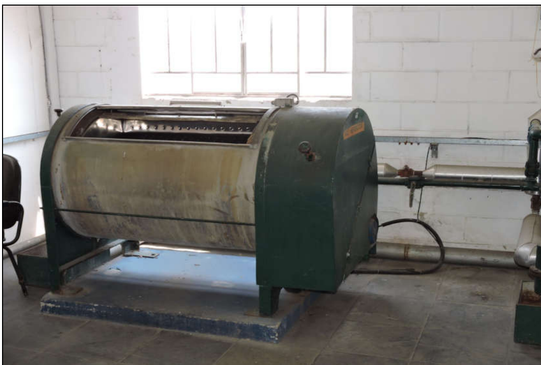
OUTROS - EQUIPAMENTOS DE LAVANDERIA
