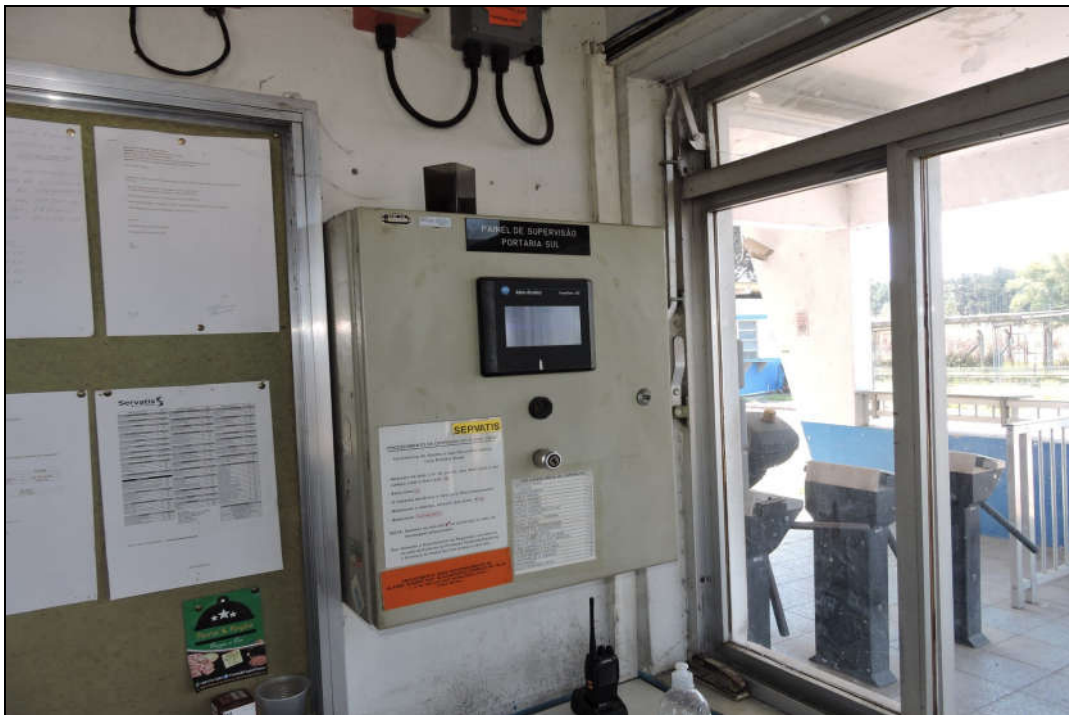
OUTROS - PAINEL DE ALARME E SUPERVISÃO
