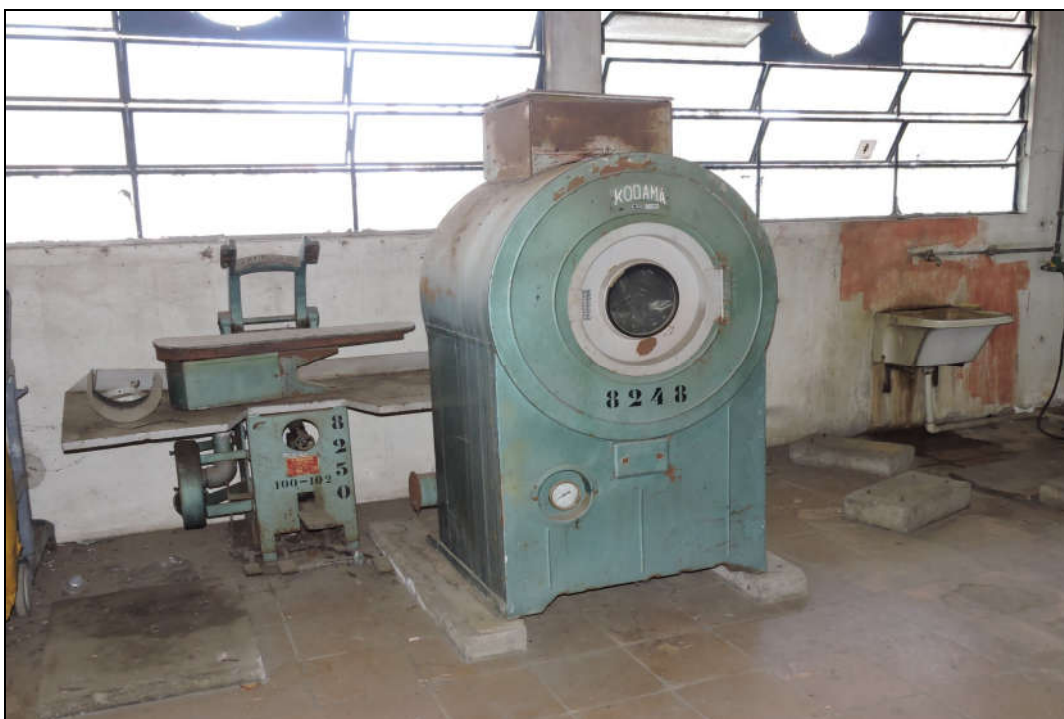
OUTROS - EQUIPAMENTOS DE LAVANDERIA
