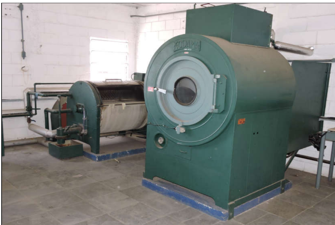
OUTROS - EQUIPAMENTOS DE LAVANDERIA
