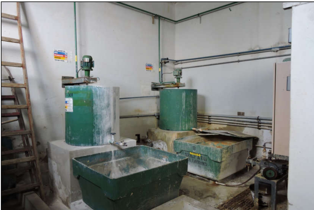
UTILIDADES PLANTA SUL – ETA – TANQUES AGITADORES
