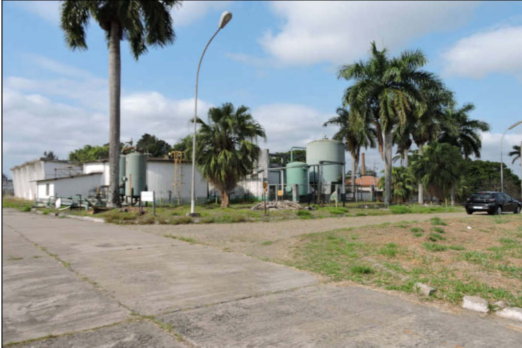
UTILIDADES PLANTA SUL – VISTA GERAL DA ETA
