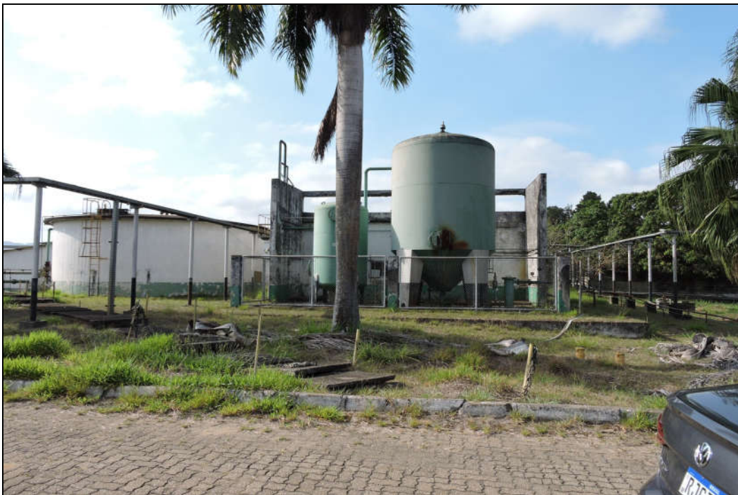
UTILIDADES PLANTA SUL – VISTA LATERAL DA ETA
