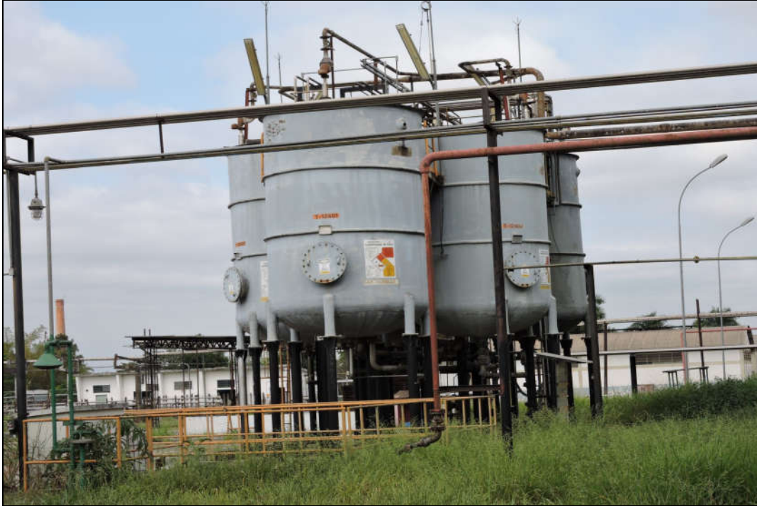
FORMULAÇÃO SUL - TANQUES EXTERNOS
