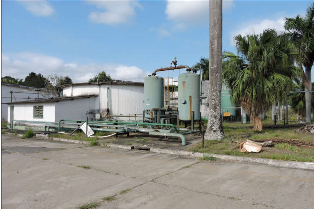
UTILIDADES PLANTA SUL – VISTA LATERAL DA ETA
