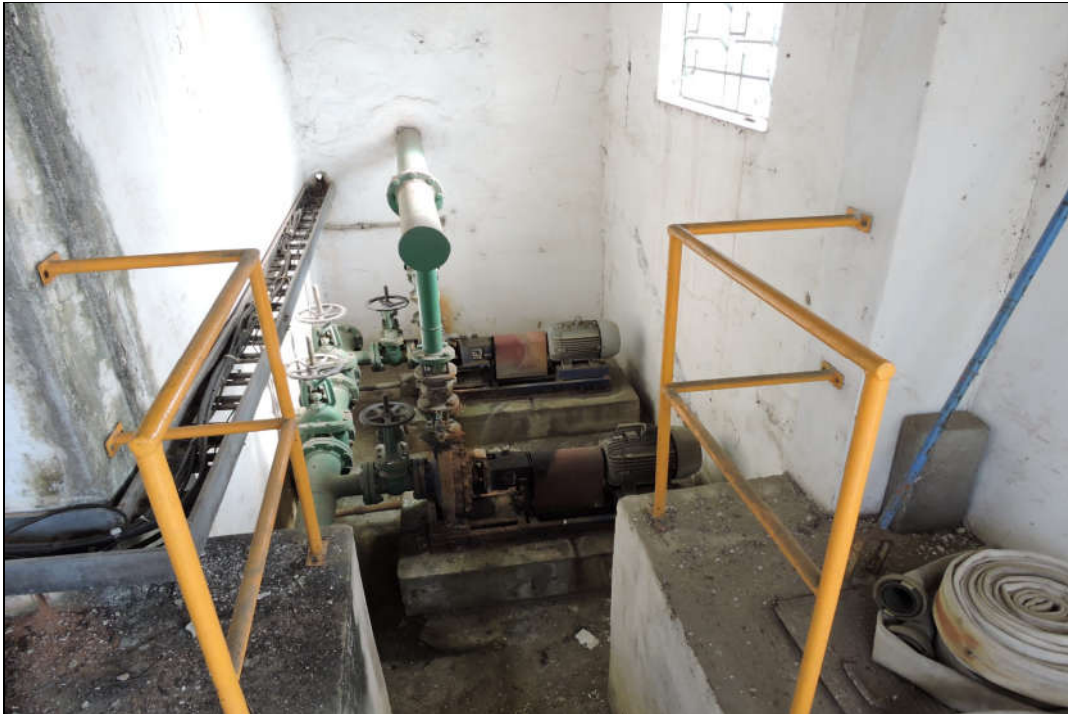
UTILIDADES PLANTA SUL – BOMBAS DA ETA
