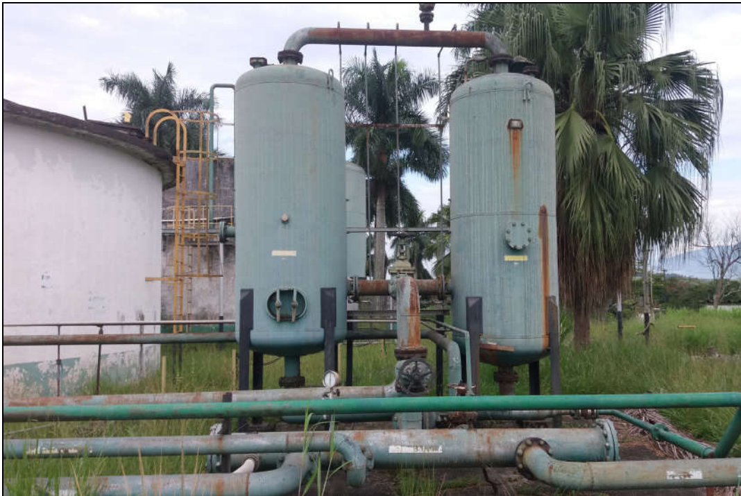
UTILIDADES PLANTA SUL - VASO CILINDRO VERTICAL, FAB. ATLAS COPCO, MAT. AÇO CARBONO, CAPAC. 2,5 M3, DIAM. 1000X2500 MM
