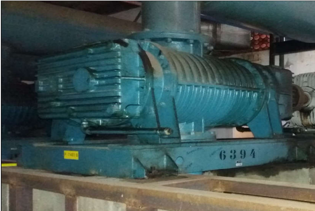
ITEM 1,015 – ETE - SOPRADOR DE AR, FAB. OMEL, MOD. SRU2767, VAZÃO 64 M3/MIN, PRESSÃO 725 MMHG, ACION. MOTOR ELÉTRICO 125 CV
