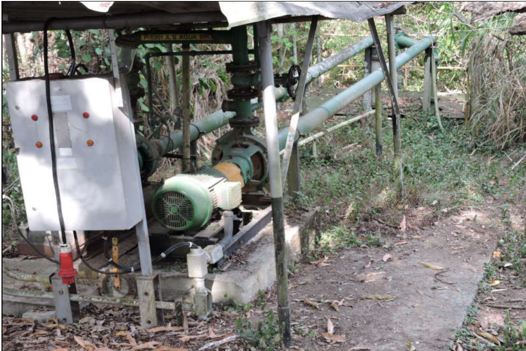
ITEM 1,016 - ETE - BOMBA DE CAPTAÇÃO
