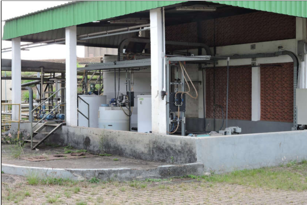
ETE - VISTA GERAL - TRATAMENTO FÍSICO-QUÍMICO
