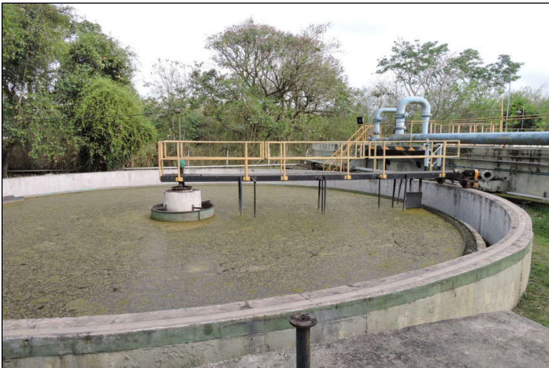
ITEM 1,009 - ETE – DECANTADOR
