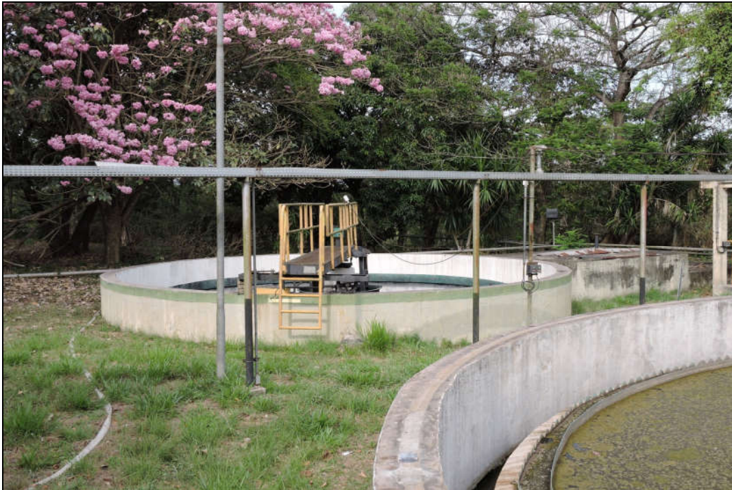
ITEM 1,010 - ETE - DECANTADOR
