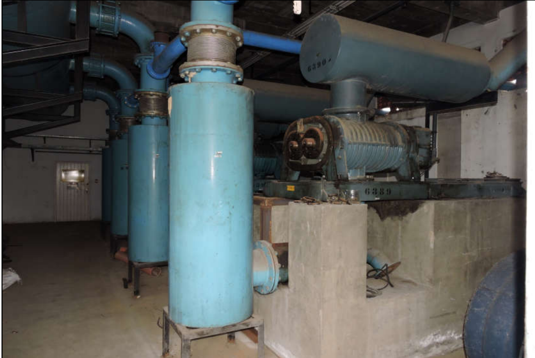
ETE - VISTA INTERNA - SALA DOS SOPRADORES
