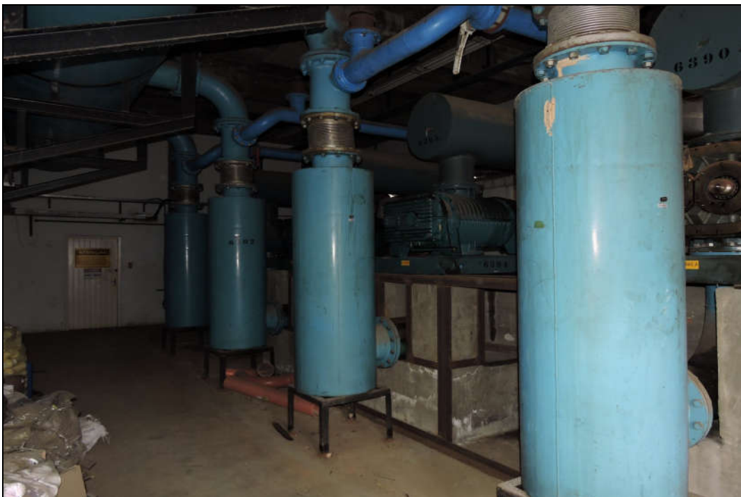
ETE - VISTA INTERNA - SALA DOS SOPRADORES
