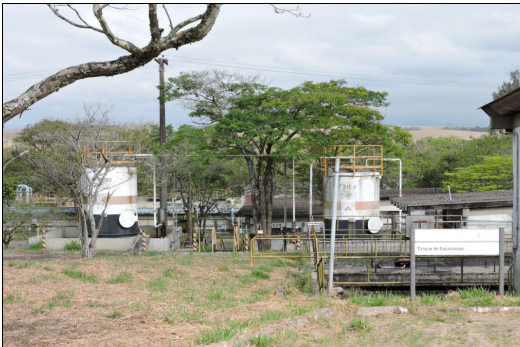
ETE - VISTA - TANQUES
