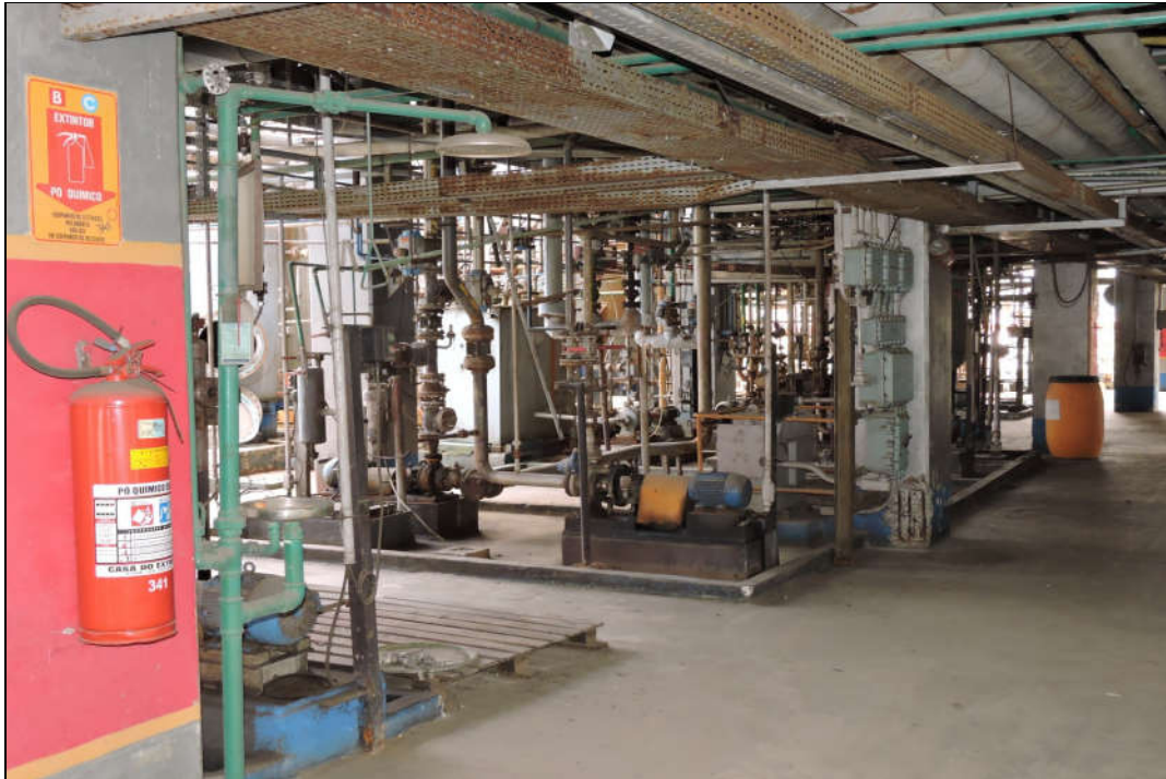
SÍNTESE - TIN SHOP - PRIMEIRO PAVIMENTO - VISTA GERAL DE EQUIPAMENTOS
