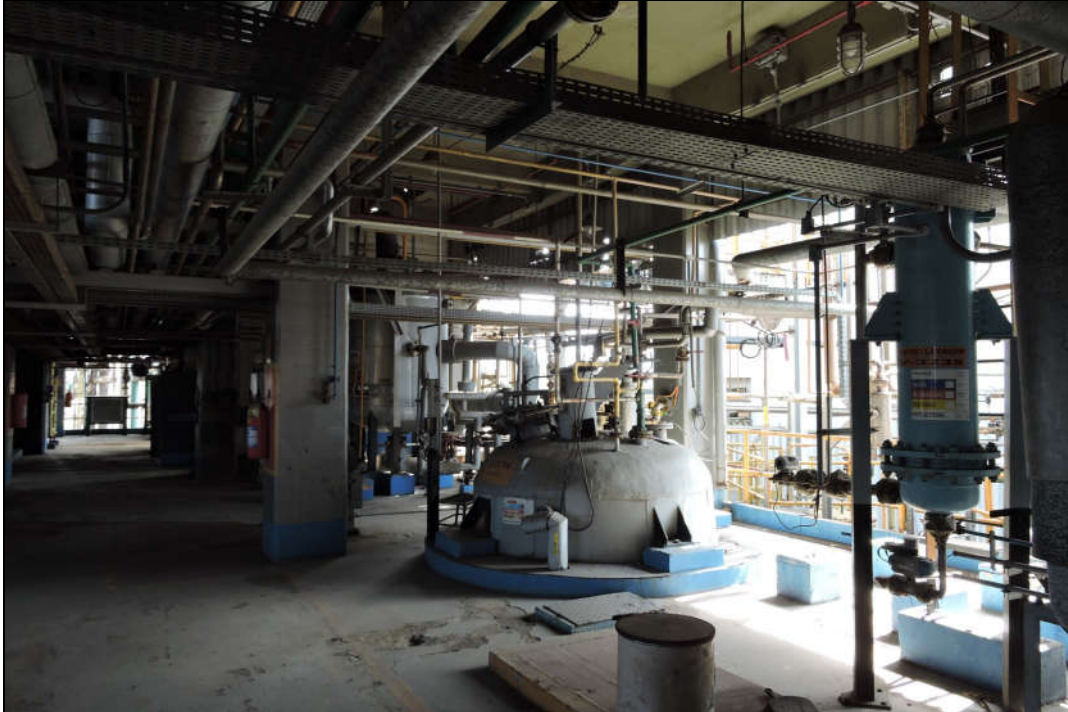
SÍNTESE - TIN SHOP - SEGUNDO PAVIMENTO - VISTA SUPERIOR DOS REATORES
