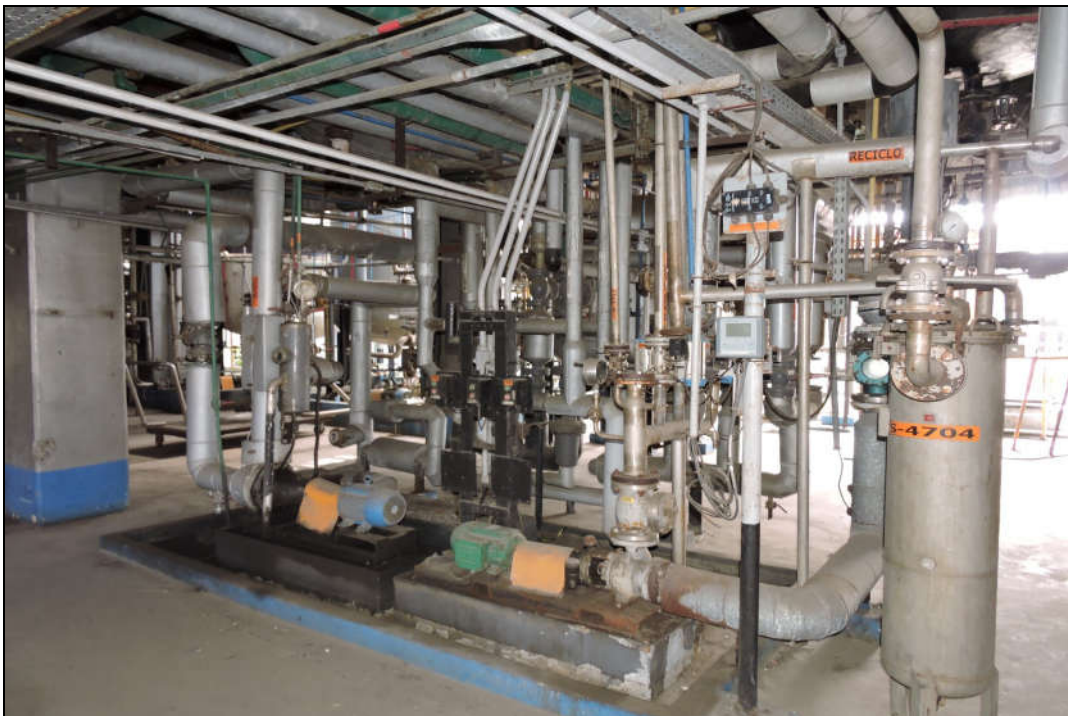
SÍNTESE - TIN SHOP - PRIMEIRO PAVIMENTO - VISTA PARCIAL DE EQUIPAMENTOS
