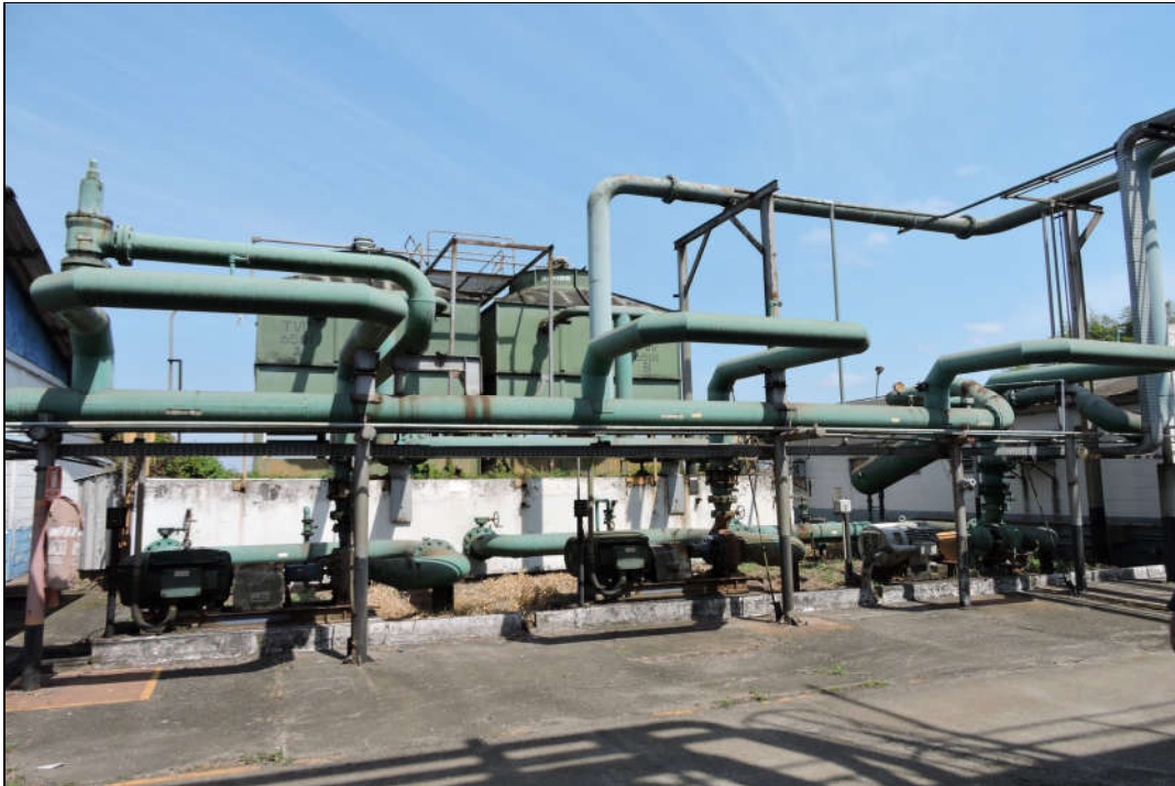
UTILDADES PLANTA NORTE - TORRE DE RESFRIAMENTO
