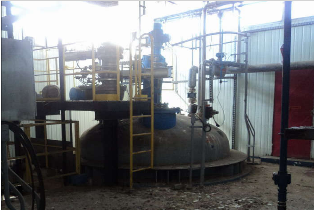
ITEM 1,0659 - SÍNTESE - TIN SHOP - VASO, FAB. PFAUDLER, CILÍNDRICO VERTICAL, MAT. AÇO INOX 316, ISOL. TÉRMICO HOLD TANK, CAPAC. 23,4 M3, AGITADOR, REDUTOR E MOTOR ELÉTRICO POT. 25 CV
