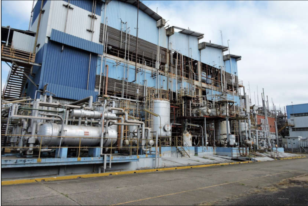
SÍNTESE - JOB SHOP - VISTA DA LATERAL – EQUIPAMENTOS EXTERNOS
