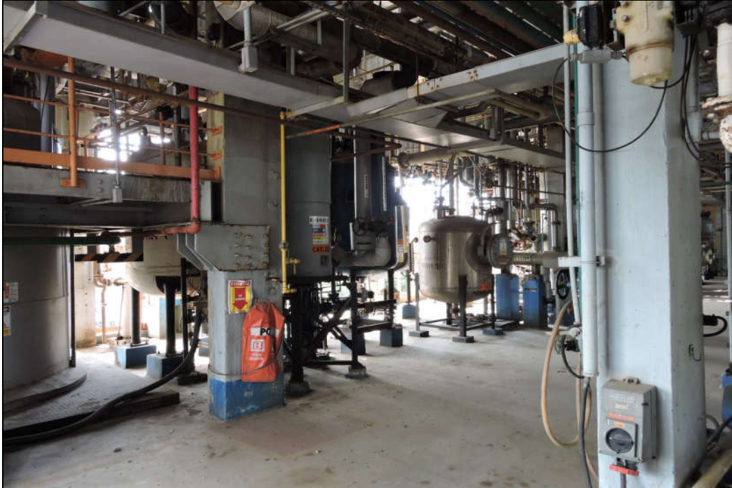
SÍNTESE - JOB SHOP - TERCEIRO PAVIMENTO - VISTA GERAL DOS EQUIPAMENTOS
