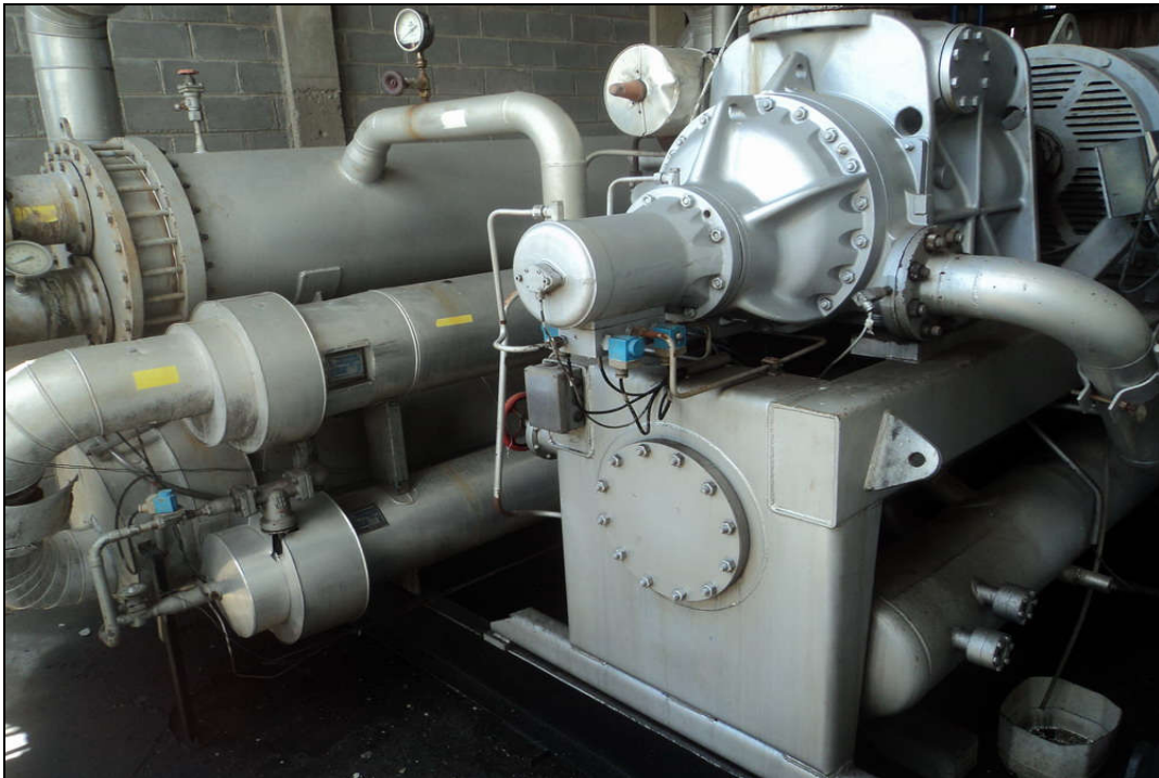
ITEM 1,0868 - UTILIDADES PLANTA NORTE - CHILLER DE SALMOURA, FAB. SABROE, MOD. PLCY1347H, CAPAC. 818,5 KW, MOTOR ELÉTRICO POT. 600 HP UTILIDADES PLANTA NORTE
