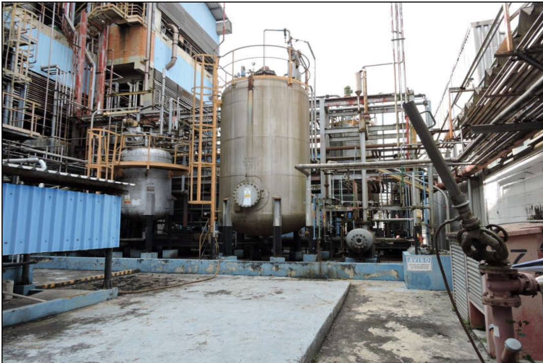
SÍNTESE - JOB SHOP - PRIMEIRO PAVIMENTO - VISTA DOS TANQUES EXTERNOS
