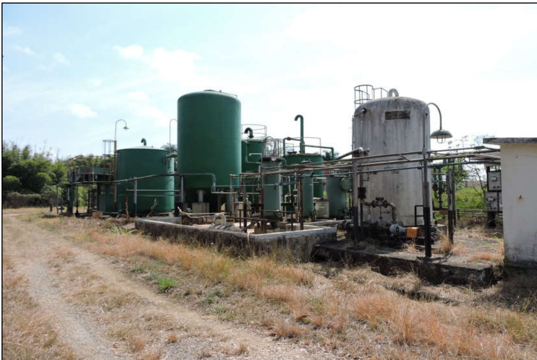
UTILDADES PLANTA NORTE ETA - VISTA LATERAL
