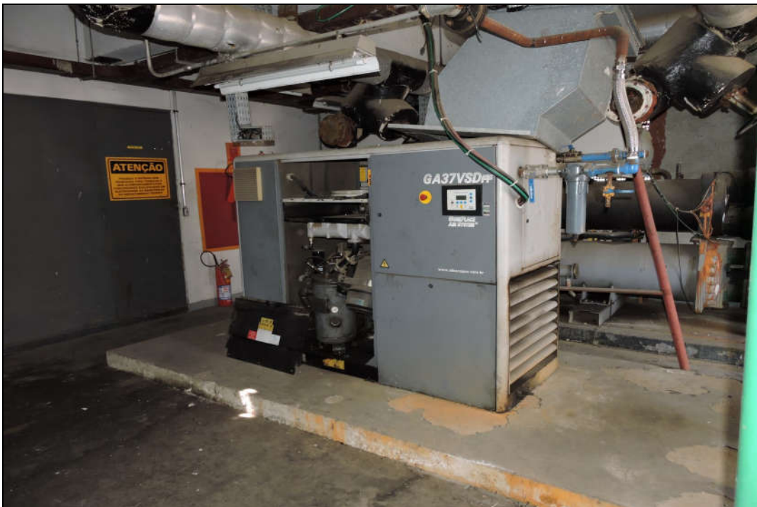
UTILDADES PLANTA NORTE - COMPRESSOR GA37
