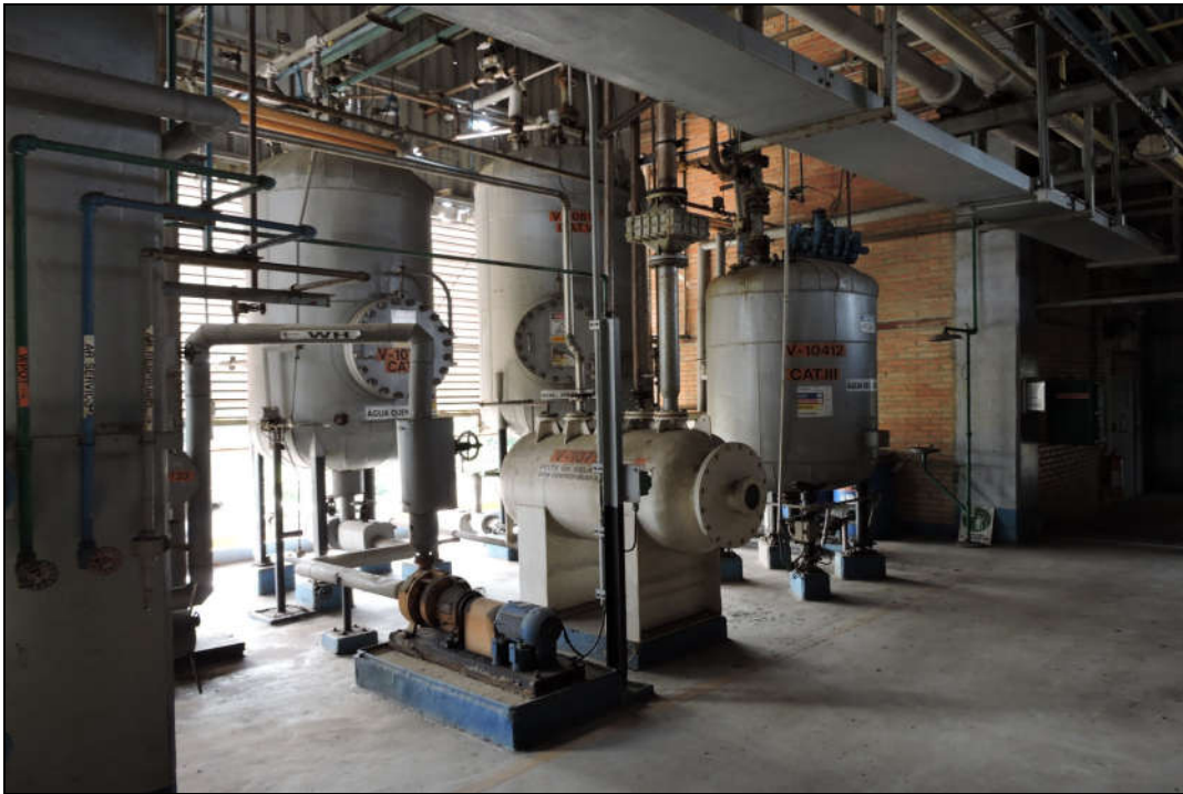
SÍNTESE - JOB SHOP - TERCEIRO PAVIMENTO - VISTA PARCIAL DOS EQUIPAMENTOS
