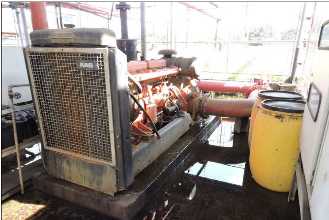
UTILDADES PLANTA NORTE - MOTO-BOMBAS DE INCENDIO
