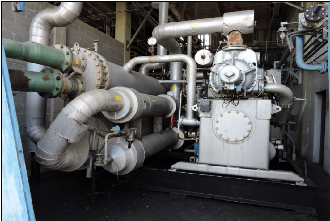
UTILDADES PLANTA NORTE - DETALHE DO CHILLER SABROE
