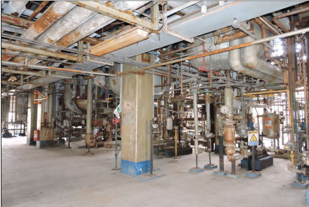
SÍNTESE - JOB SHOP - PRIMEIRO PAVIMENTO - VISTA INFERIOR REATORES
