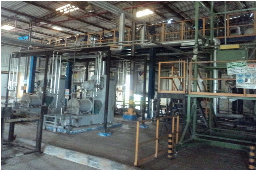
ITENS 1,0108; 1,0111 - FORMULAÇÃO NORTE - PINHO SOL - MOINHO HORIZONTAL, FAB. NETZSCH, MOD. LMZ60, ACIONAM. MOTOR ELÉTRICO 100 CV
