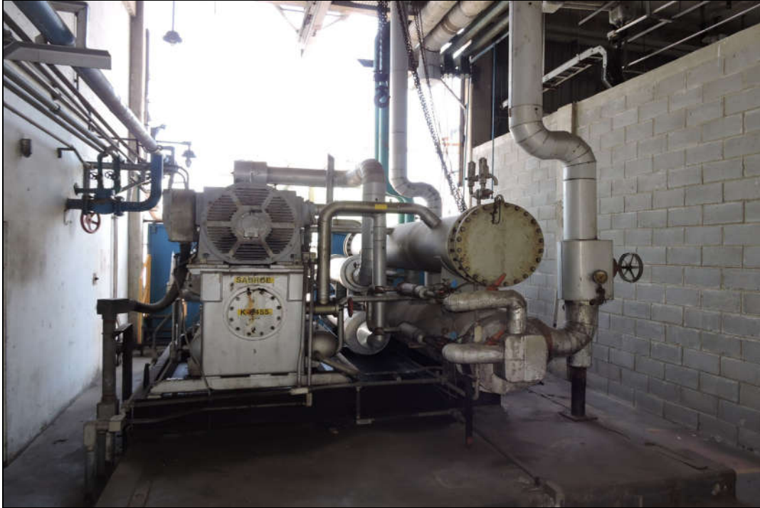
UTILIDADES PLANTA NORTE - VISTA TRAZEIRA DO CHILLER SABROE
