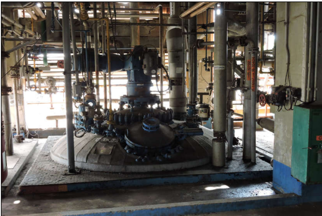
SÍNTESE - JOB SHOP - SEGUNDO PAVIMENTO - DETALHE SUPERIOR - REATOR
