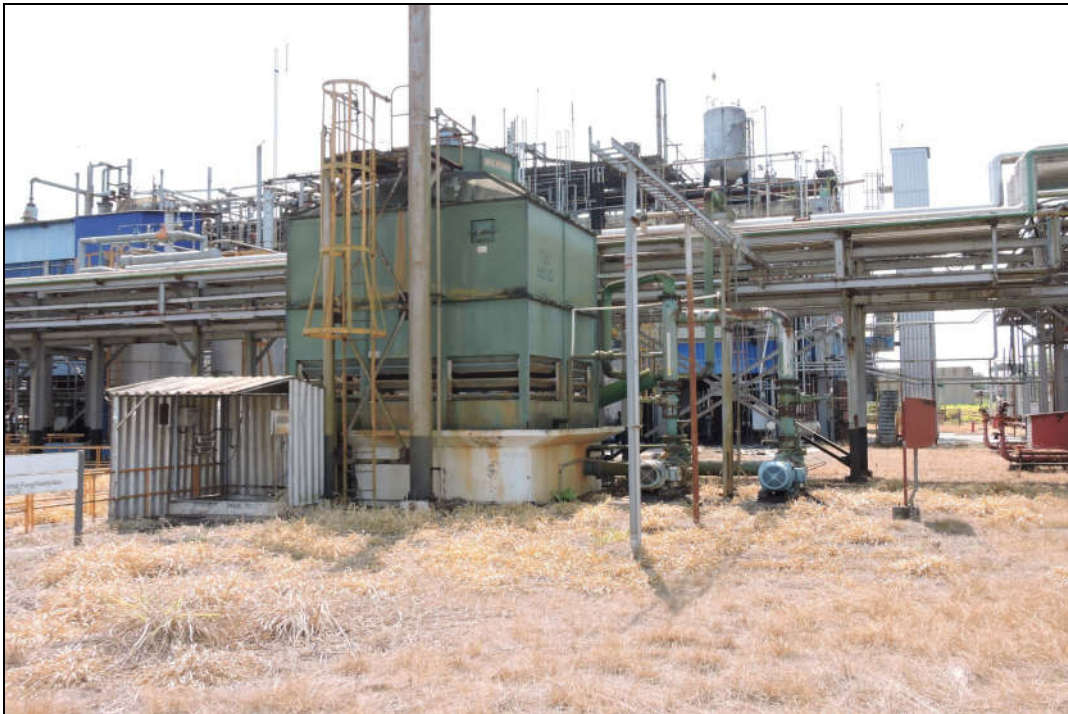
UTILDADES PLANTA NORTE - TORRE DE RESFRIAMENTO
