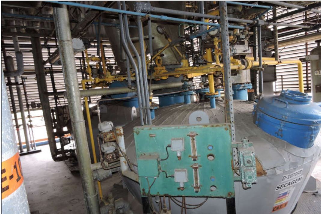
SÍNTESE - JOB SHOP - SEGUNDO PAVIMENTO – SECADORES
