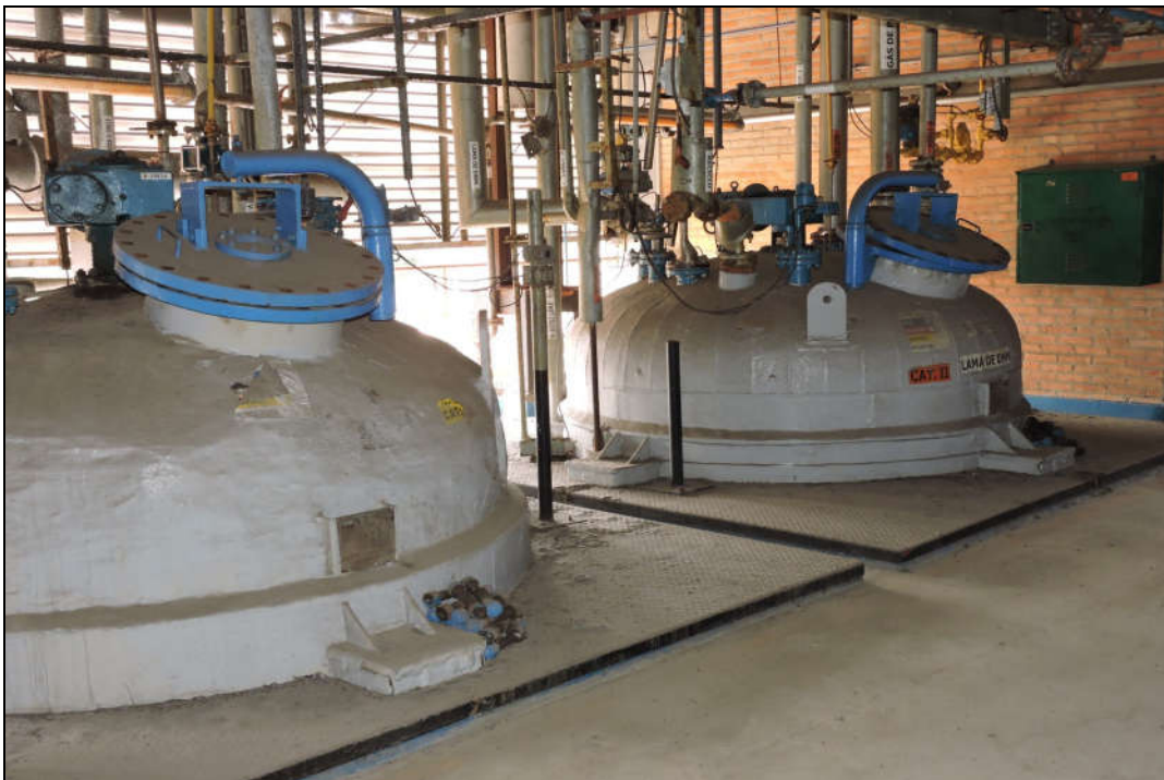
SÍNTESE - JOB SHOP - SEGUNDO PAVIMENTO - DETALHE SUPERIOR – REATORES
