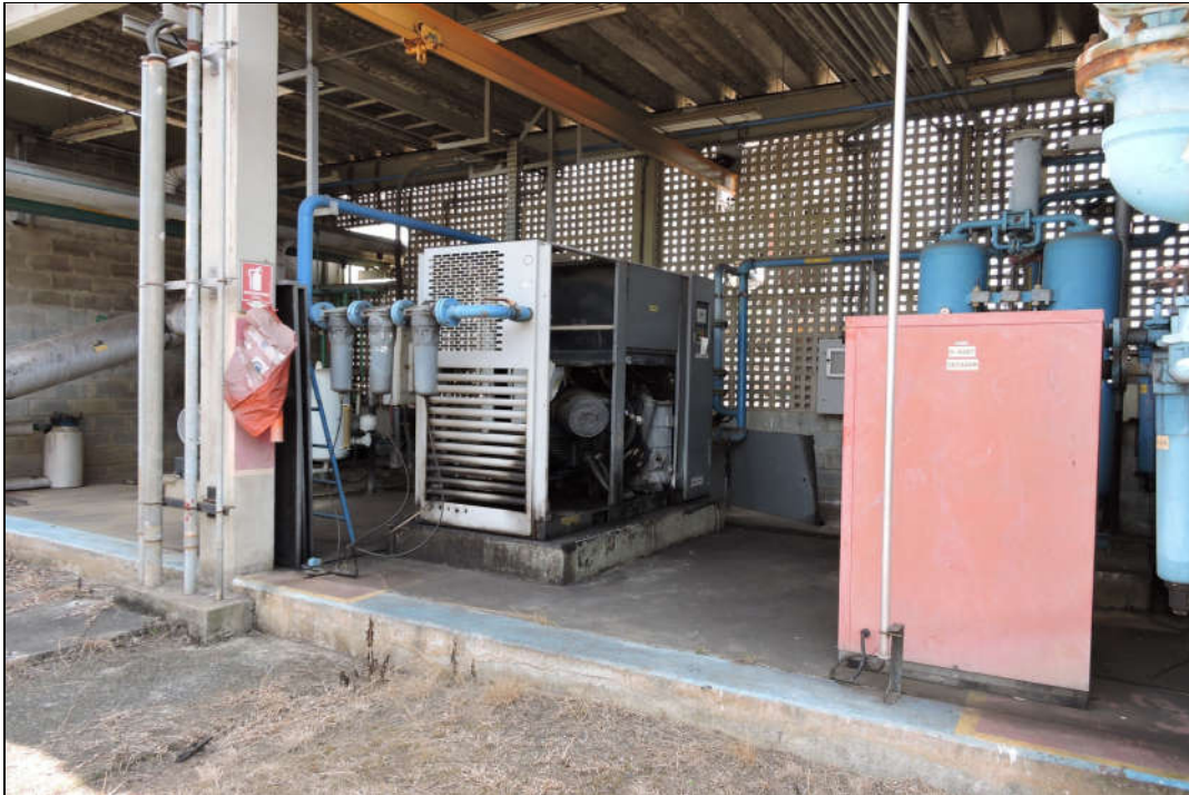
UTILDADES PLANTA NORTE - COMPRESSOR GA90
