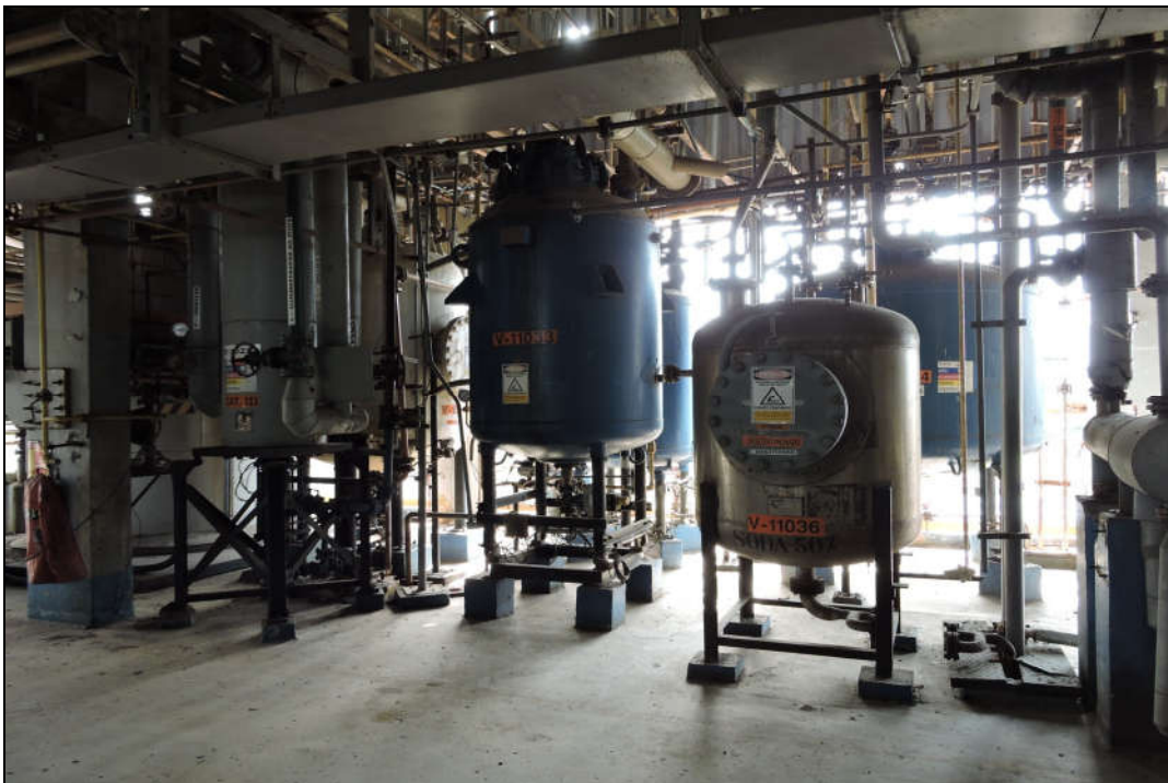
SÍNTESE - JOB SHOP - TERCEIRO PAVIMENTO - VISTA TANQUES VITRIFICADOS
