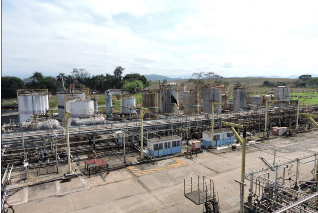
ITEM 1,0798 – TANCAGEM - TUBULAÇÃO, PIPE RACKS, INSTRUMENTAÇÃO E VÁLVULAS REFERENTES A ÁREA
