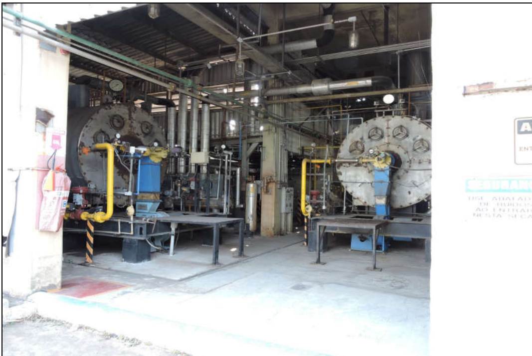
ITENS 1,0855; 1,0856 - UTILIDADES PLANTA NORTE - GERADORES DE VAPOR, FAB. ATA, MOD. H3N, TIPO ATA-26W 8M, CAPAC. 6,5 TV/H
