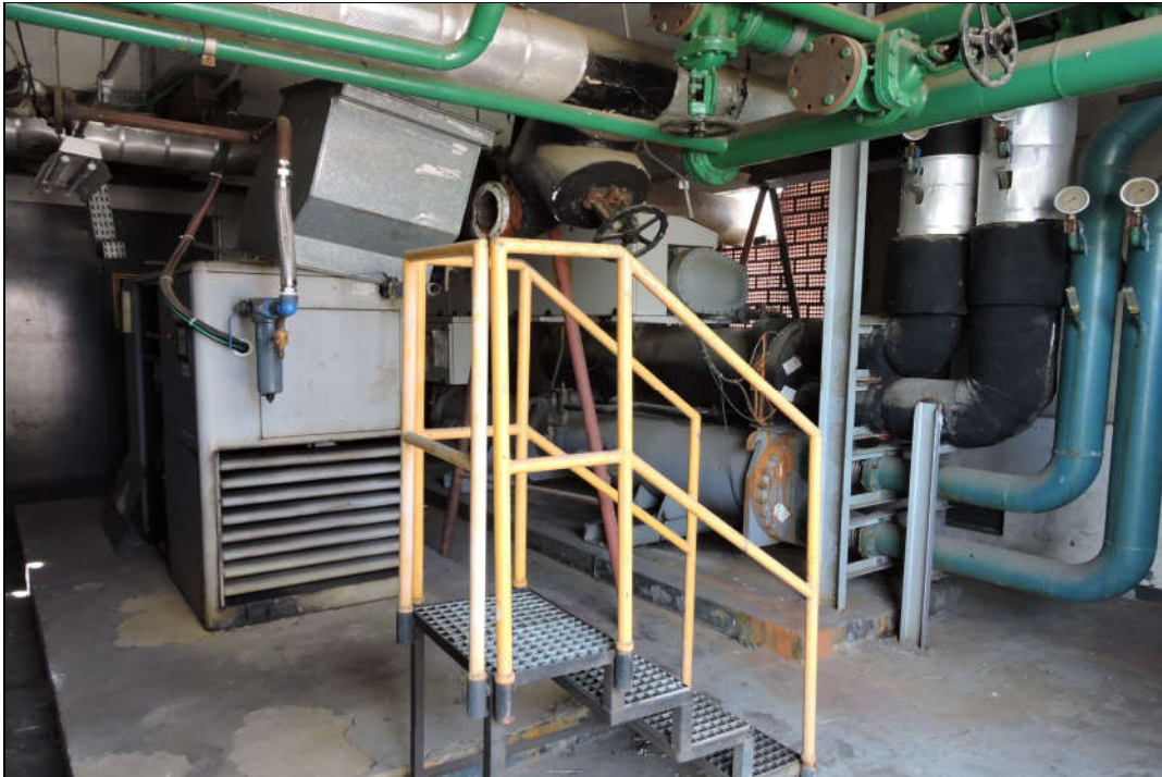
UTILDADES PLANTA NORTE - CHILLER CARRIER
