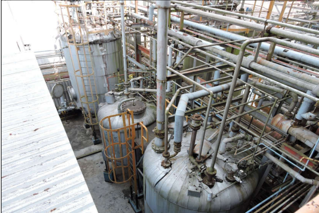
SÍNTESE - JOB SHOP - SEGUNDO PAVIMENTO - VISTA SUPERIOR DOS TANQUES EXTERNOS
