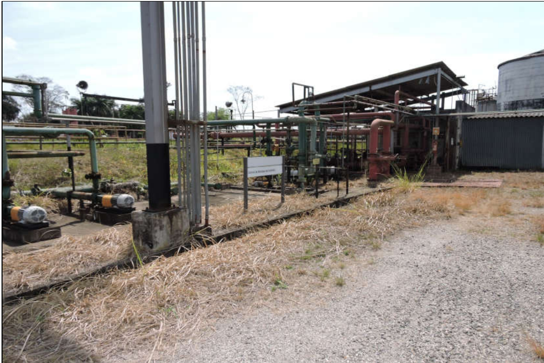
UTILDADES PLANTA NORTE – VISTA GERAL - BOMBAS DE INCENDIO
