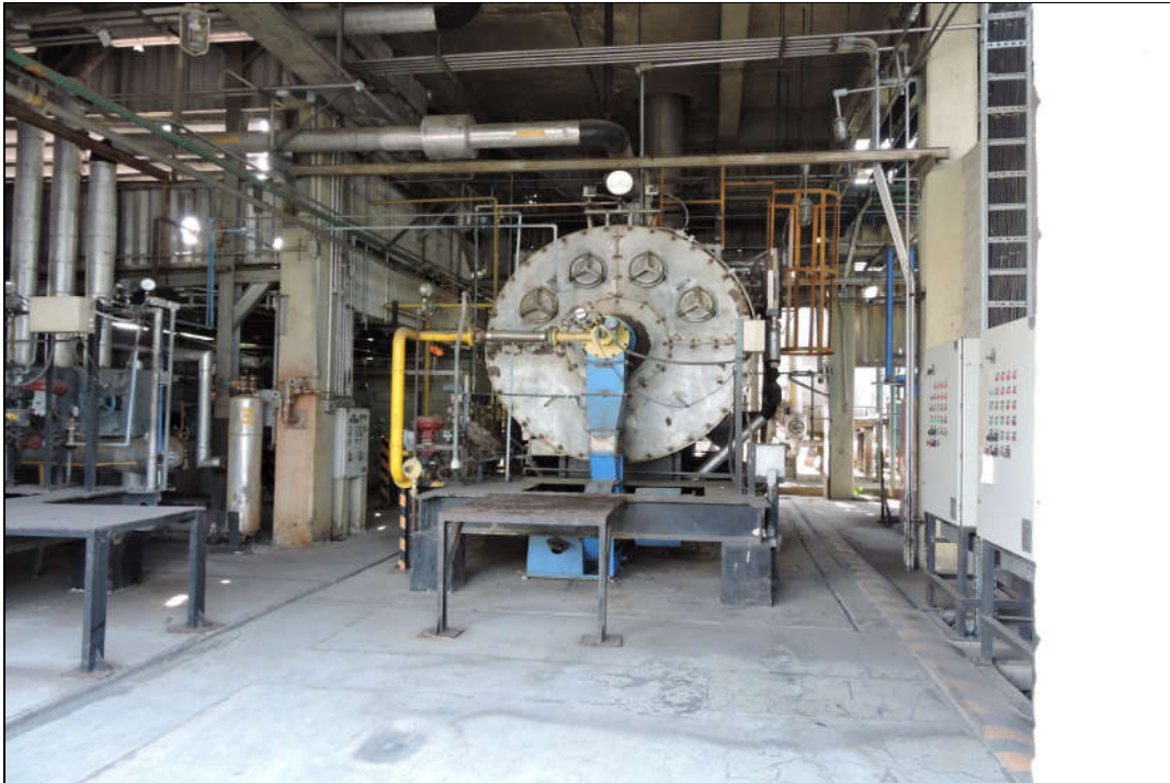
UTILIDADES PLANTA NORTE - VISTA DAS CALDEIRAS
