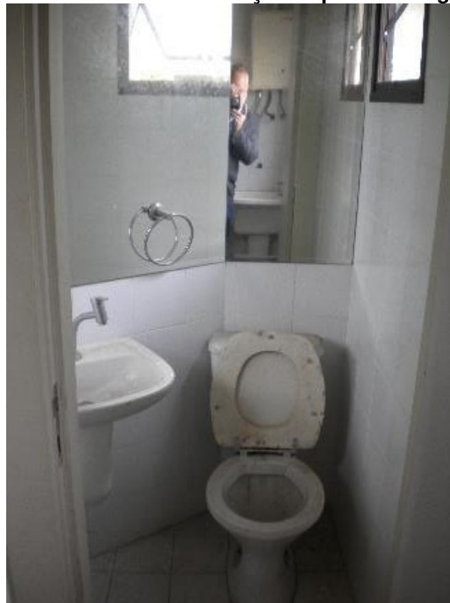
Foto nº 12 – WC de serviço.
