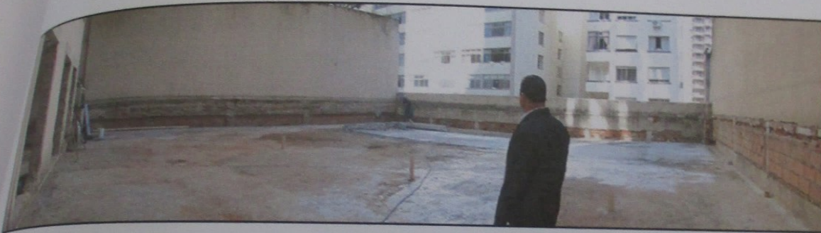
Reprodução fotográfica da área comum ao fundo do condomínio e que se encontra em obras.
