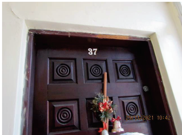
Detalhe descascamento de pintura (teto e parede) acima da porta da entrada
