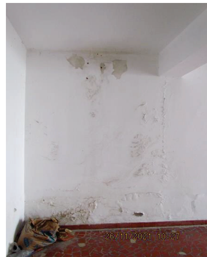
incidência de infiltração na parede confrontante
