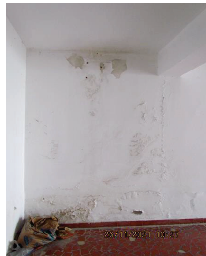
incidência de infiltração na parede confrontante
