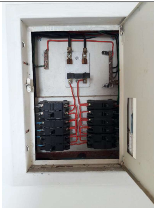
Quadro de Energia localizado na Sala de Estar
