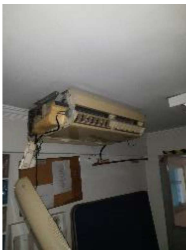
Detalhes Gerais - Ar – Condicionado 9.000 Btus
