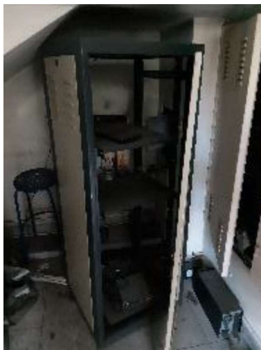
Detalhes Gerais - Rack p/ Servidor
