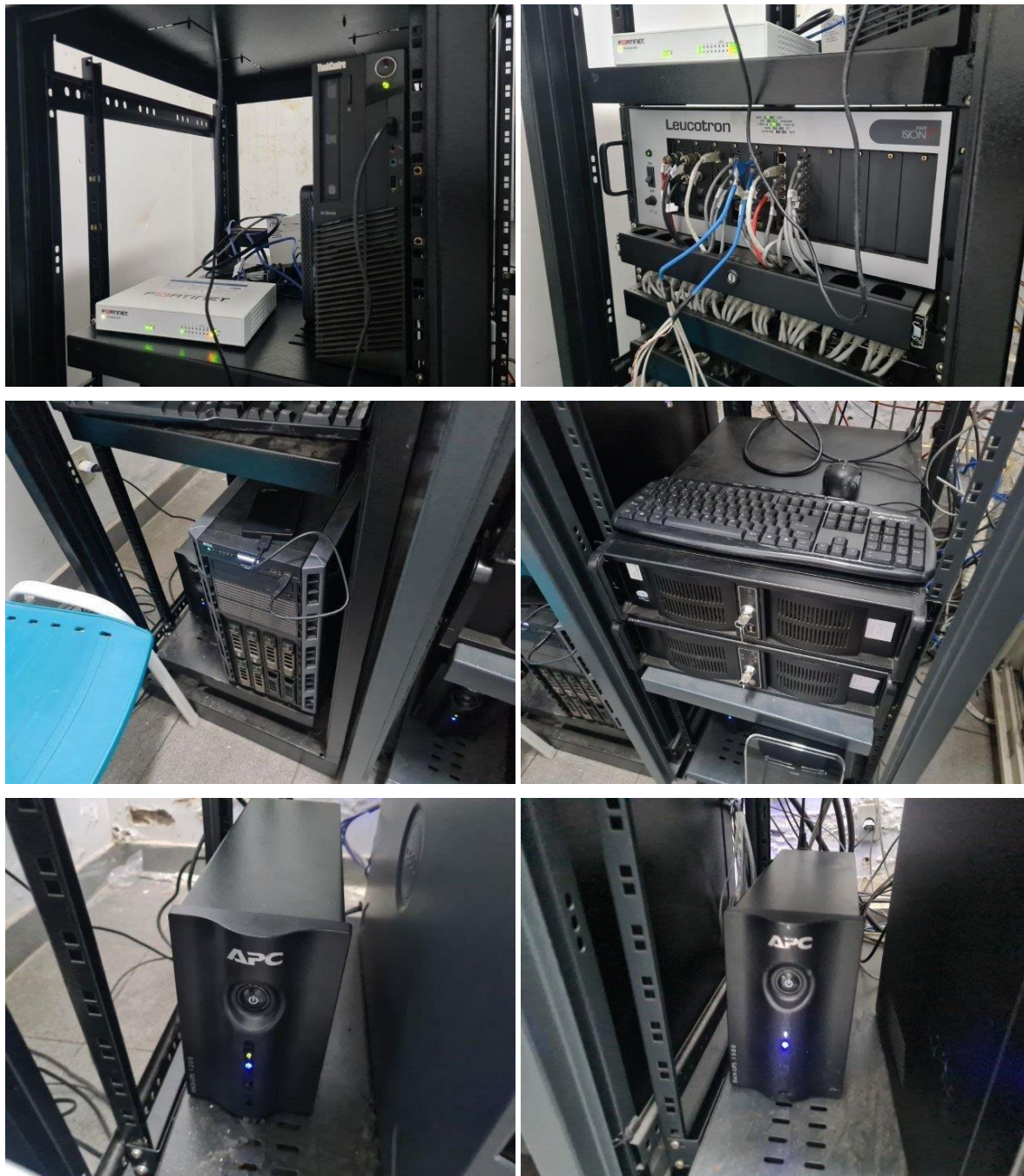
Detalhes Sala de Servidores
