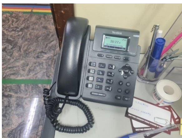
Detalhes Sala de Entrega de Resultados de Exames Ar-condicionado Split – Microcomputador AOC – Telefone IP
