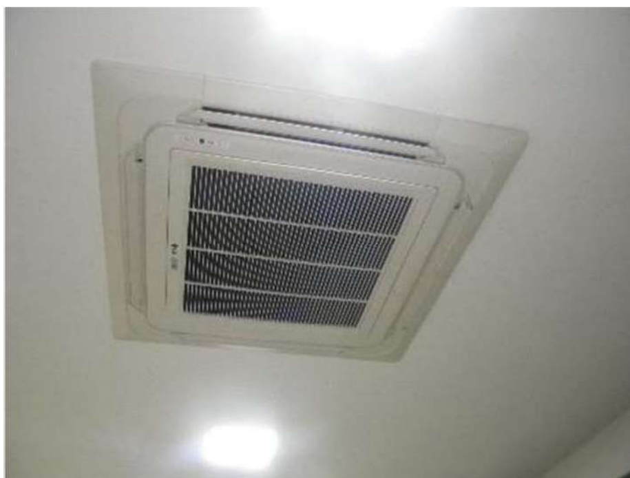
VISTA DO AR CONDICIONADO.
