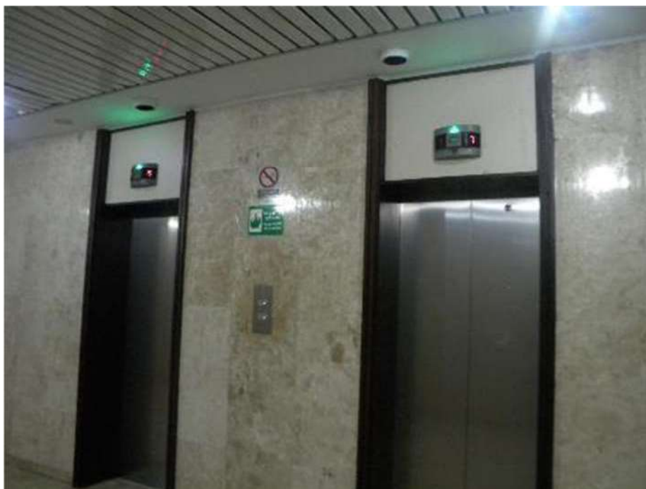
VISTA DOS ELEVADORES SOCIAIS NO 7º ANDAR.
