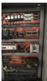
(Fig 03 – Painel de comando principal interno)
