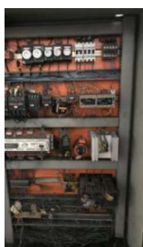
(Fig 03 – Painel de comando principal interno)
