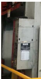
(fig 06 – Painel comando secundário)
