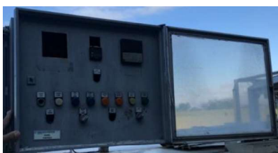
(Fig 04 – Painel de comando principal)
