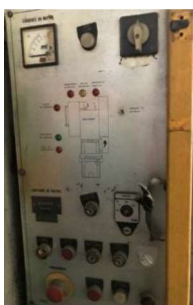
(Fig. 04 – Painel de comando principal externo)
