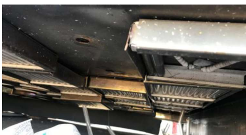
(Fig 07 – Sistema aquecimento danificado)
