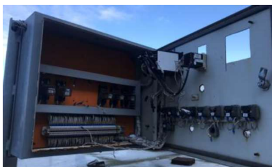
(Fig 05 – Painel de comando principal interno)
