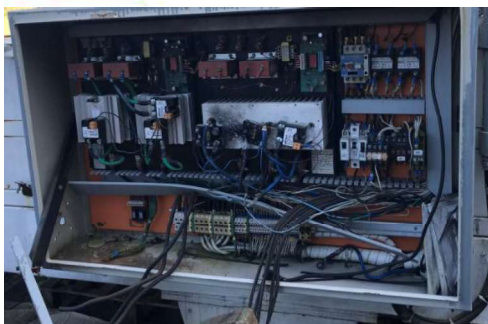
(Fig. 06 – Painel de comando principal externo)
