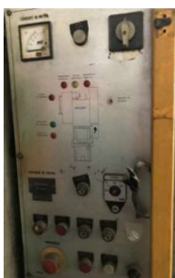
(Fig. 04 – Painel de comando principal externo)
