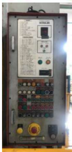
(Fig. 02 – Painel de comando principal)
