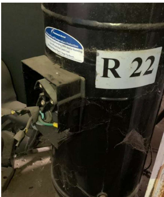
(Fig. 05 – Motor Compressor Geladeira)
