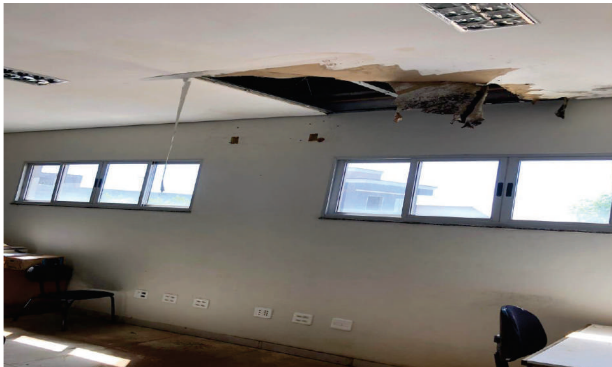
Foto 10 – Está sala necessita arrumar o forro.
