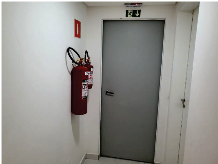
FOTO 23 –PORTA CORTA FOGO
