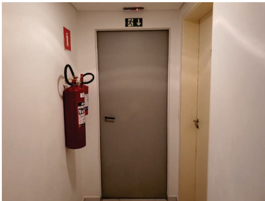
FOTO 19 – PORTA CORTA FOGO
