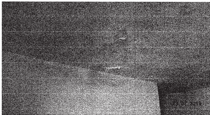
Foto 30 – Vista da deterioração da laje devido infiltração de água.
