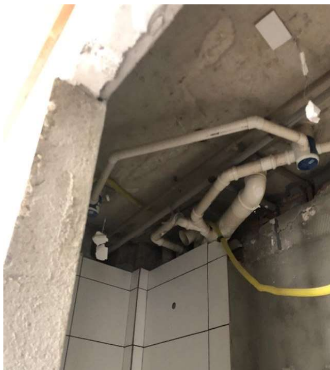
TUBULAÇÕES DE ESGOTO
