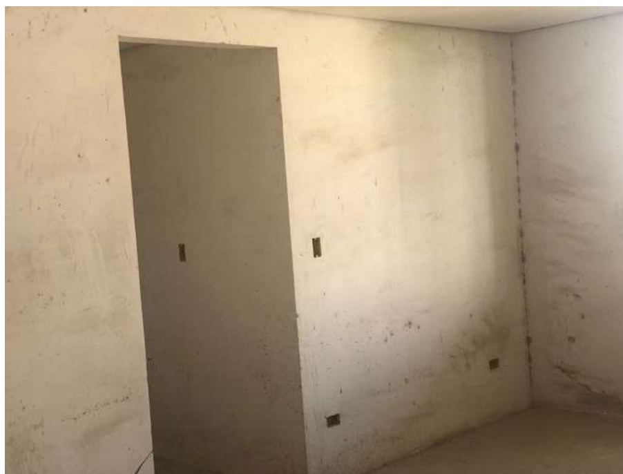
ASPECTOS DAS UNIDADES AVALIANDAS – PAREDES REVESTIDAS E SEM ACABAMANETOS
