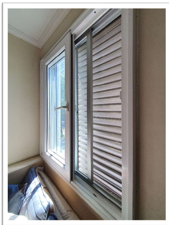
FOTO 12 – Detalhe esquadria de isolamento acústico
