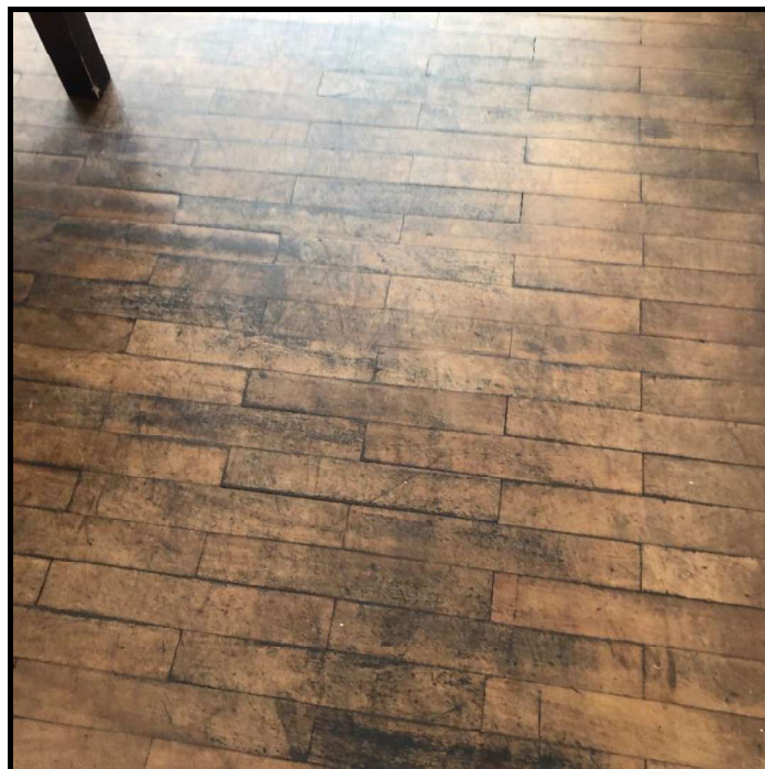
Foto 14: Piso de madeira (tacaõ), em péssimo estado de conservação
