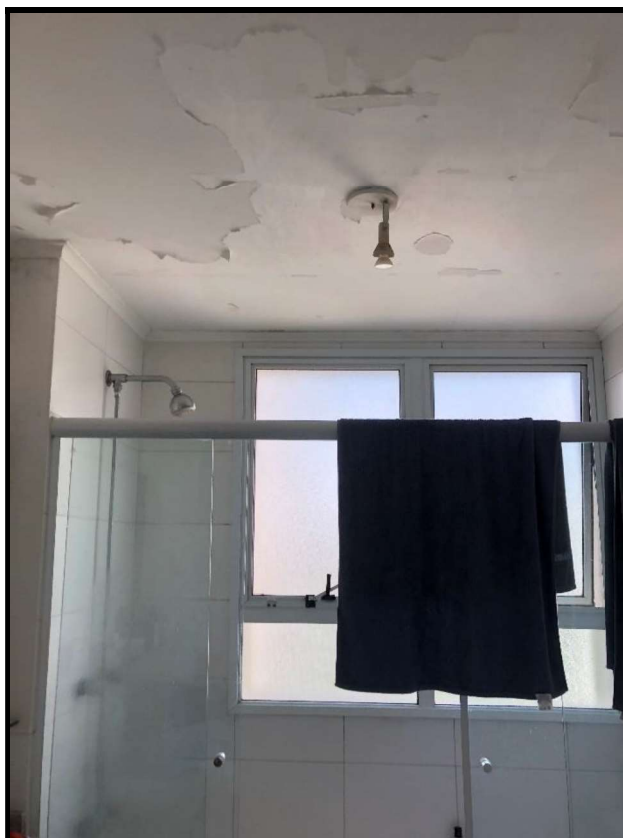
Foto 25: Estado de conservação do teto do banheiro (suíte principal)
