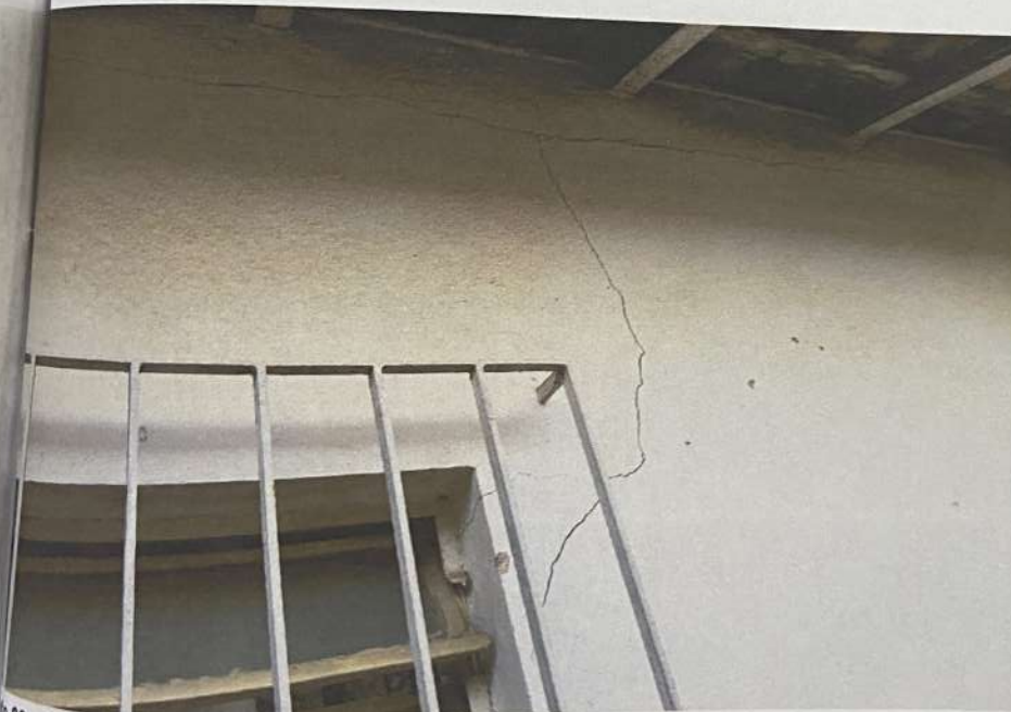
Fig. 22 - Trincas na parede externa junto ao corredor lateral
