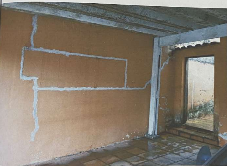
26 - Trincas reparadas na parede de divisa da garagem com o imóvel n° 178
