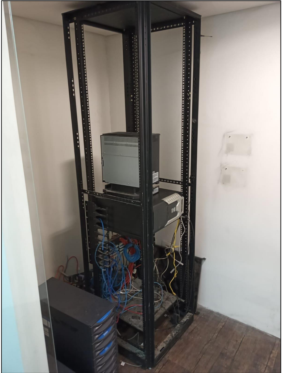
ITEM 2,009 - RACK DE TI ALTO
