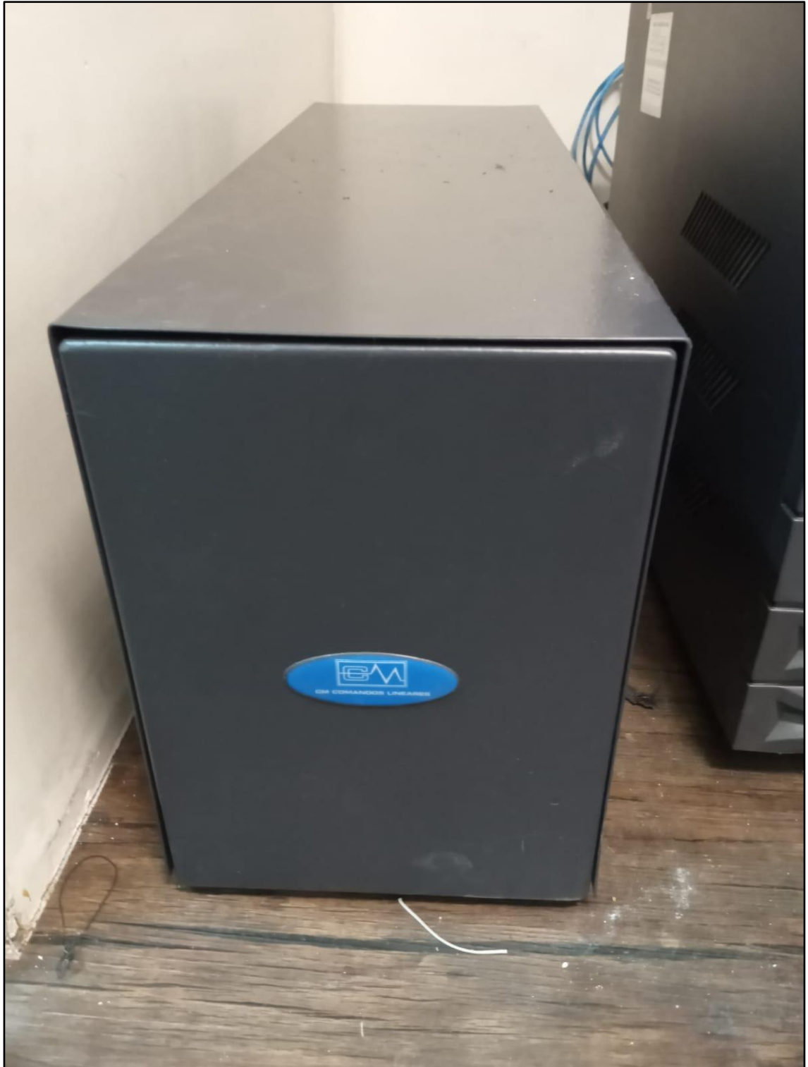
ITEM 2,006 - NOBREAK COM BANCO DE BATERIAS CM COMANDOS
