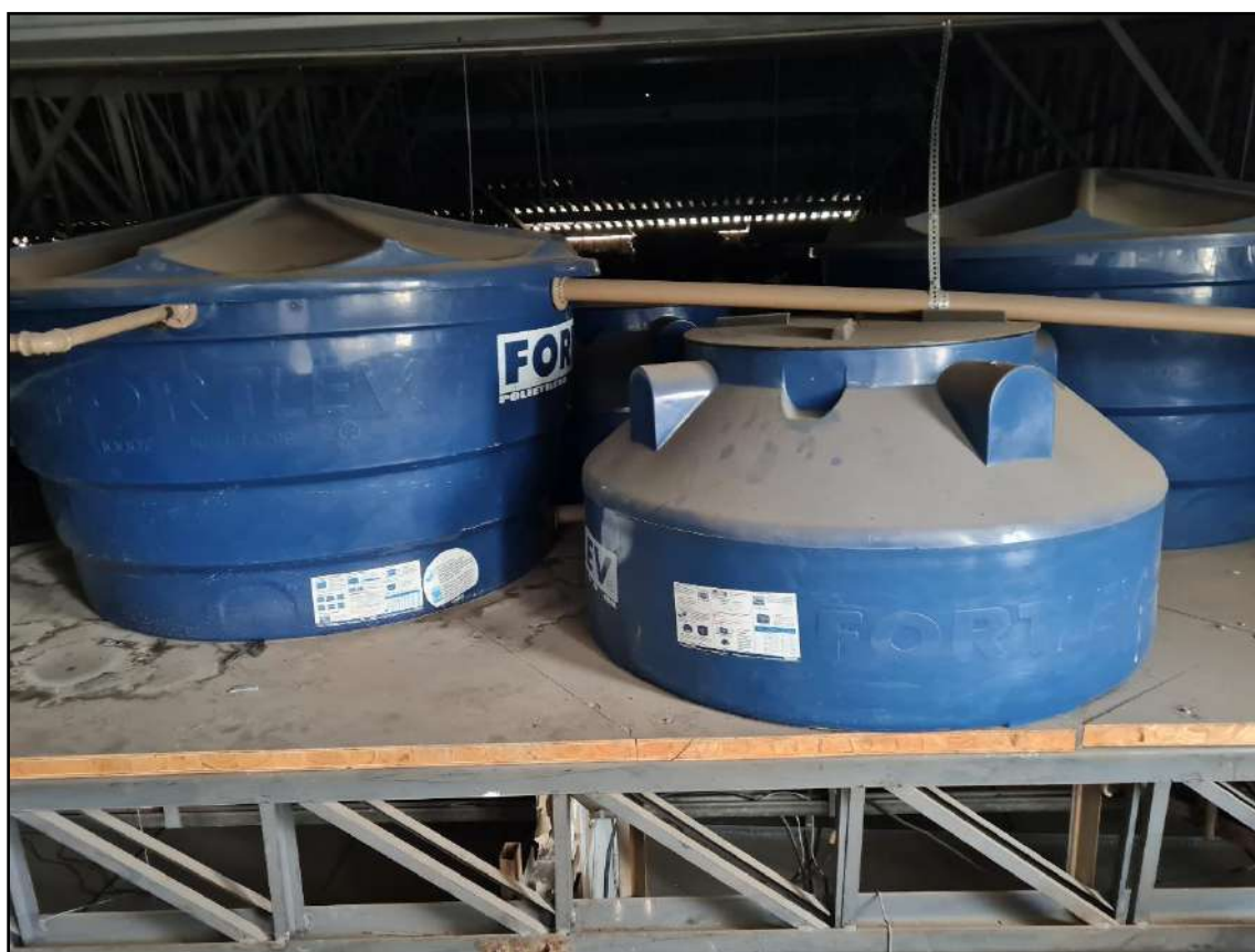
ITEM 0262 - CAIXAS D'ÁGUA
