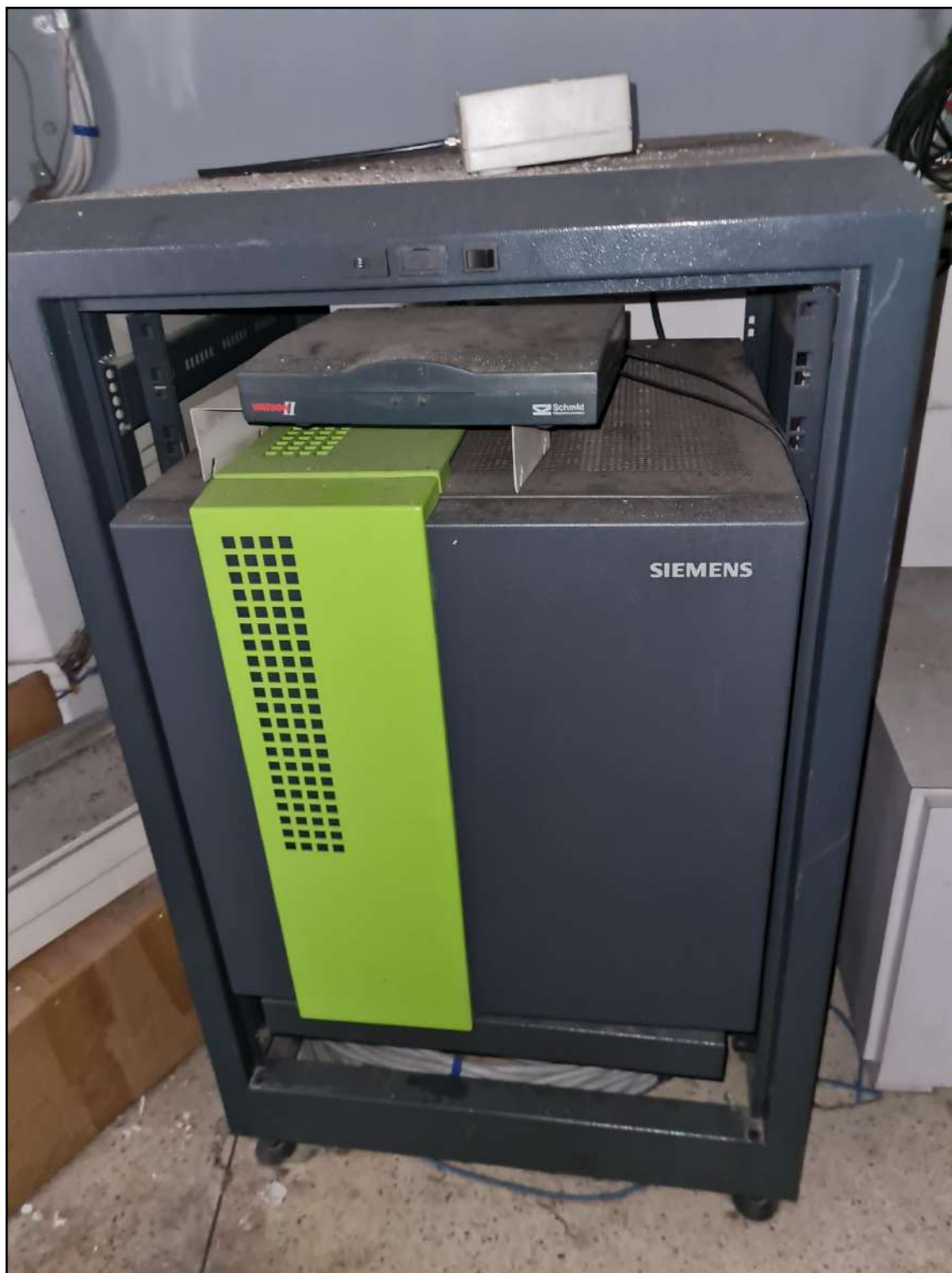
ITEM 0247 - SERVIDOR PARA DISTRIBUIÇÃO DE CABOS TELEFÔNICOS
