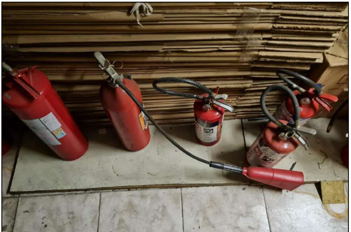
ITEM 0163 E 0165- EXTINTORES DE INCÊNDIO PEQUENOS E EMBALAGENS E CAIXAS DE PAPELÃO
