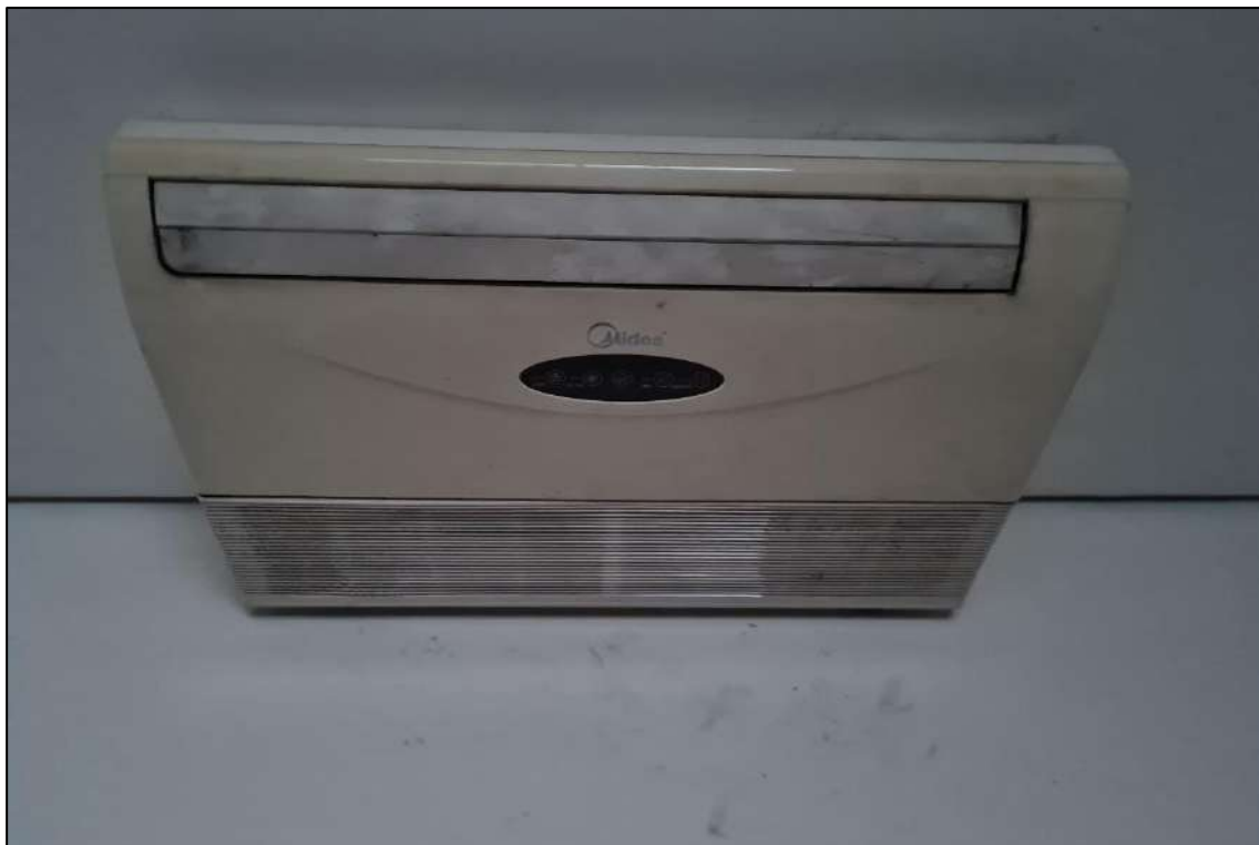
ITEM 0131 - AR-CONDICIONADO SPLIT – MIDEA
