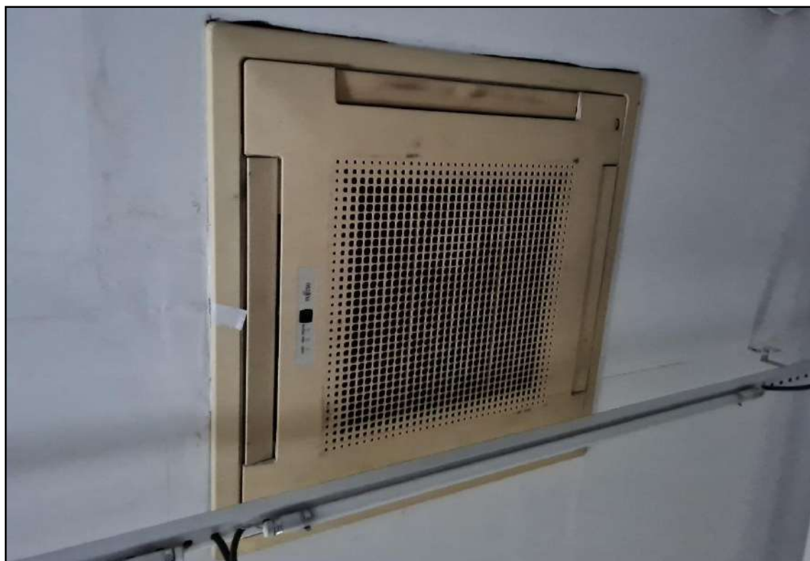
ITEM 0099 - AR-CONDICIONADO DE TETO - FUJITSU
