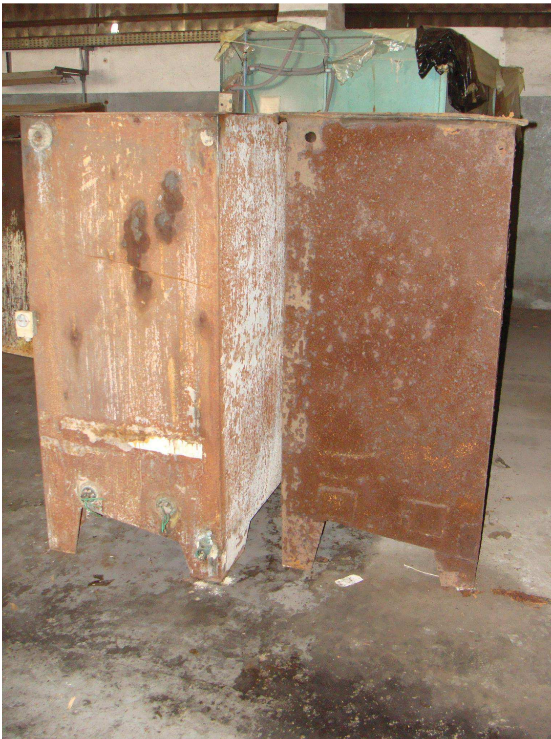
TANQUES P/ TRATAMENTO SUPERFÍCIE
