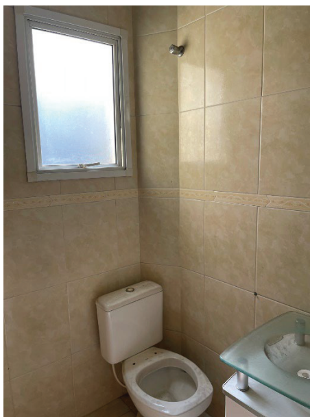
Foto 10 – Banheiro social – Apartamento 31 – 3º Pavimento – Avaliando
