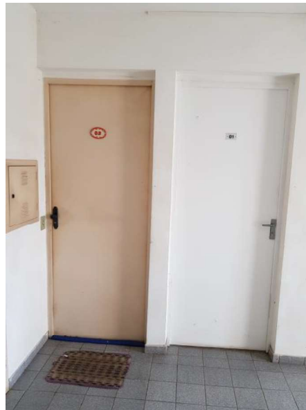
FOTO N° 03 Vista parcial da entrada do apartamento 01 do Edifício Trancoso
