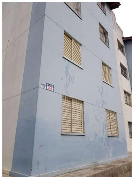
FOTO Nº 2 Vista parcial da lateral do Edifício Trancoso
