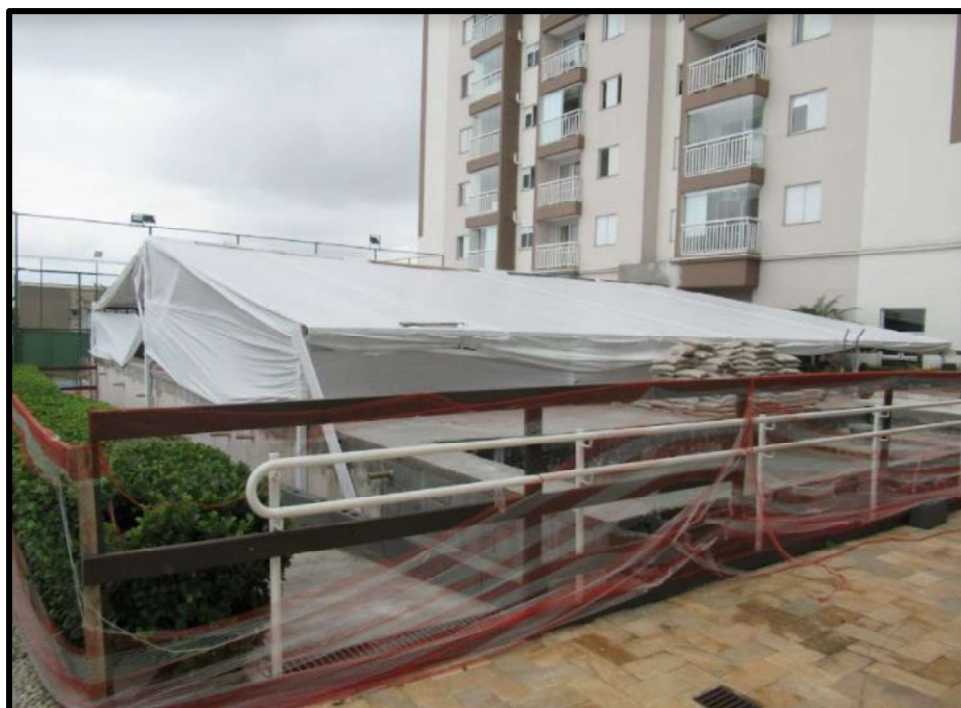
Foto 12: Piscina - em manutenção
