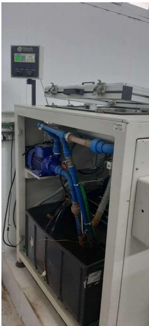
TESTADOR DE ÁGUA
