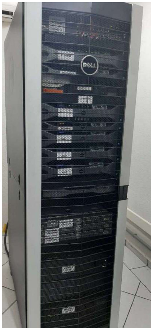
DIVERSOS SERVIDORES – DATACENTER
