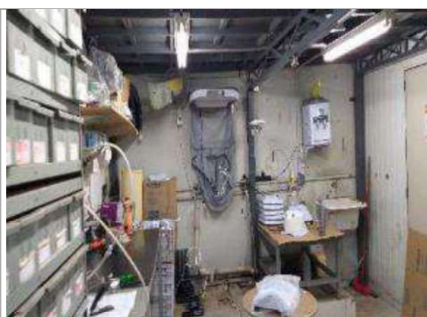
Sala de maquinas 2
