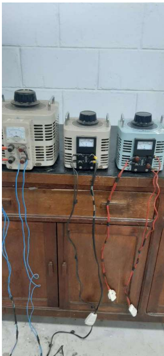
REGULADORES DE VOLTAGEM
