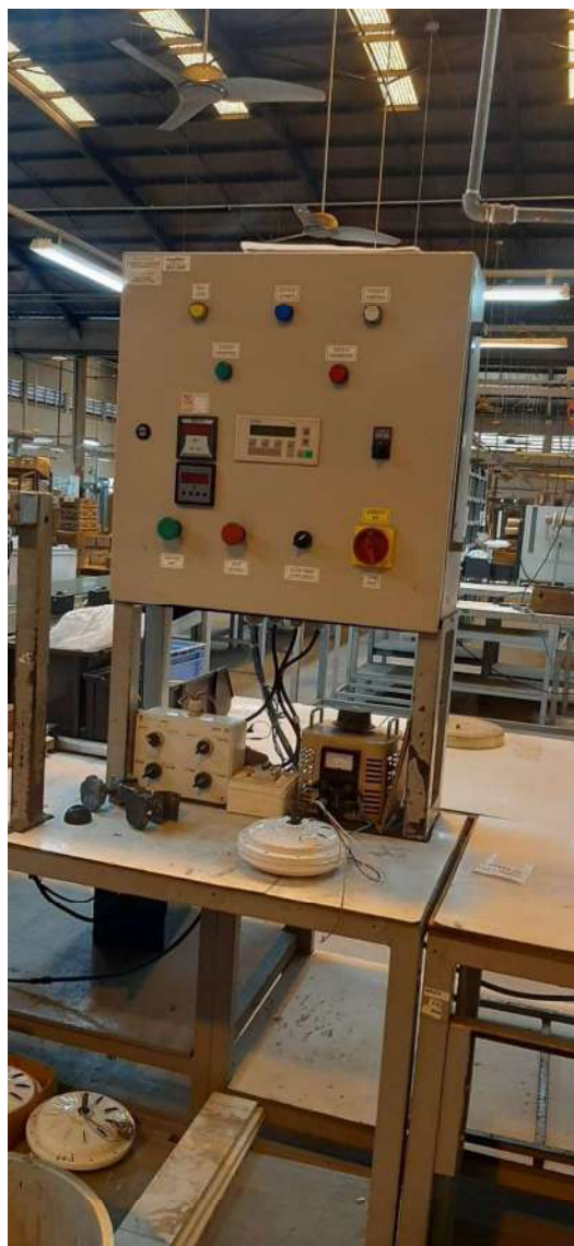
PAINEL ELETRICO COM BANCADA
