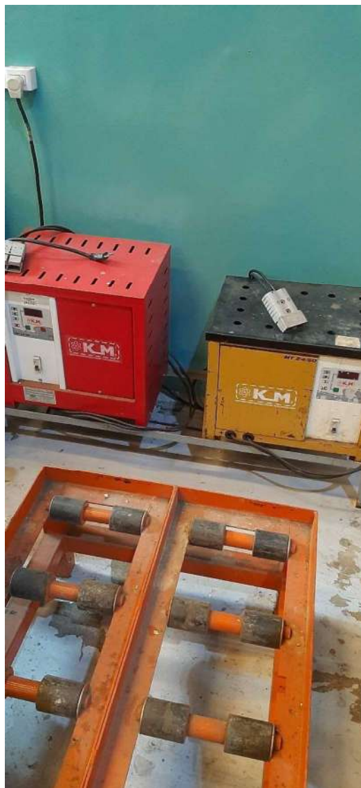
CARREGADOR DE BATERIA
