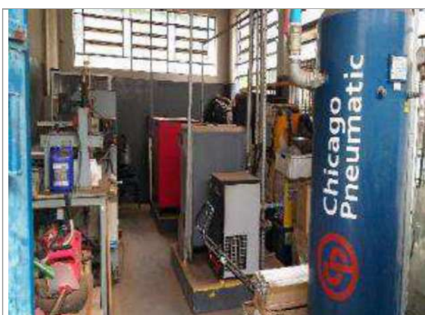
Sala de maquinas 1
