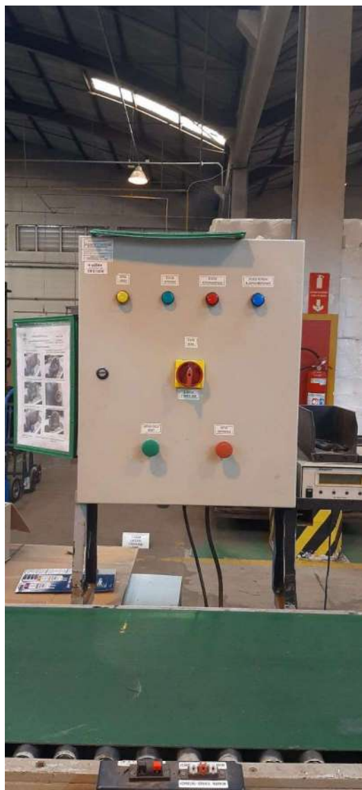
PAINEL ELETRICO DA ESTEIRA
