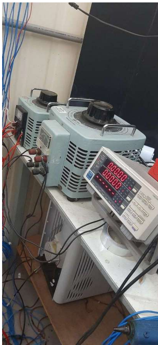
REGULADORES DE VOLTAGEM
