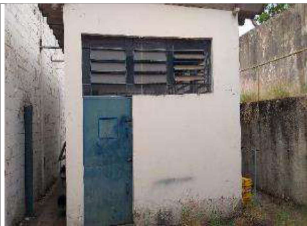
Casa de maquinas 01
