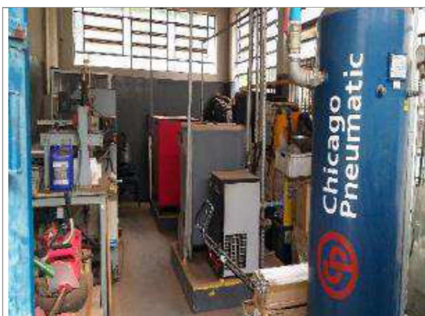
Sala de maquinas 1
