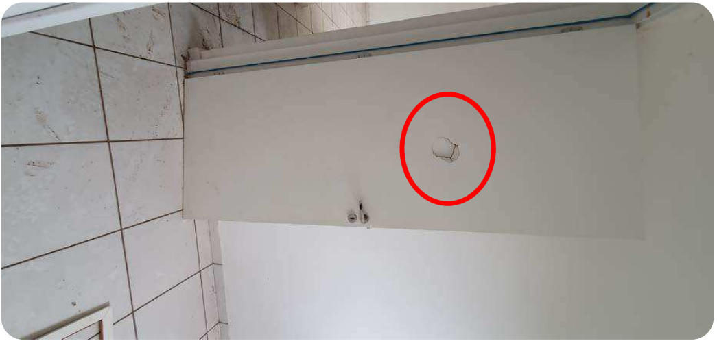
Detalhe da danificação na porta do dormitório
