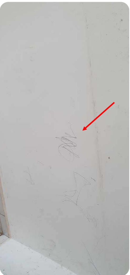
Detalhe da pintura necessitando de reparos
