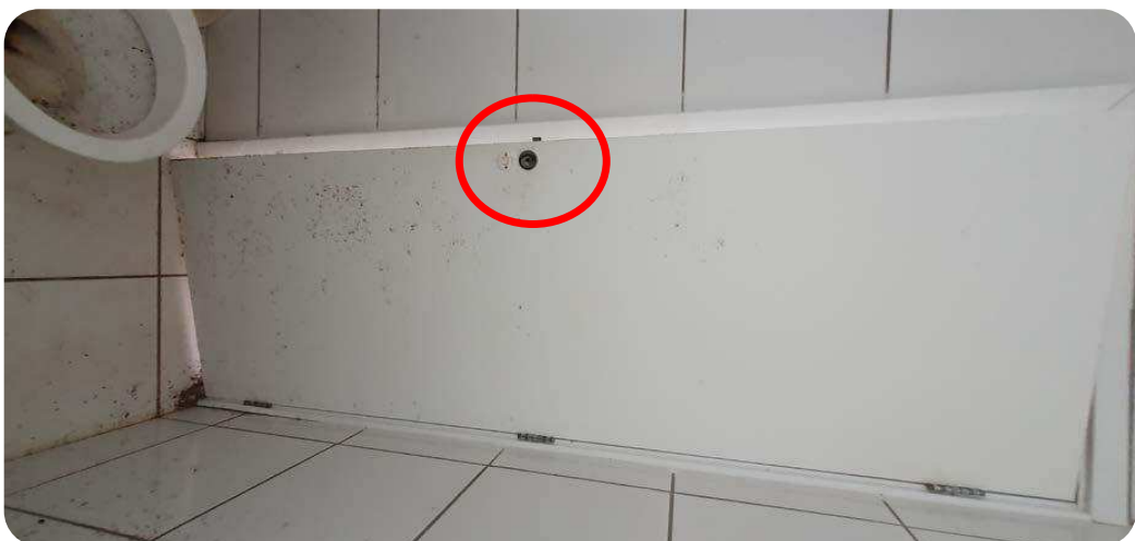
Detalhe da ausência de maçaneta
