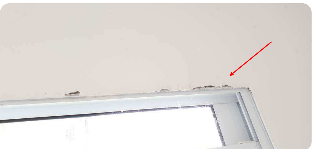
Detalhe da parede necessitando de reparos
