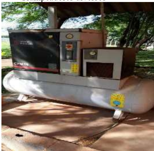
Compressor de ar
