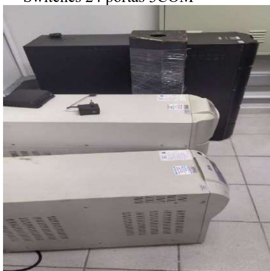
No break com banco de baterias
