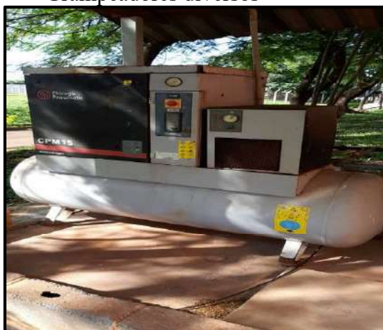
Compressor de ar
