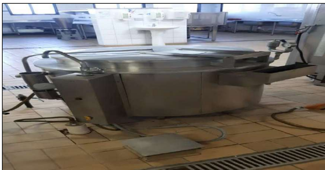
Caldeira a gás em inox – N° bem: 10599
