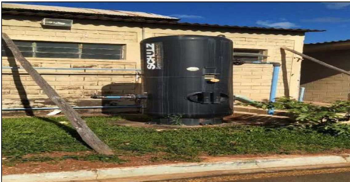
Separador de condensado – Nº bem: 50766
