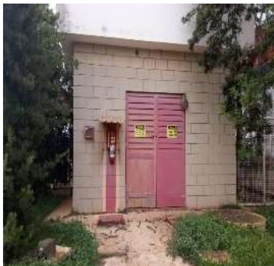
Cabine de força próxima ao prédio 03
