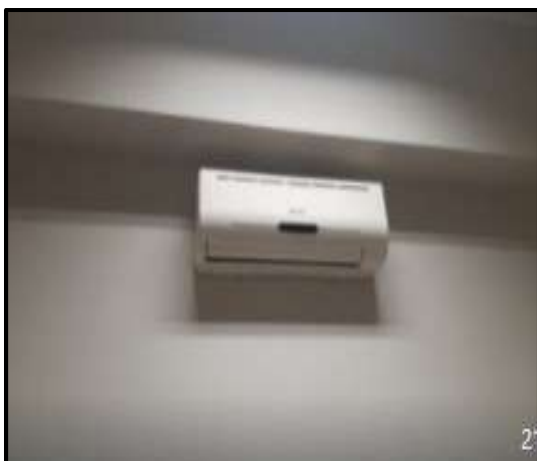
Condicionador de ar split Springer
