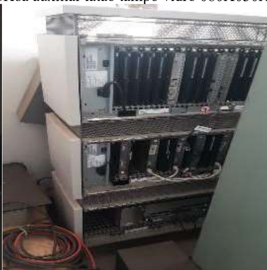
Central telefônica Siemens
