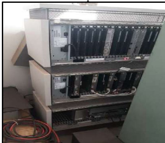
Central telefônica Siemens
