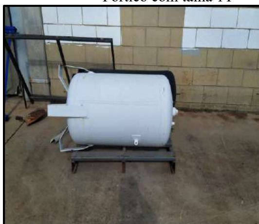
Tanque de gás
