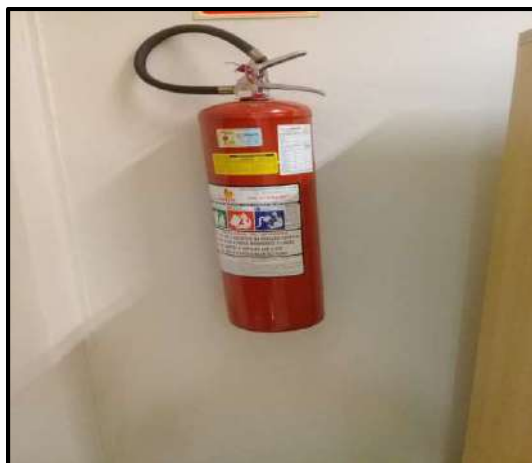
Extintor de incêndio
