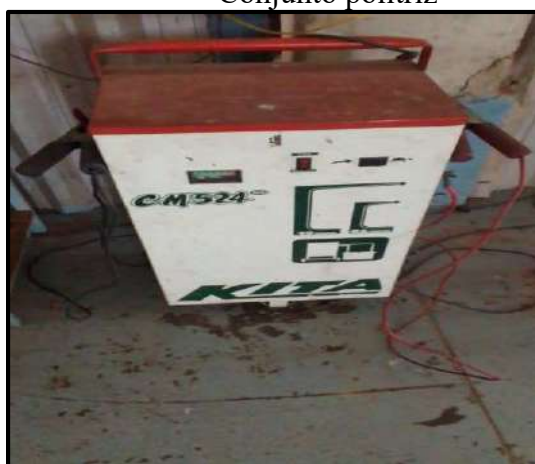
Carregador de bateria
