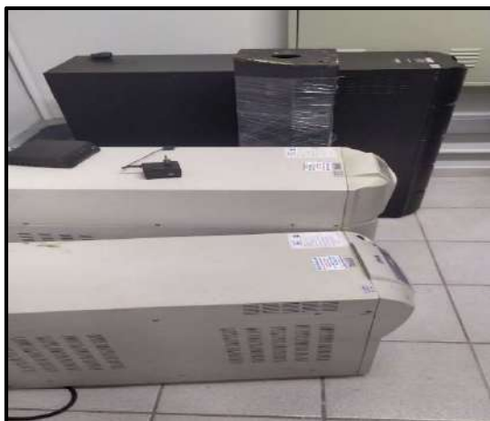
No break com banco de baterias
