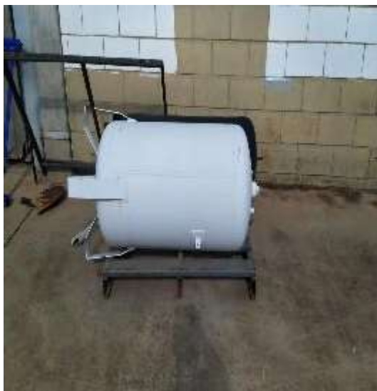
Tanque de gás
