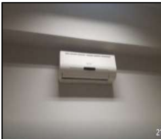
Condicionador de ar split Springer
