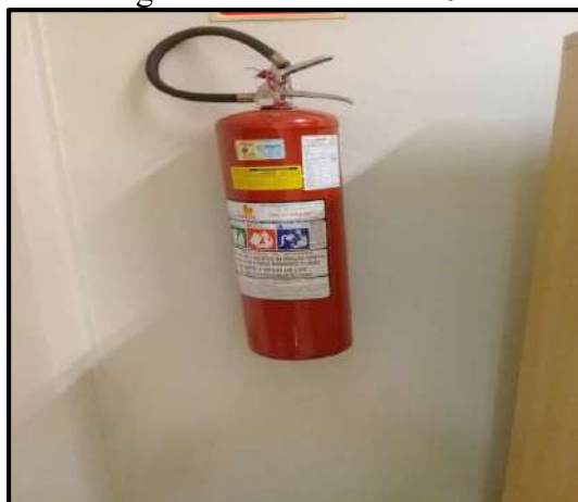
Extintor de incêndio
