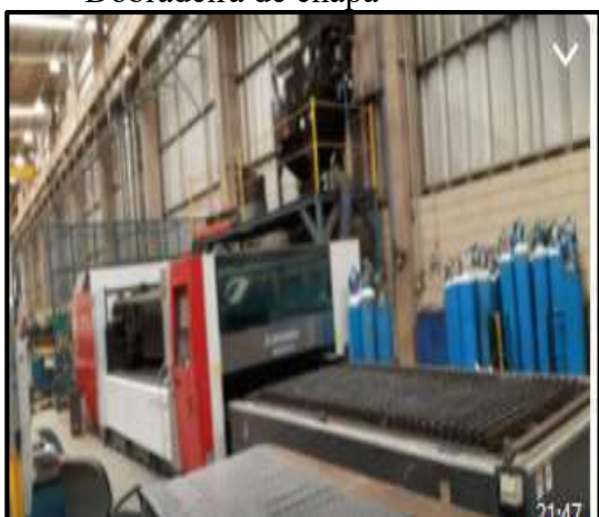
Cortadora de chapa a laser Mitsubishi
