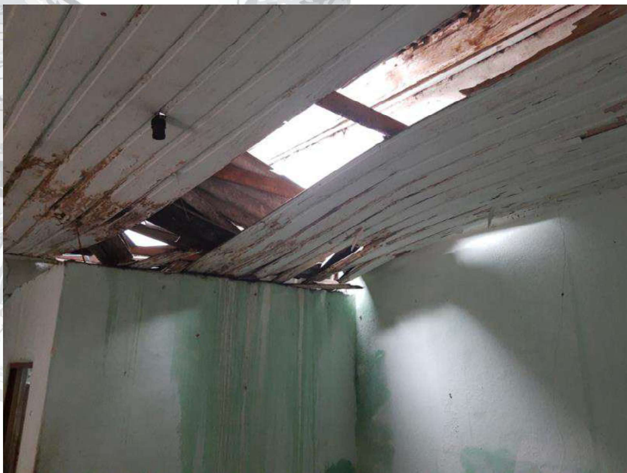
FOTO FORRO COZINHA FUNDOS
