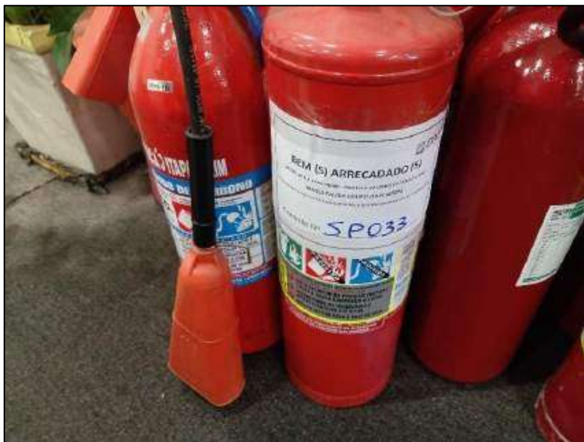
ITEM 0032 - EXTINTOR COM SUPORTE COD: SP033
