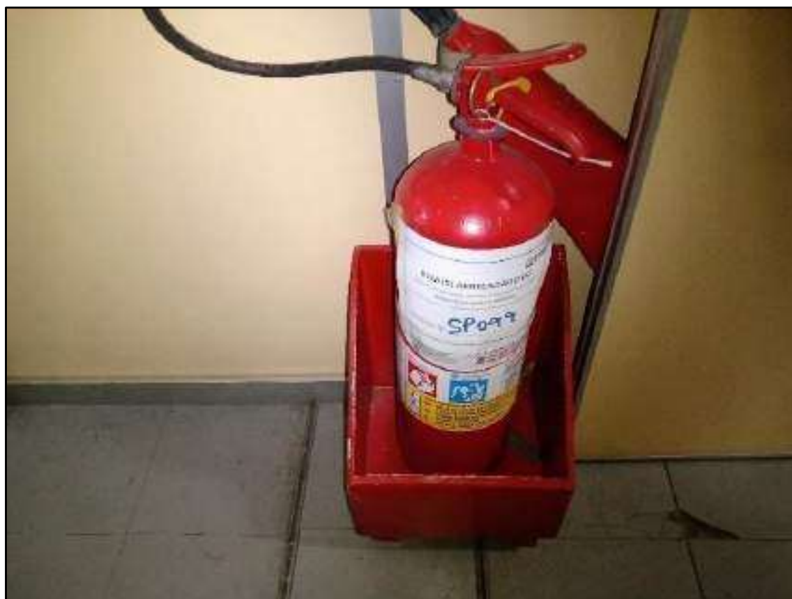
ITEM 0097 - EXTINTOR COM SUPORTE COD: SP099
