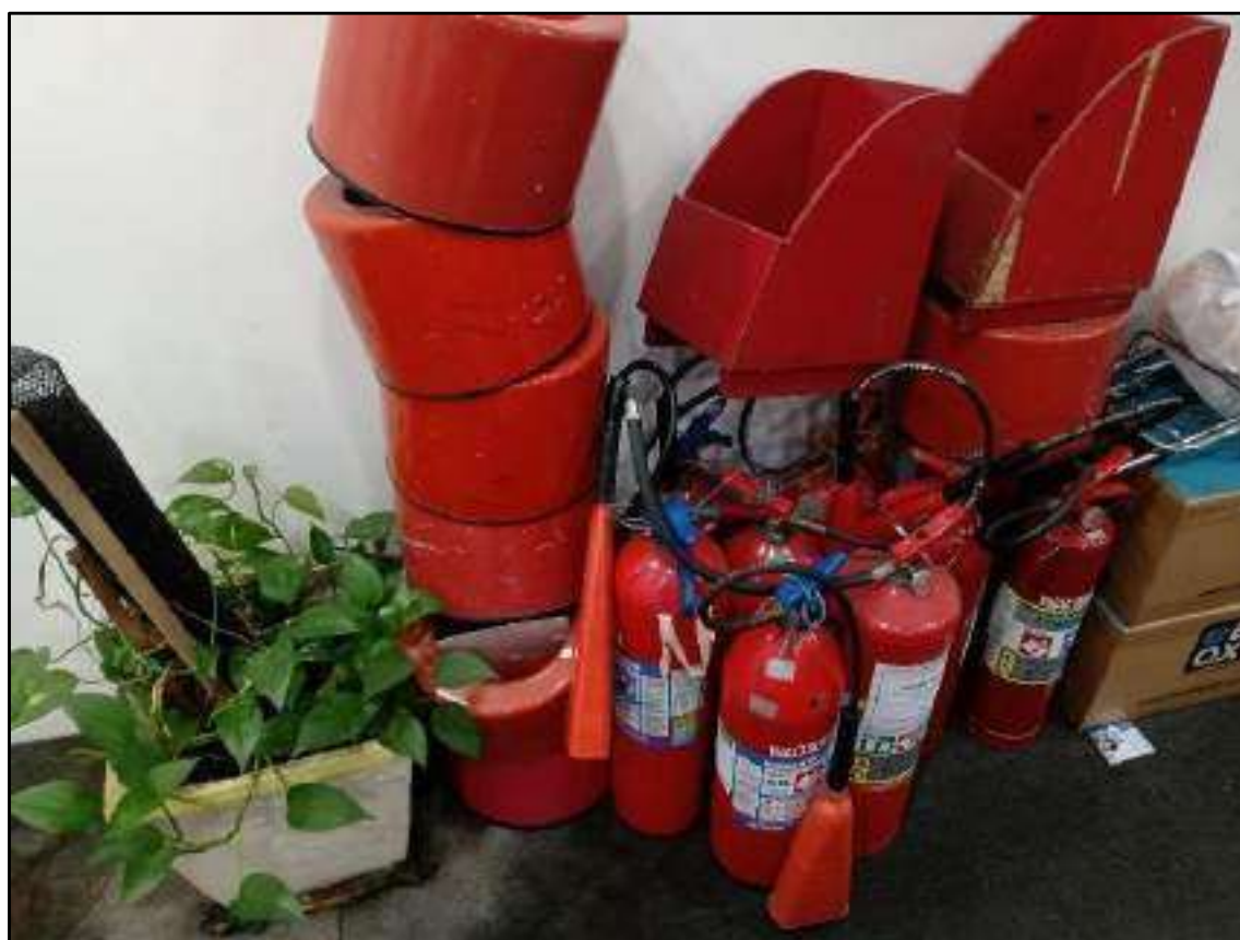
ITEM 0032 - EXTINTOR COM SUPORTE COD: SP033
