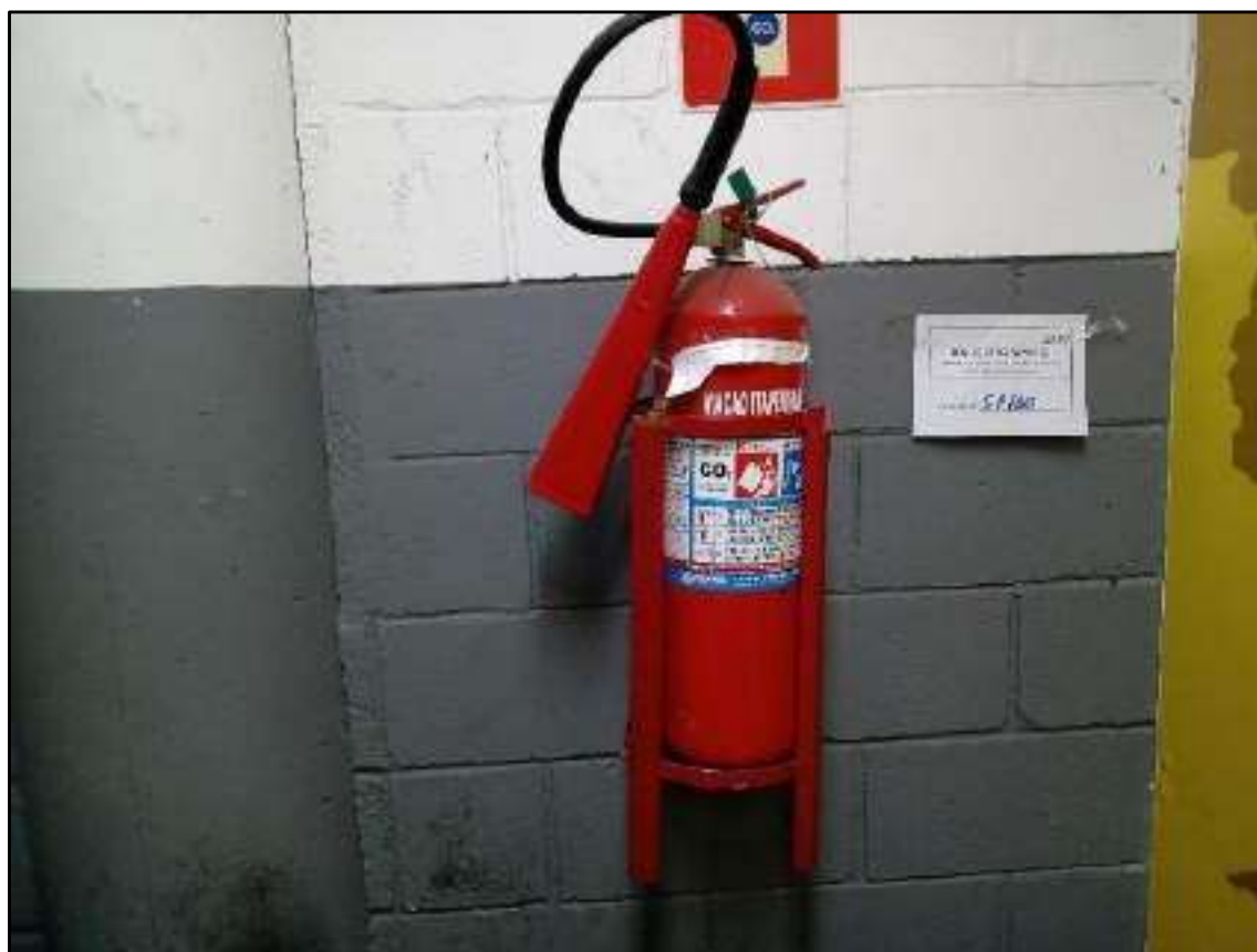
ITEM 0111 - EXTINTOR DE PAREDE COD: SP100
