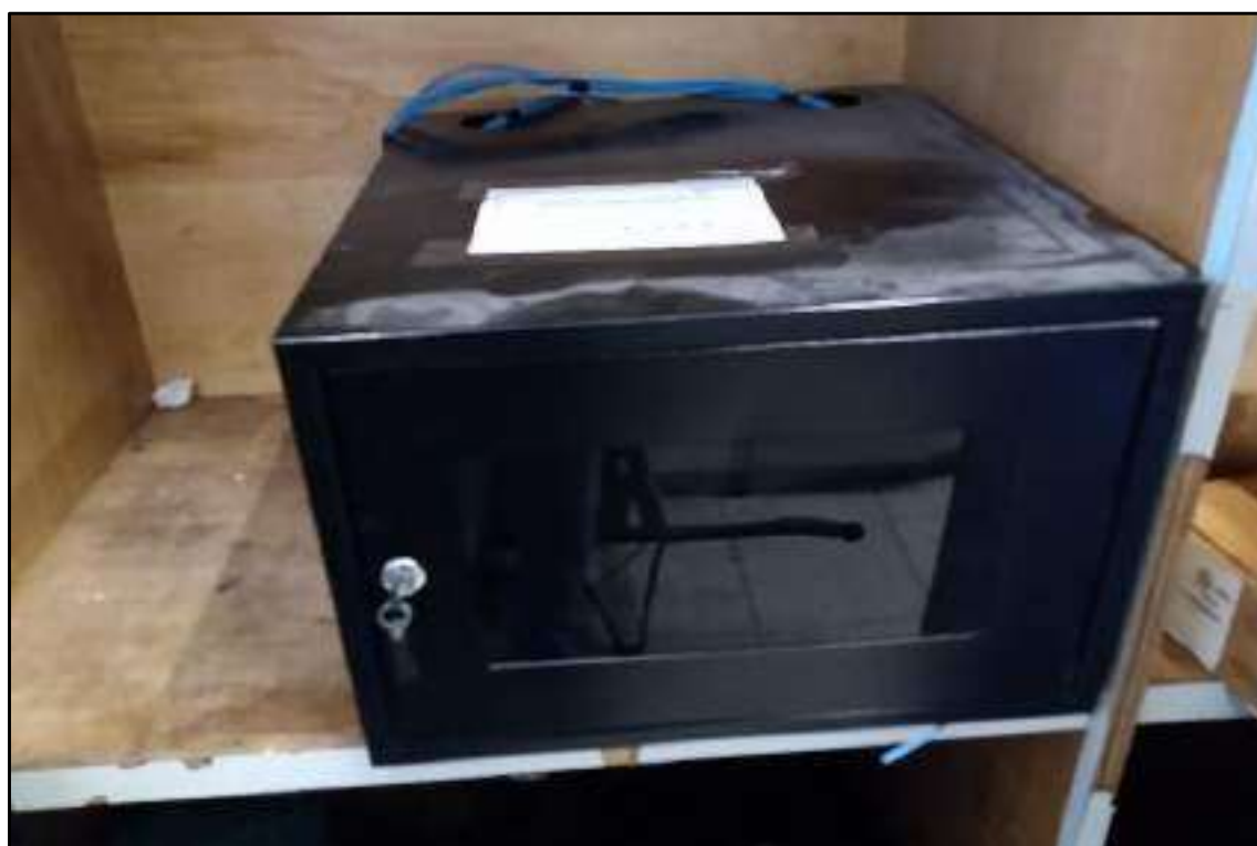
ITEM 0059 - RACK ORGANIZADOR DE PAREDE COM 1 SWITCH E 1 DISTRIBUIDOR DE FIBRA OPTICA COD: SP061
