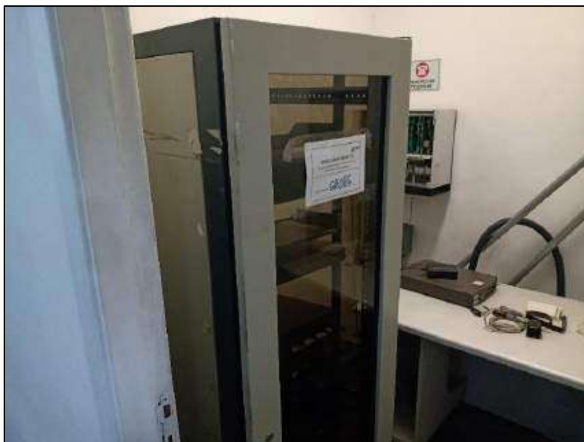
ITEM 0084 - RACK ORGANIZADOR COM 1 SWITCH E 3 DISTRIBUIDOR DE FIBRA OPTICA COD: SP086
