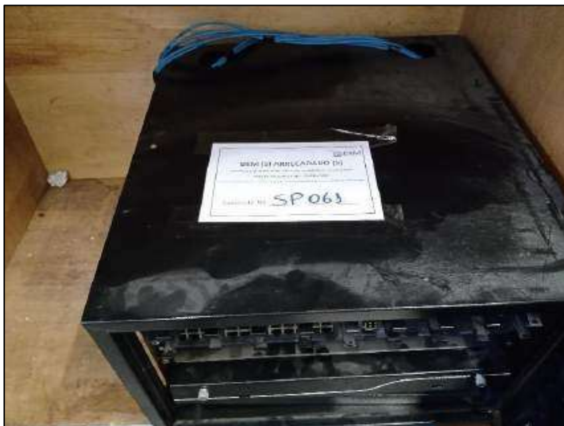
ITEM 0059 - RACK ORGANIZADOR DE PAREDE COM 1 SWITCH E 1 DISTRIBUIDOR DE FIBRA OPTICA COD: SP061
