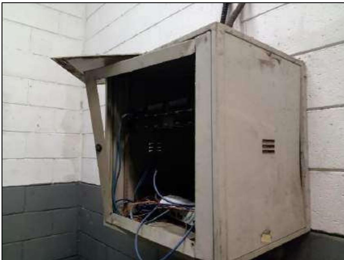
ITEM 0104 - RACK COM SWITCH COD: SP100
