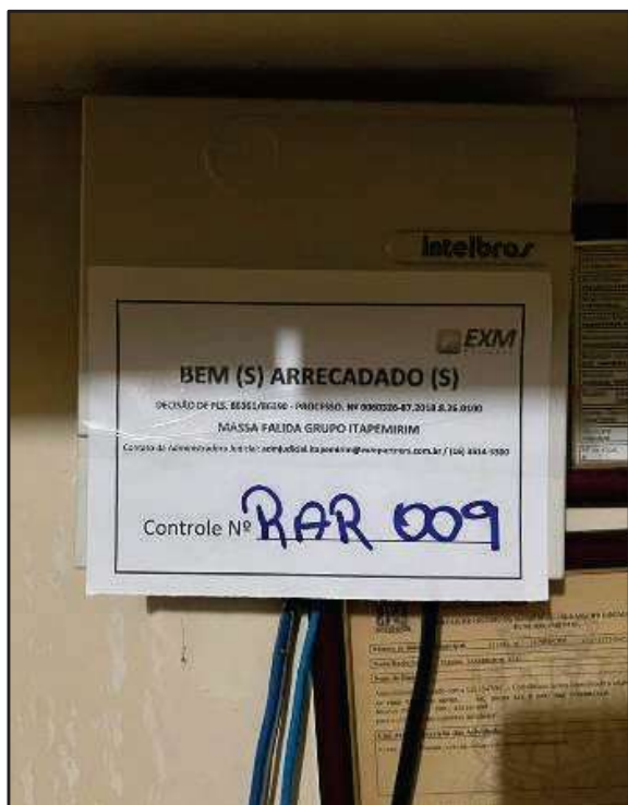
ITEM 0404 - CENTRAL TELEFONICA INTELBRAS COD.:RAR09
