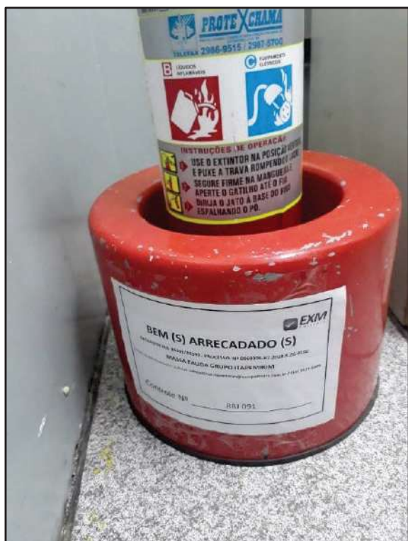
ITEM 0272 - EXTINTOR COD.:RRJ091
