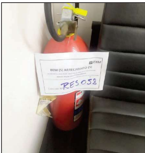
ITEM 0141 - EXTINTOR DE INCENDIO COD.:RES058
