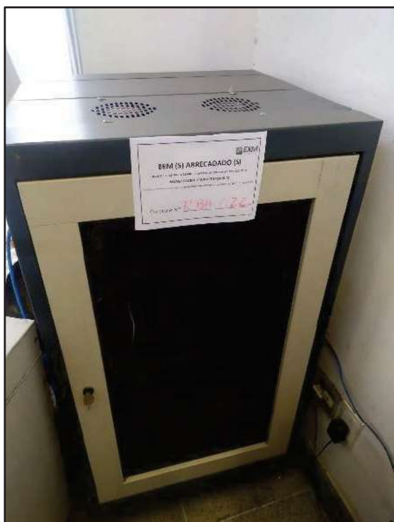
ITEM 0022 - RACK ORGANIZADOR COM 1 SWITCH E 1 DISTRIBUIDOR DE FIBRA OPTICA COD.:RBH022
