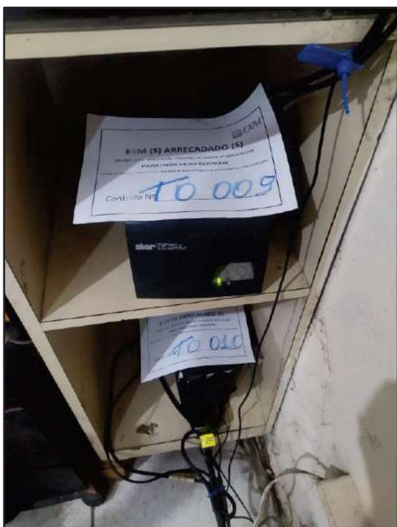
ITEM 0296 E ITEM 0297 - IMPRESSORA COD.:TO009 E ESTABILIZADOR COD: TO010
