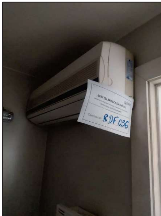
ITEM 0073 - AR CONDICIONADO SPLIT 9000 BTUS/H LG COD.:RDF036
