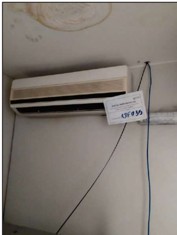
ITEM 0072 - AR CONDICIONADO SPLIT 9000 BTUS/H LG COD.:RDF035
