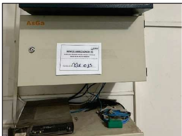
ITEM 0370 - GABINETE DE TELEFONIA COD.:RRE015
