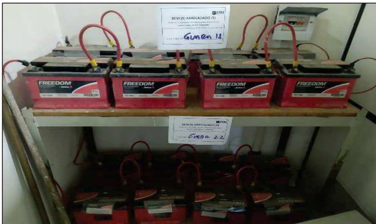
ITEM 0177 - BATERIAS ESTACIONARIAS FREEDOM COD.:GUARA18 E ITEM 0178 - BANCADA COD.:GUARA19
