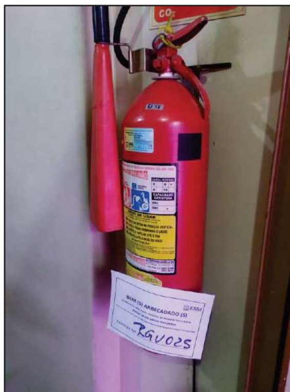
ITEM 0436 - EXTINTOR DE INCÊNDIO COD.:RGV25
