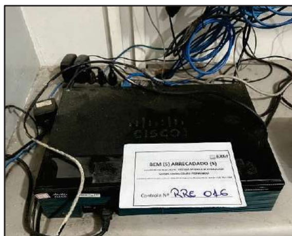
ITEM 0371 - SERVIDOR DE TELEFONIA FIBRA OTICA CISCO COD.:RRE016
