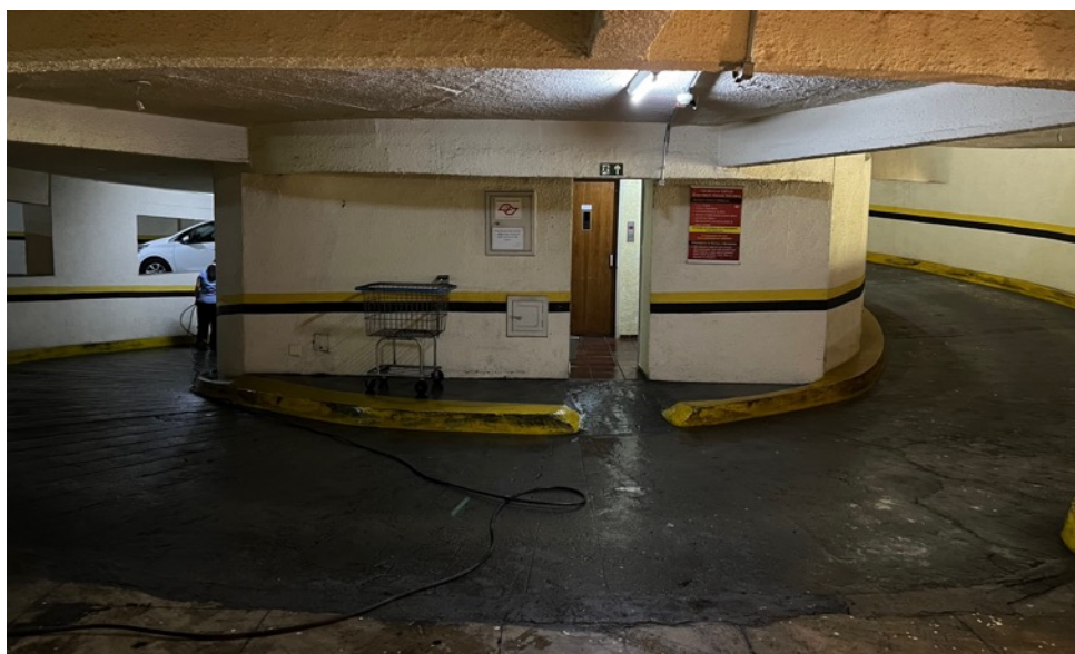
Imagem 08: Rampas circulares para entrada e saída de veículos nos pavimentos de garagem, com ambiente de elevadores, escadaria e coleta de lixo ao centro
