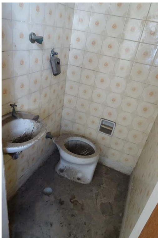
Banheiro de empregada em péssimo estado.
