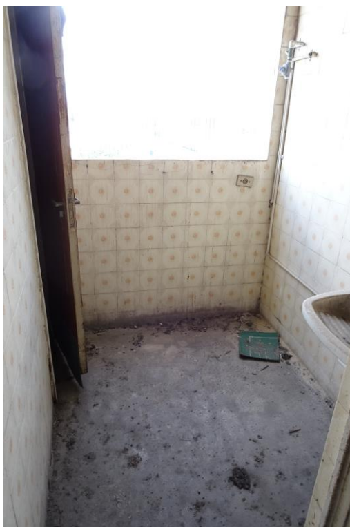
Área de serviço em péssimo estado.
