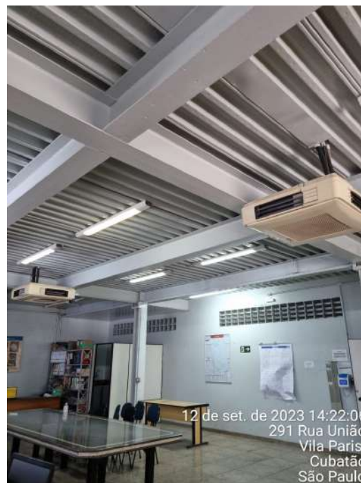
Imagem 39: Central de Ar Condicionado
