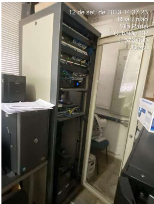
Imagem 30: Servidor Central de Rede
