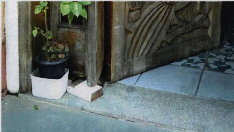
DETALHE DA PARTE INFERIOR PORTA DE ENTRADA, DANIFICADA.
