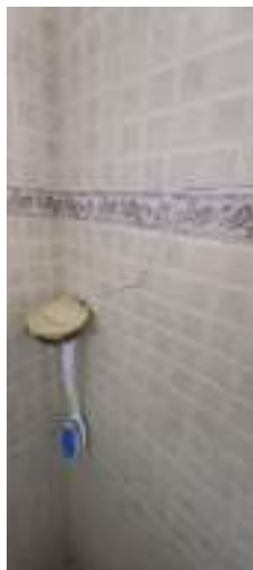
Peças trincadas no banheiro da Suíte 01
