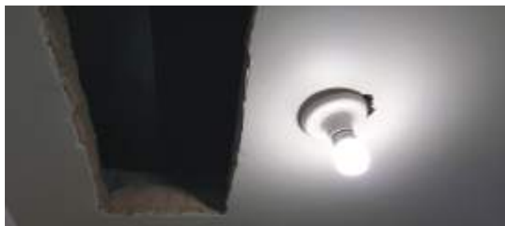
Buraco no teto do banheiro privativo da sala do Gerente
