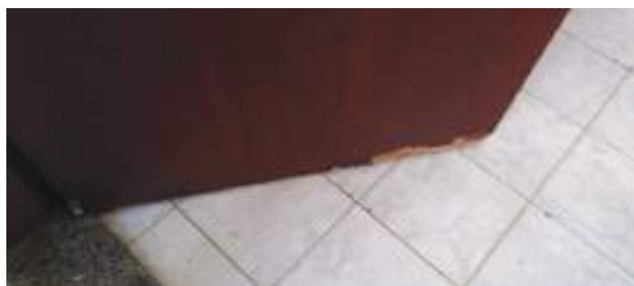
Defeito na porta do banheiro da área de serviço
