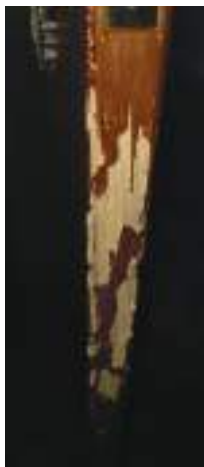
Defeitos na porta quarto 03
