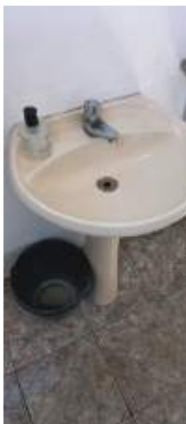
Lavatório do banheiro masculino
