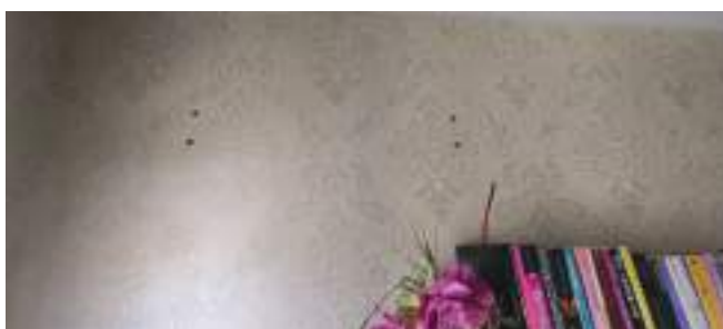
Furos na parede no quarto 02
