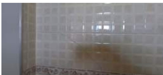
Peças trincadas no banheiro da Suíte 01
