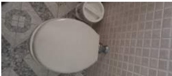
Vaso sanitário do banheiro do quarto 04
