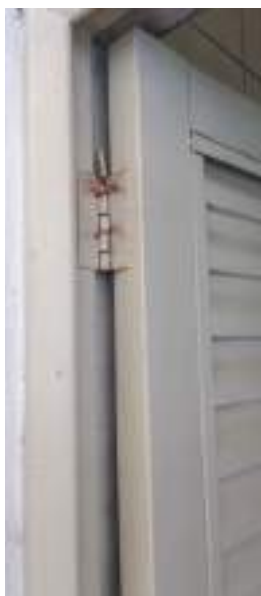
Dobradiças da porta do banheiro masculino
