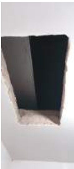
Buraco no teto do banheiro privativo da sala do Gerente
