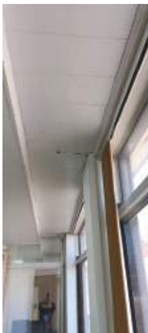
Infiltrações no teto da sala do Gerente
