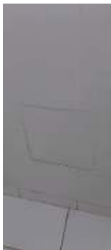
Peça com defeito no banheiro privativo da sala do Gerente
