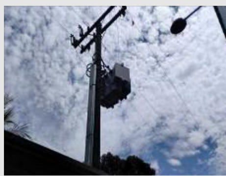
TRANSFORMADOR A ÓLEO POT 125 KVA | Item: 942 |
