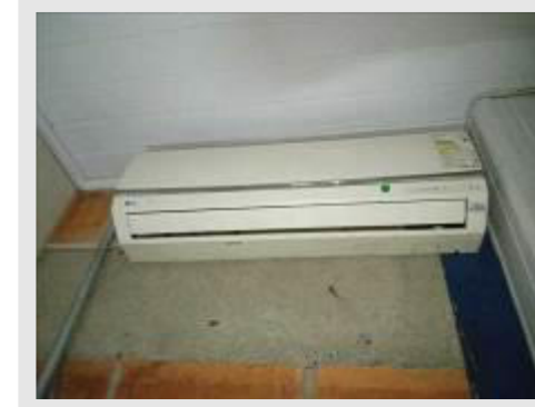
APARELHO CONDICIONADOR DE AR MARCA LG POT 9000 BTU TENSÃO 220 V | Item: 208 |
