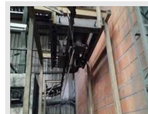
CABINE DE PINTURA A PÓ MARCA DELTEC COM SISTEMA DE TRANSPORTE AÉREO POR CORRENTE POT 32KW PROJETO 1718-021 E PAINEL TECNOAVANCE ANO 2006 | Item: 357 |
