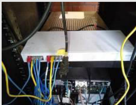
SWITCH MARCA 3COM C/ 16 PORTAS | Item: 793 |
