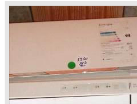
APARELHO CONDICIONADOR DE AR MARCA LG MOD YSNC1825MA1 POT 18000 BTU TENSÃO 220 V | Item: 772 |
