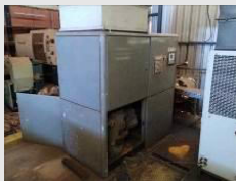
COMPRESSOR DE AR MARCA ATLAS COPCO MOD GA45FF 60CV NS 451486 ANO 2003 | Item: 45 |
