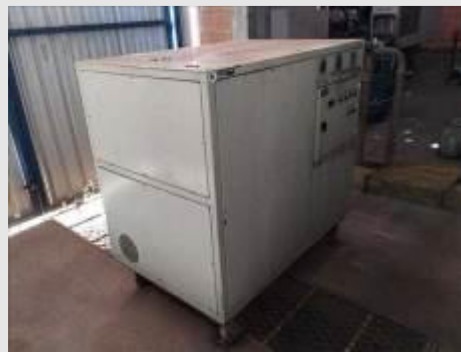
UNIDADE DE AGUA GELADA MARCA REFRIAC MOD RAI050-SCW CAP 15.000 KCAL/H NS 2142 ANO 2000 | Item: 48 |
