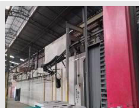
CABINE DE PINTURA A PÓ MARCA DELTEC COM SISTEMA DE TRANSPORTE AÉREO POR CORRENTE POT 32KW PROJETO 1718-021 E PAINEL TECNOAVANCE ANO 2006 | Item: 357 |
