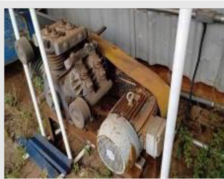
COMPRESSOR DE AR DIRETO COM MOTOR DE 25 CV | Item: 909 |
