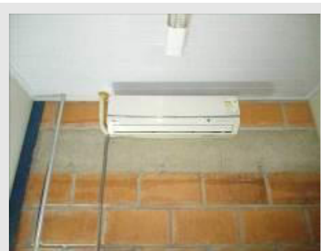
APARELHO CONDICIONADOR DE AR MARCA LG MOD TSNC092YMA1 POT 9000 BTU TENSÃO 220 V | Item: 162 |
