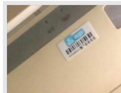
APARELHO CONDICIONADOR DE AR MARCA SPRINGER POT 30000 BTU TENSÃO 220 V | Item: 731 |
