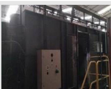
CABINE DE PINTURA A PÓ MARCA DELTEC COM SISTEMA DE TRANSPORTE AÉREO POR CORRENTE POT 32KW PROJETO 1718-021 E PAINEL TECNOAVANCE ANO 2006 | Item: 357 |
