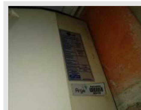
APARELHO CONDICIONADOR DE AR MARCA LG MOD TSNC092YMA1 POT 9000 BTU TENSÃO 220 V | Item: 163 |
