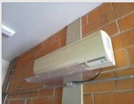
APARELHO CONDICIONADOR DE AR MARCA SPRINGER MOD 42MCB30515LS POT 30000 BTU TENSÃO 220 V | Item: 674 |
