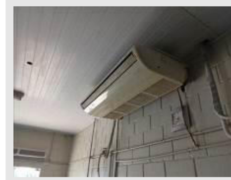
APARELHO CONDICIONADOR DE AR MARCA ELGIN MOD PHFI 60000 2 POT 60000 BTU TENSÃO 220 V | Item: 88 |
