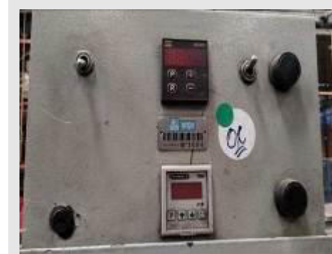
PRENSA PNEUMÁTICA PARA MONTAGEM DE COMPONENTE (CAMPANA SELANTE) | Item: 471 |
