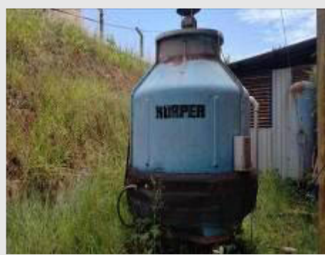
TORRE DE RESFRIAMENTO MARCA KORPER DE SISTEMA ABERTO COM 2 BOMBAS KSB COM MOTOR DE 15 CV | Item: 938 |
