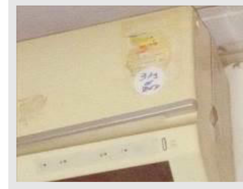
APARELHO CONDICIONADOR DE AR MARCA LG POT 24000 BTU | Item: 402 |
