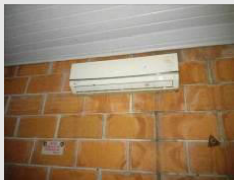
APARELHO CONDICIONADOR DE AR MARCA LG MOD TSNH122YMA0 POT 12000 BTU TENSÃO 220 V | Item: 595 |
