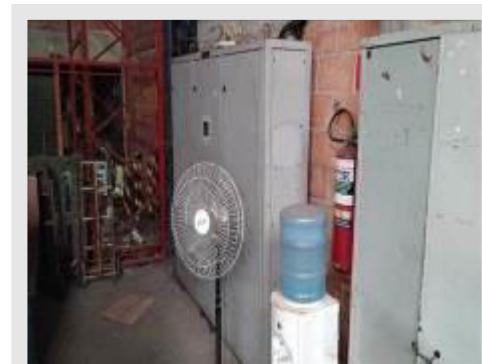
BANCO DE CAPACITOR DIM 2.20X 2.00X0.40 M | Item: 853 |
