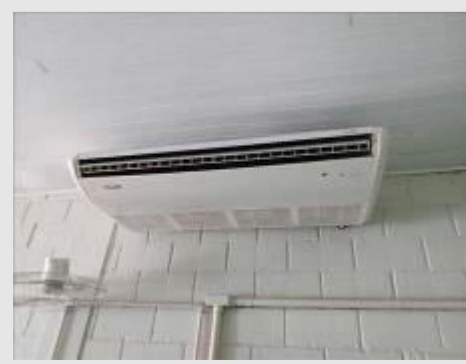
APARELHO CONDICIONADOR DE AR MARCA ELGIN MOD PHFI 60000 2 POT 60000 BTU TENSÃO 220 V | Item: 92 |
