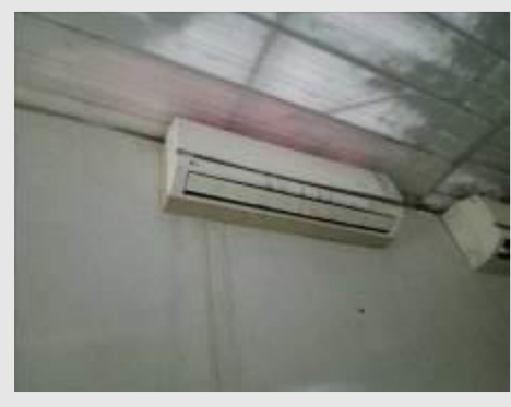
APARELHO CONDICIONADOR DE AR MARCA LG MOD TSNC122YMA1 POT 12000 BTU TENSÃO 220 V | Item: 401 |
