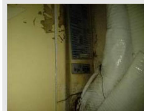
APARELHO CONDICIONADOR DE AR MARCA ELETROLUX MOD SI30F POT 30000 BTU TENSÃO 220 V | Item: 197 |
