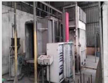
CABINE DE PINTURA A PÓ MARCA DELTEC COM SISTEMA DE TRANSPORTE AÉREO POR CORRENTE POT 32KW PROJETO 1718-021 E PAINEL TECNOAVANCE ANO 2006 | Item: 357 |
