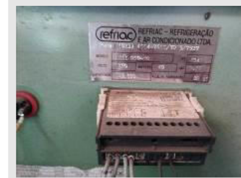
UNIDADE DE AGUA GELADA MARCA REFRIAC MOD RAI050-SCW CAP 15.000 KCAL/H NS 2142 ANO 2000 | Item: 48 |
