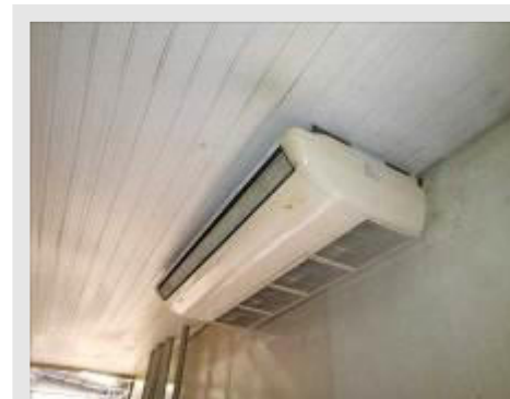
APARELHO CONDICIONADOR DE AR MARCA ELGIN MOD PHFI 60000 2 POT 60000 BTU TENSÃO 220 V | Item: 408 |
