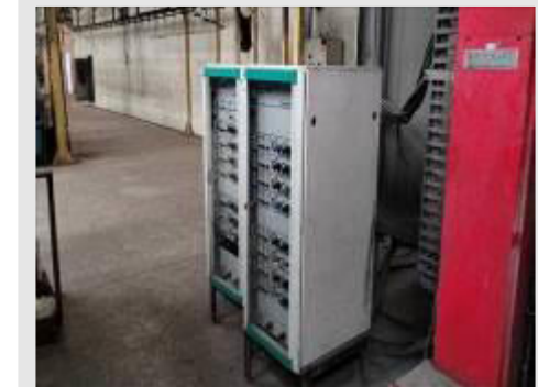
CABINE DE PINTURA A PÓ MARCA DELTEC COM SISTEMA DE TRANSPORTE AÉREO POR CORRENTE POT 32KW PROJETO 1718-021 E PAINEL TECNOAVANCE ANO 2006 | Item: 357 |
