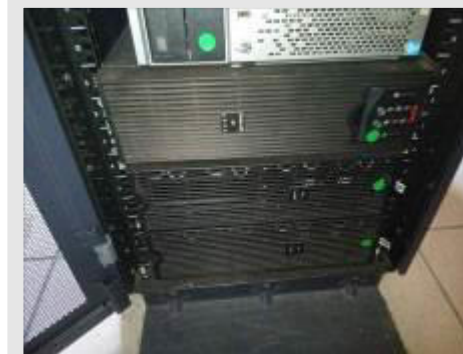
NOBREAK MARCA APC MOD SMART UPS RT 6000 | Item: 789 |
