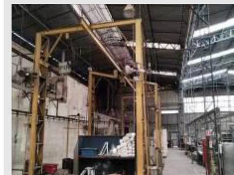
PONTE ROLANTE COM TALHA ELÉTRICA CAP 1T | Item: 362 |
