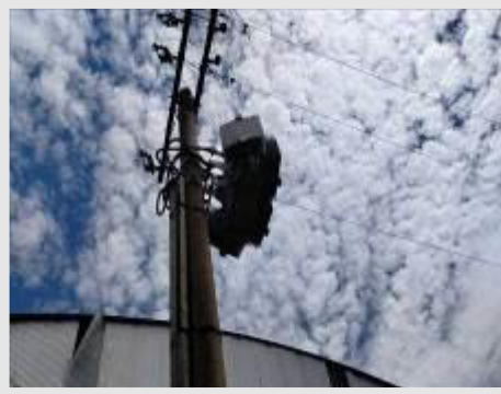
TRANSFORMADOR A ÓLEO 125 KVA | Item: 940 |
