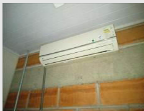
APARELHO CONDICIONADOR DE AR MARCA LG POT 9000 BTU TENSÃO 220 V | Item: 201 |
