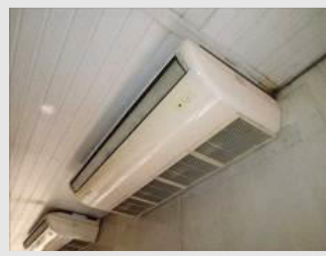
APARELHO CONDICIONADOR DE AR MARCA ELGIN MOD PHFI 60000 2 POT 60000 BTU TENSÃO 220 V | Item: 409 |
