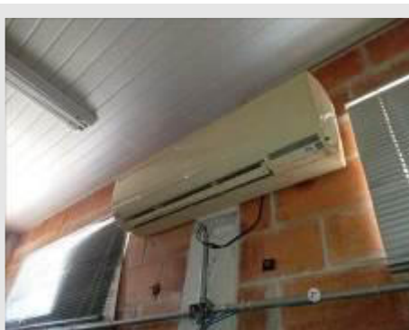
APARELHO CONDICIONADOR DE AR MARCA SPRINGER POT 30000 BTU TENSÃO 220 V | Item: 730 |
