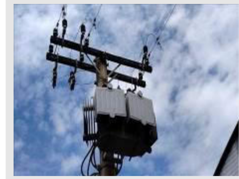
TRANSFORMADOR A ÓLEO POT 125 KVA | Item: 941 |
