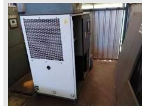
COMPRESSOR DE AR MARCA ATLAS COPCO MOD GA30FF NS 76971 ANO 2011 | Item: 46 |
