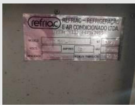
UNIDADE DE AGUA GELADA MARCA REFRIAC MOD RAI100-2HC CAP 30.000 KCAL/H NS 3161 ANO 2006 | Item: 47 |
