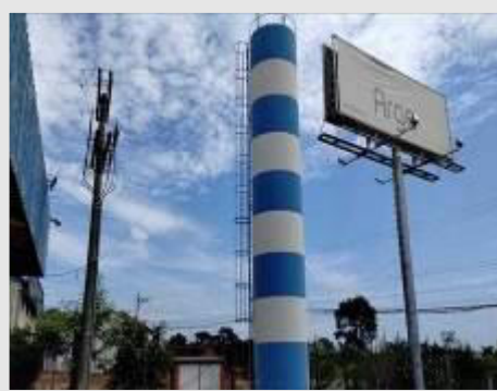
RESERVATÓRIO DE ÁGUA CAP 50.000 L | Item: 943 |
