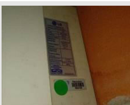
APARELHO CONDICIONADOR DE AR MARCA LG MOD TSNC092YMA1 POT 9000 BTU TENSÃO 220 V | Item: 162 |
