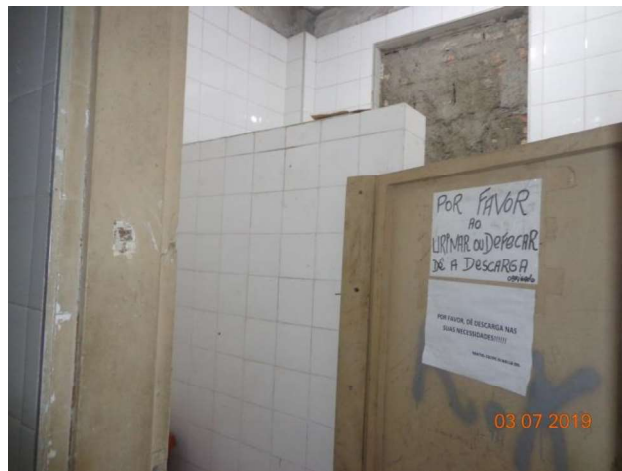
Vestiários feminino e masculino dos funcionários, com umidade nos tetos, pisos desgastados e, sem ventilação.
