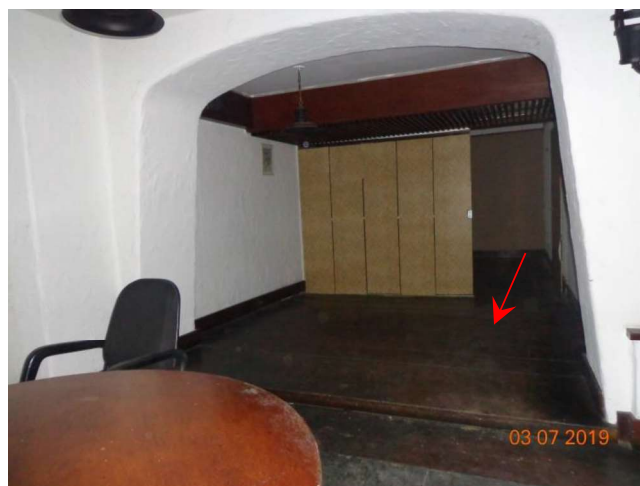
Vista da sala de espera p/ o salão de conferências. Piso de madeira desgastado.
