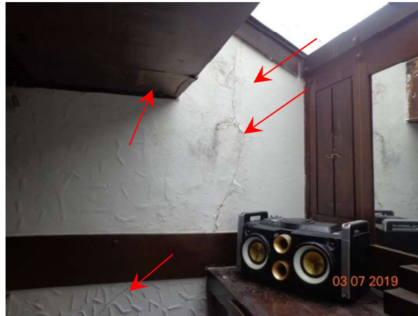
Vista do Bar – com umidade e fissuras e forro de madeira solto.
