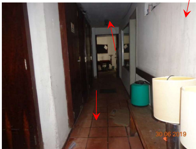
Vistas do corredor de circulação da área de apoio. Com umidade nos tetos, paredes, piso desgastado, esquadrias podres.
