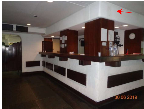
Vista da recepção com mancha de umidade.
