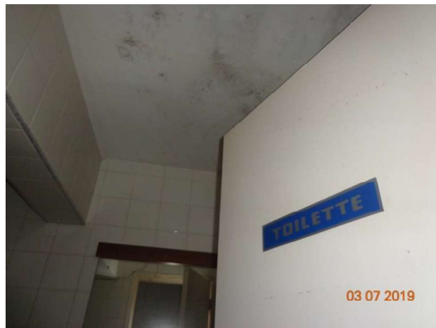
Banheiro ao lado da lavanderia com umidade no teto.
